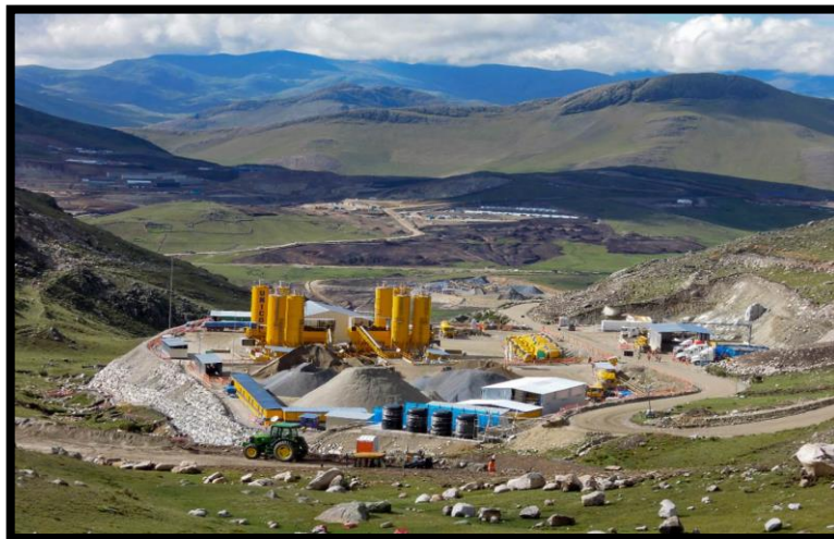
Imagen 16 Planta de Concreto - Unicon
