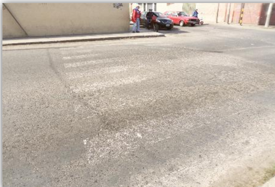
ESQUINA DE AV. JORGE BASADRE G. CON AV. GREGORIO ALBARRACIN SE OBSERVA LA SEÑALIZACION HORIZONTAL DEFICIENTE, EN ESQUINA POSTERIOR
