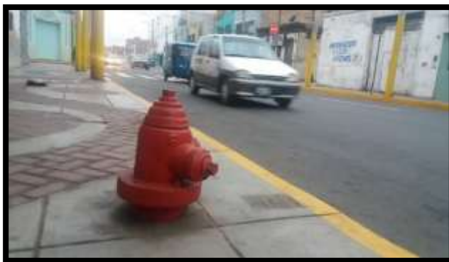
Ilustración 21 “Hidrante en vía pública”
