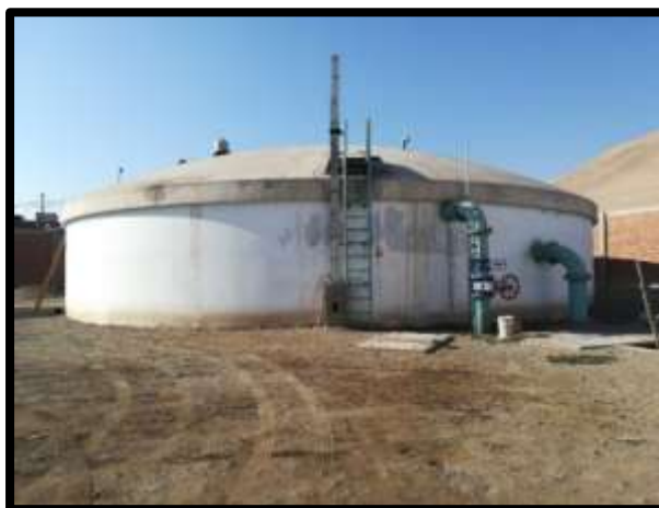
Ilustración 1 “Reservorio R-11 (vol.=1250 m3), inicio del modelamiento hidráulico”
