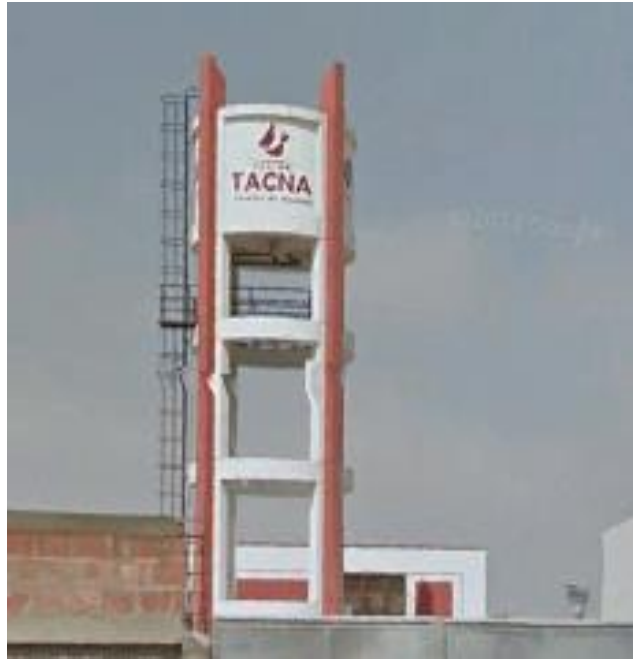
Figura 8. Reservorio elevado Instituto Superior Vigil Tacna
