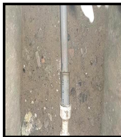
Fotografía 79: Micromedidor de la Mz. 100 – lote 13.
