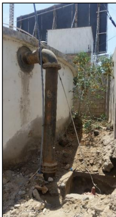
Fotografía 06: Tubería de del entrada al R5 desde el R9.
