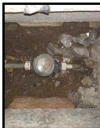
Fotografía 37: Micromedidor de la Mz. 79 – lote 7.
