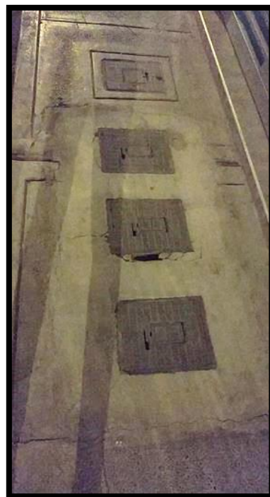
Fotografía 59: Micromedidor de la Mz. 80 – lote 4.
