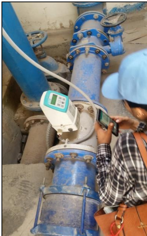
Fotografía 04: Macromedidor ubicado en el ingreso al R5 proveniente del R4.
