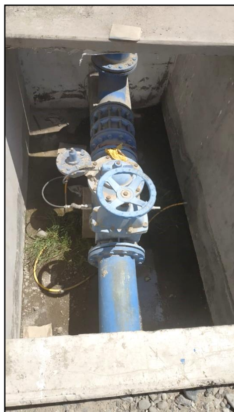
Fotografía 14: Tubería de ingreso 2 al R5A
