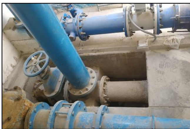
Fotografía 08: Detalle de la tubería de rebose.
