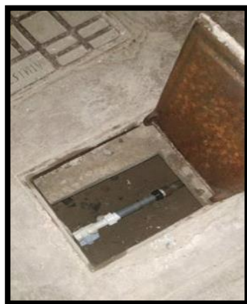
Fotografía 22: Micromedidor de la Mz. 42 – lote 4.
