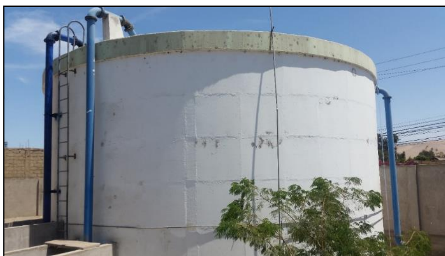
Fotografía 11: Vista principal del Reservorio R5A, coordenadas Este: 036681, Norte: 8007206 y Altura: 539m.s.n.m.
