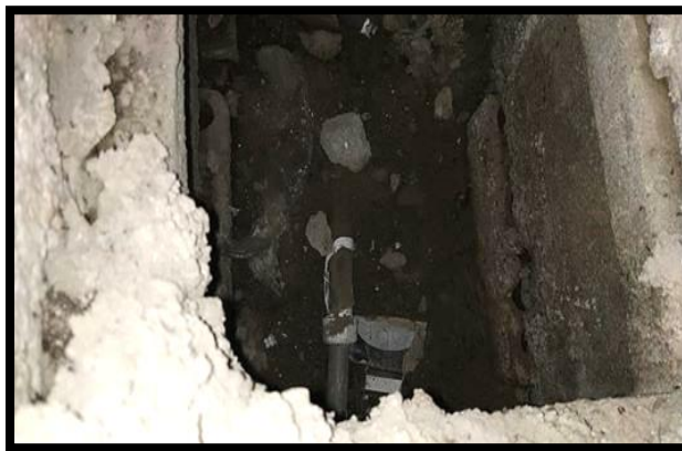
Fotografía 77: Micromedidor de la Mz. 97 – lote 11.
