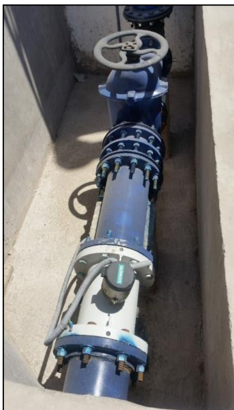
Fotografía 13: Tubería de ingreso 1 al R5A
