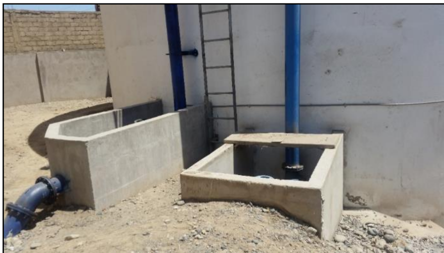
Fotografía 12: Vista de las tuberías de ingreso al reservorio R5A
