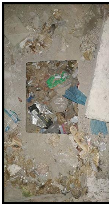
Fotografía 45: Micromedidor de la Mz. 83 – lote 4.
