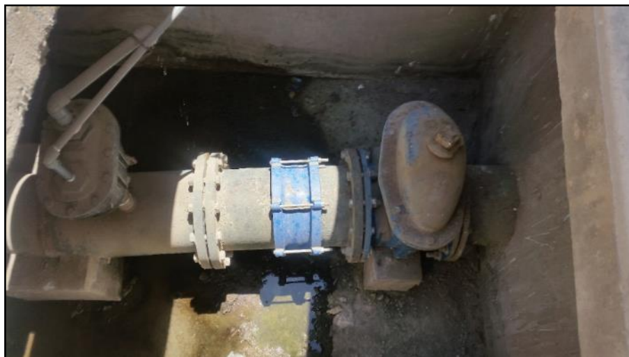
Fotografía 15: Tubería de salida del R5A al Subsector SS20.
