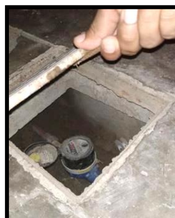
Fotografía 26: Micromedidor de la Mz. 41 – lote 11.
