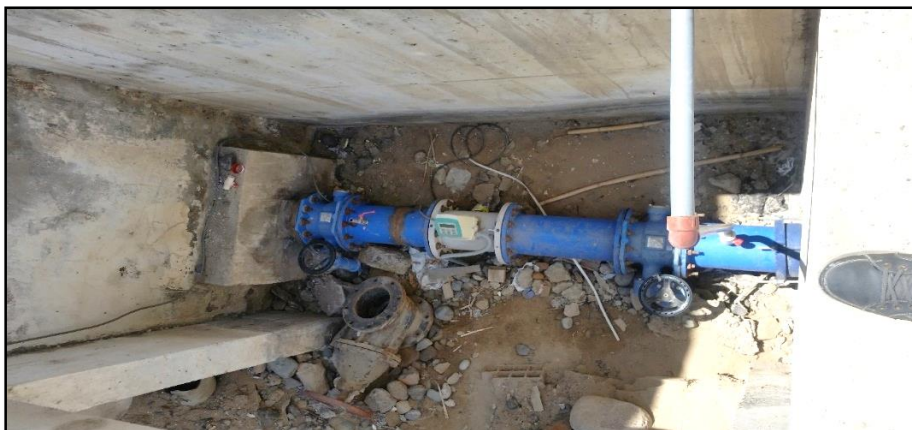
Fotografía 09: Tubería de salida del R5 al Subsector SS19, con su macromedidor.
