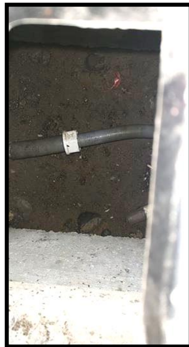
Fotografía 75: Micromedidor de la Mz. 97 – lote 14.
