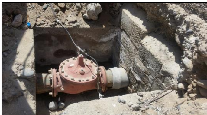
Fotografía 05: Tubería de ingreso al R5 proveniente R9
