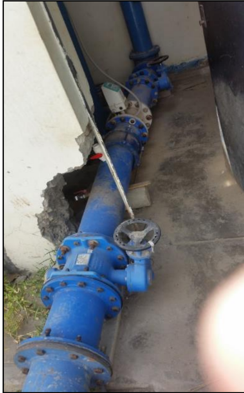
Fotografía 03: Tubería de ingreso al R5 proveniente del R4.
