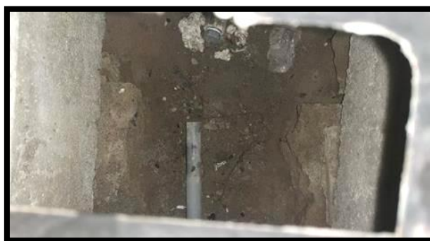
Fotografía 71: Micromedidor de la Mz. 97 – lote 2.
