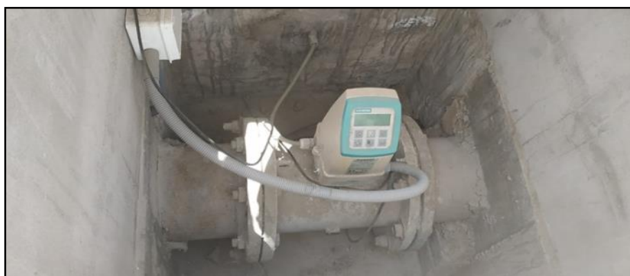
Fotografía 10: Tubería de salida del R5 al Subsector SS22, con su macromedidor.
