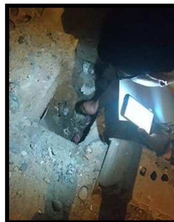
Fotografía 24: Micromedidor de la Mz. 42 – lote 23.
