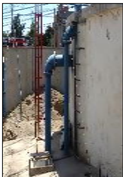
Fotografía 07: Tubería de rebose.
