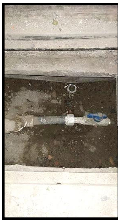
Fotografía 55: Micromedidor de la Mz. 82 – lote 5.
