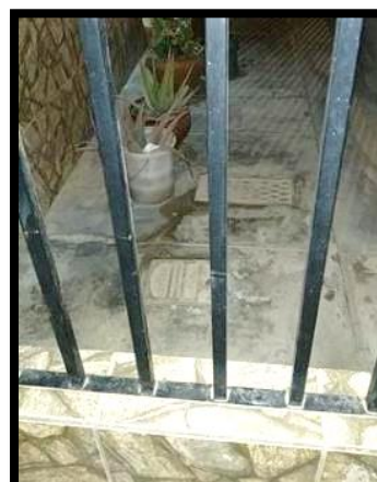
Fotografía 28: Micromedidor de la Mz. E – lote 10.
