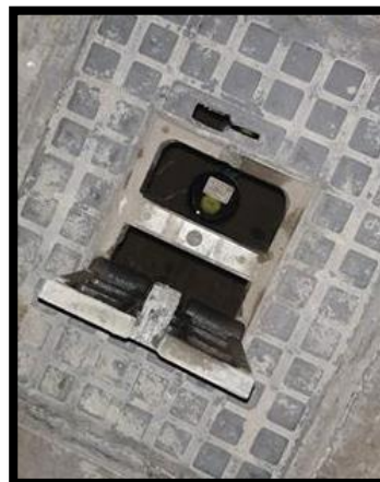
Fotografía 35: Micromedidor de la Mz. 81 – lote 12.
