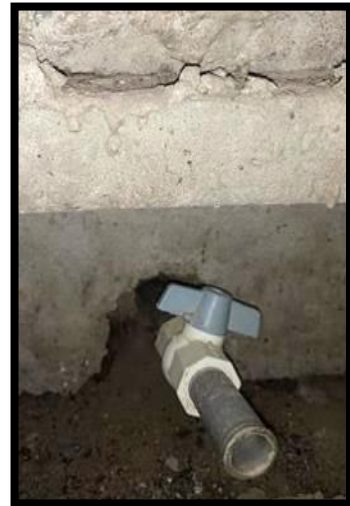
Fotografía 87: Micromedidor de la Mz. 100 – lote 10.
