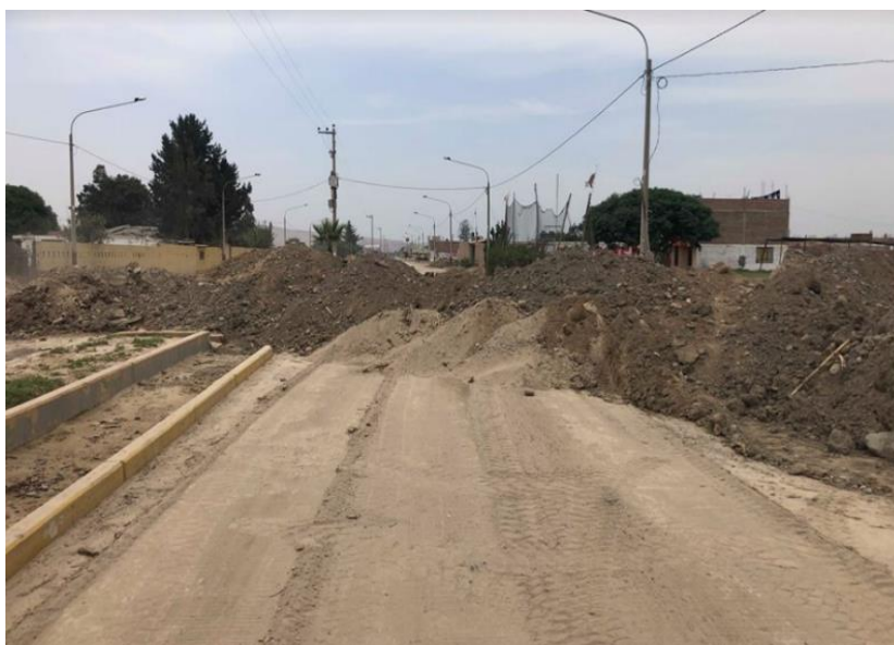
Fotografía 4 : Obstrucción de la avenida Celestino Vargas km 40.
