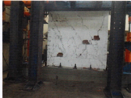
Foto 91. Desprendimiento de ladrillos en la parte superior Este e inferior Oeste de la cara Sur para una distorsión de 1/200.
