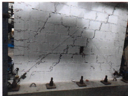
Foto 18. Desprendimiento de la parte izquierda del ladrillo mencionado en la foto anterior para una distorsión de 1/300.
