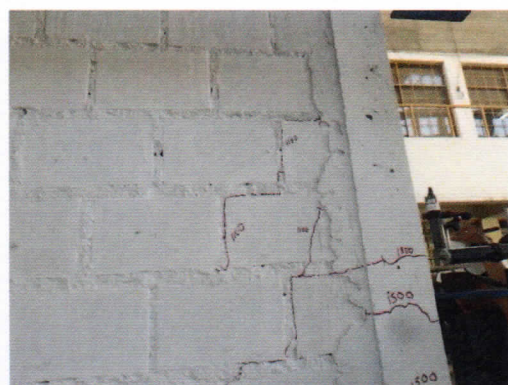
Foto 106. Continuación de grietas en el mortero y en las columnas de la cara Norte y Sur para una distorsión 1/1100.
