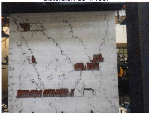
Foto 100. Desprendimiento de ladrillo en la parte superior Oeste de la cara Sur para una distorsión de 1/150.
