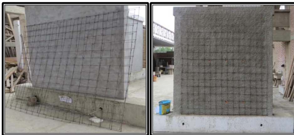
Fig. 5-5. Mallas de Refuerzo (izq.) y Malla de Refuerzo Colocada en el Muro Fuente: (SENCICO, 2016)
