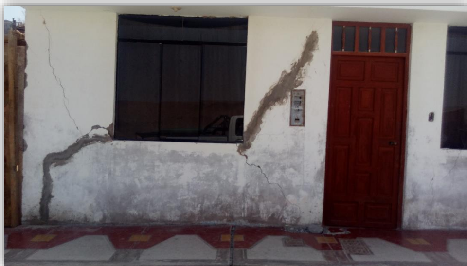
Figura 3. Fisuras en viviendas III de Alto Locumba
