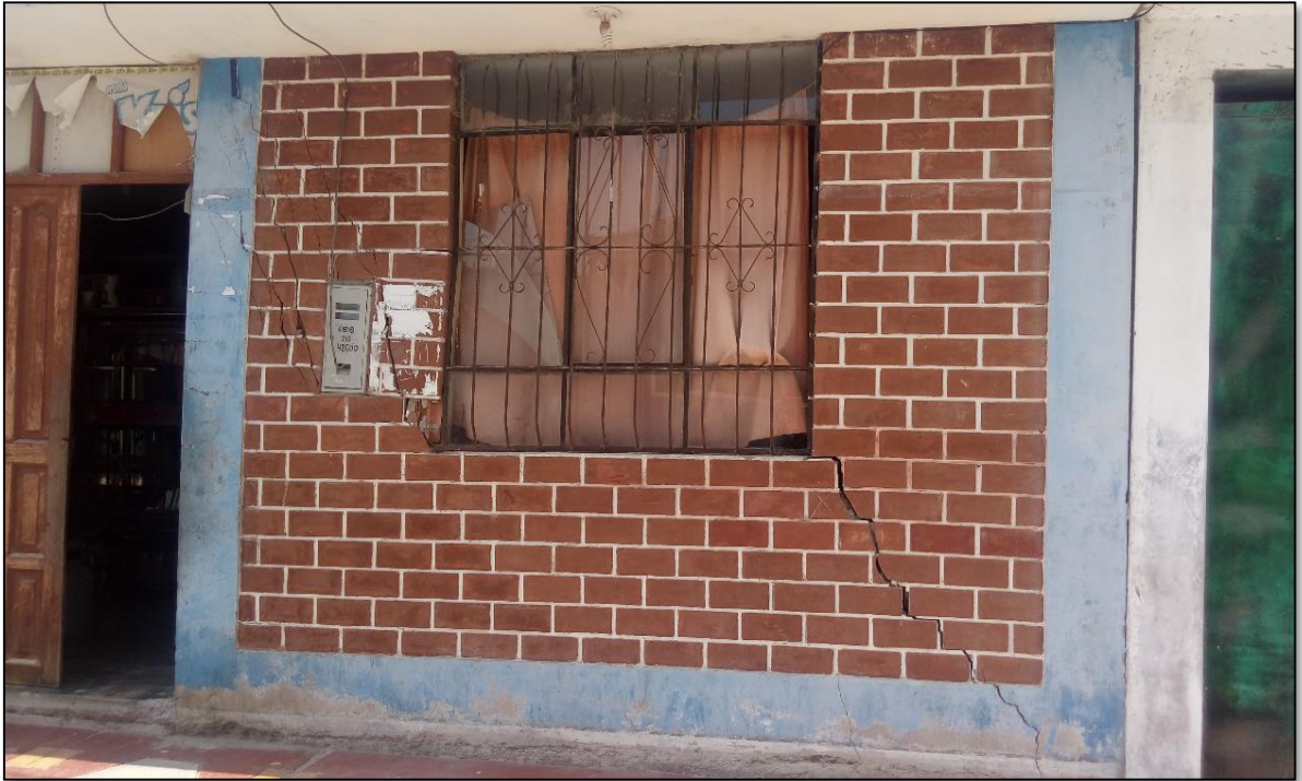
Fotografía 11. Fisuras de la Vivienda 2 de Alto Locumba
