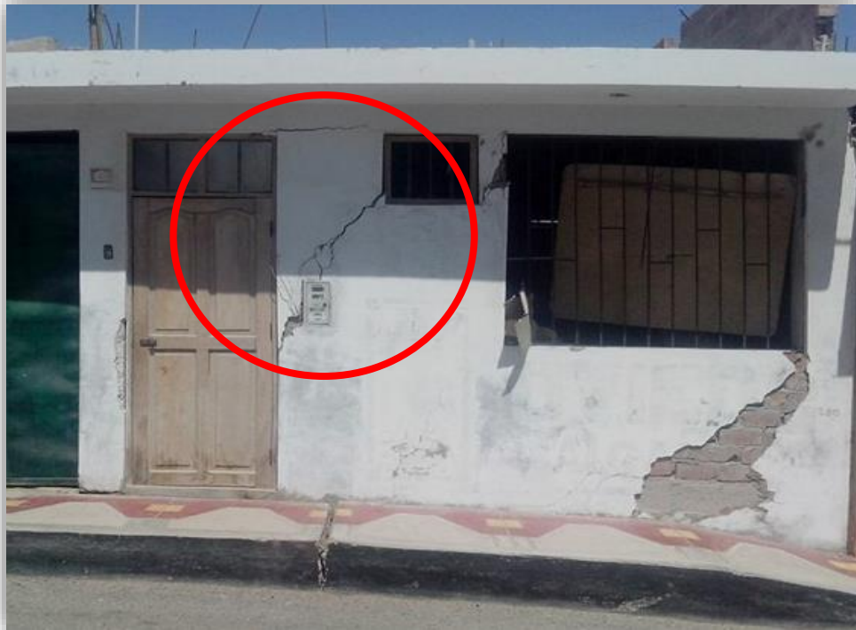
Figura 1. Fisuras en Viviendas I de Alto Locumba
