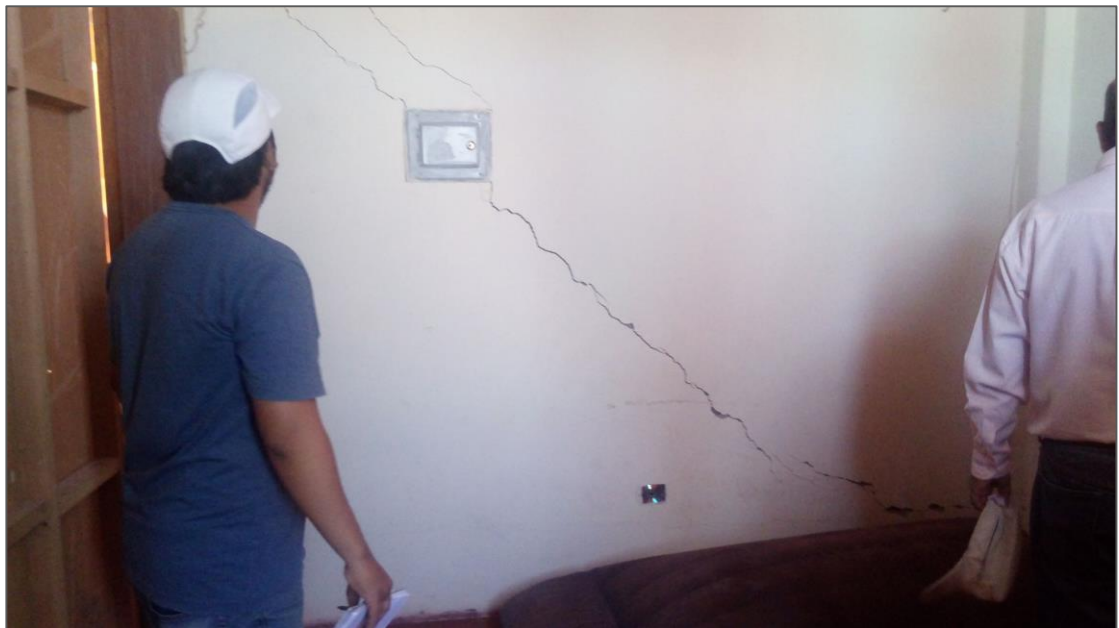
Fotografía 10. Fisuras de la Vivienda 1 de Alto Locumba
