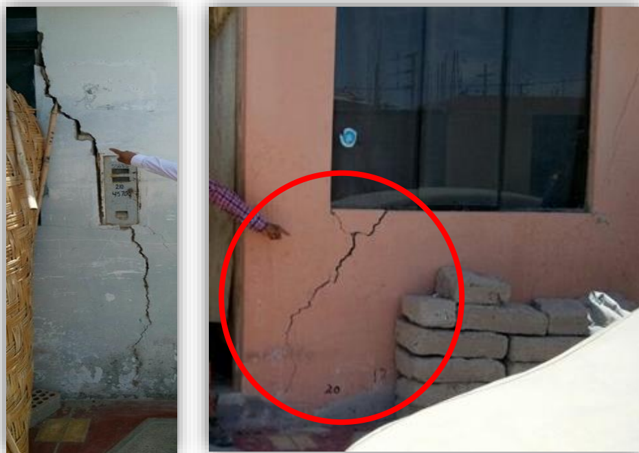
Figura 2. Fisuras en viviendas II de Alto Locumba
