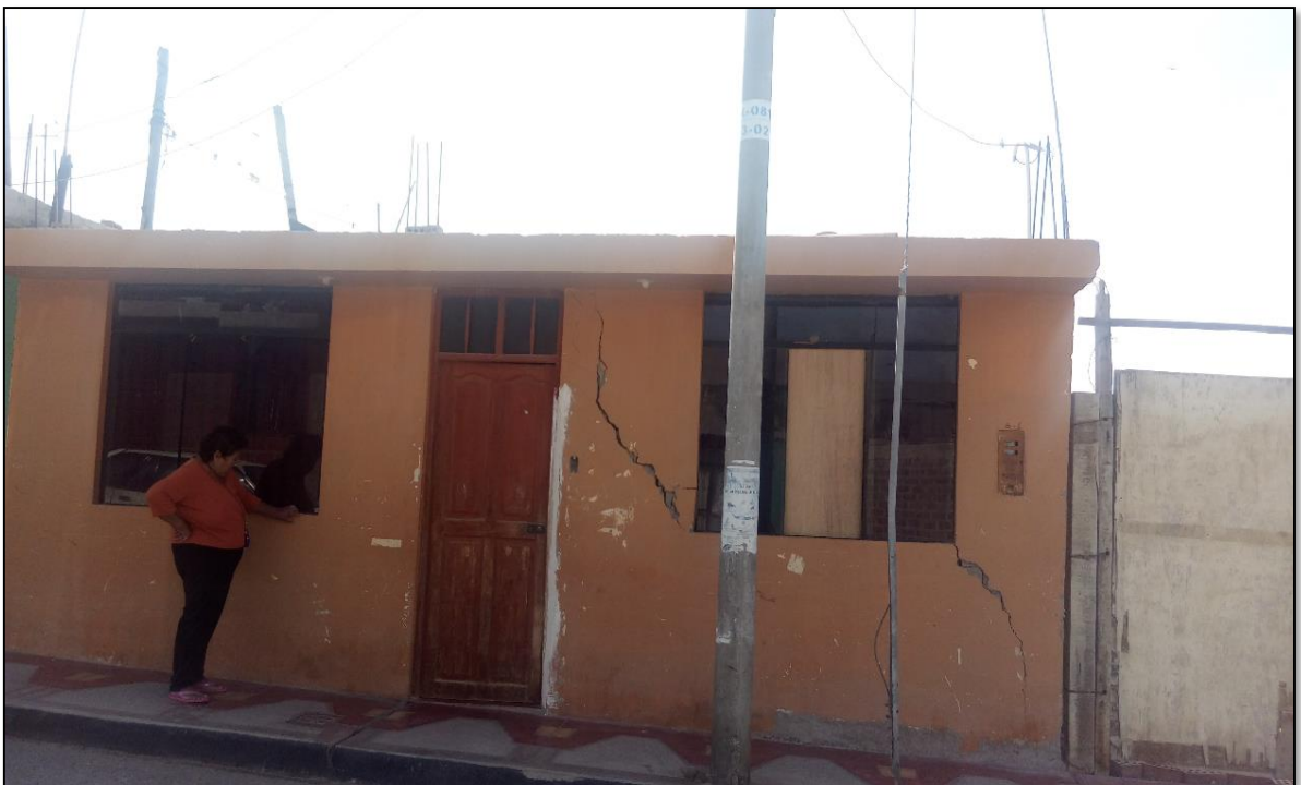
Fotografía 12. Fisuras de la Vivienda 3 de Alto Locumba
