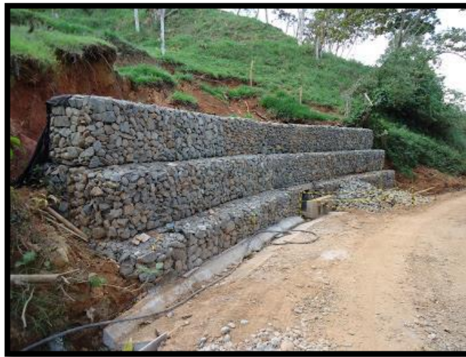
Figura N° 15: Muros de contención de gaviones utilizados frente a derrumbes de suelo residual.
