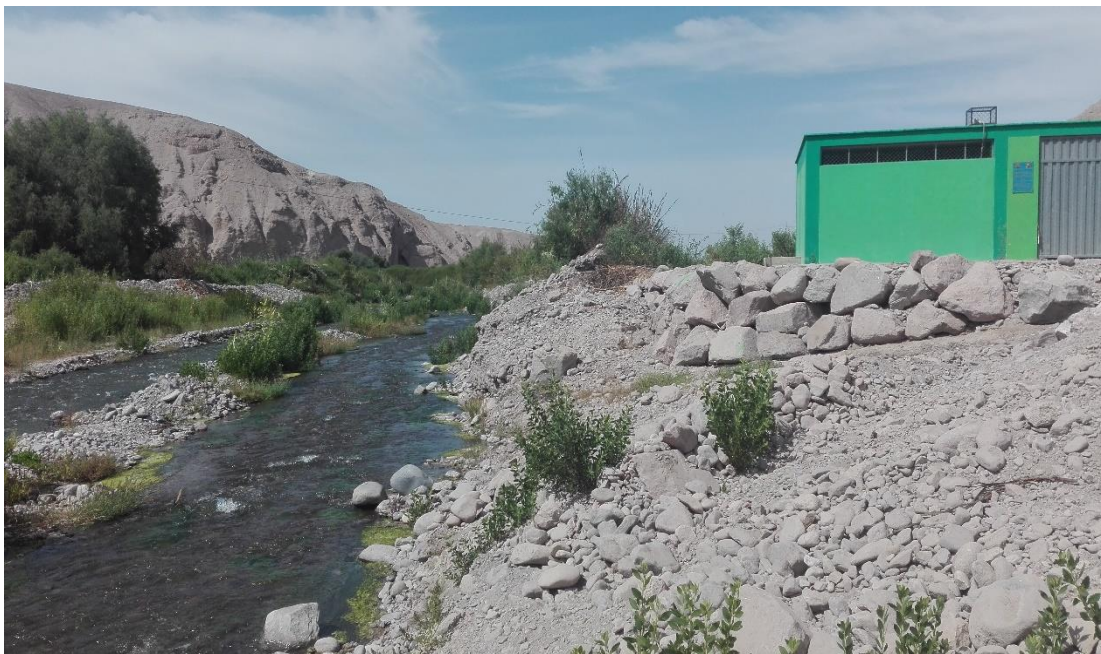
FOTO N° 02: SE OBSERVA LA AUSENCIA DE PROTECCION CON MUROS DE CONTENCIÓN EN LA ORILLA DEL RIO PROGRESIVA 6+080 DEL TRAMO CP.MIRAVE- OCONCHAY.
