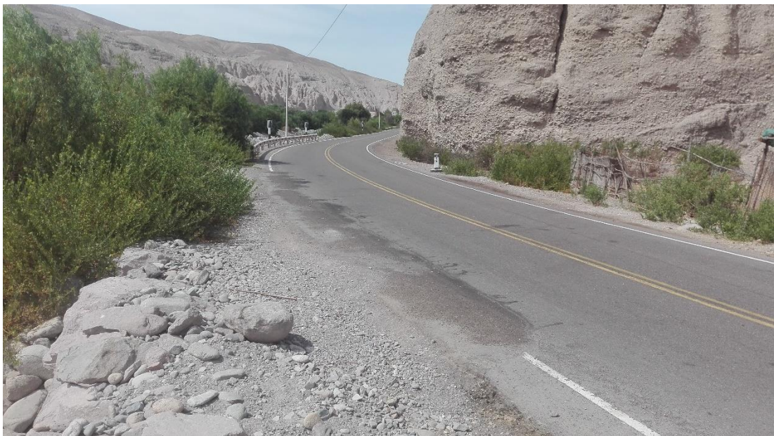
FOTO N° 06: SE OBSERVA LA ZONA RESTAURADA DAÑADA POR LAS VENIDAS DEL RIO LOCUMBA, CORRESPONDIENTE A LA ZONA 2 DEL PROYECTO PROGRESIVA 6+840 DEL TRAMO CP.MIRAVE- OCONCHAY.
