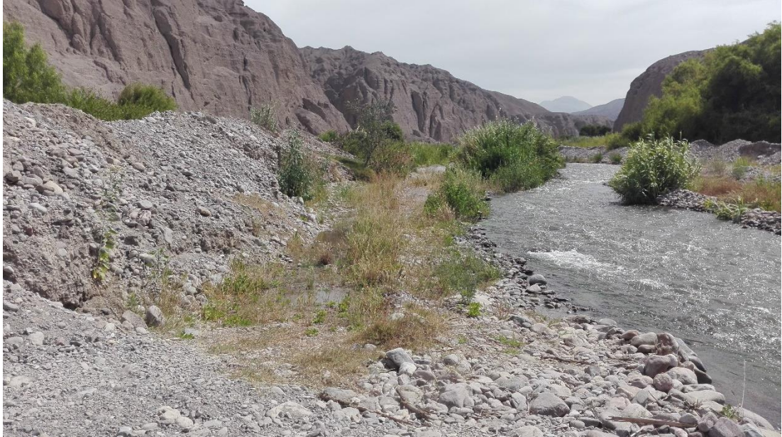
FOTO N°07: SE OBSERVA EL TALUD AFECTADO POR LA EROSION DEL RIO LOCUMBA PROGRESIVA 6+840 DEL TRAMO CP.MIRAVE- OCONCHAY.
