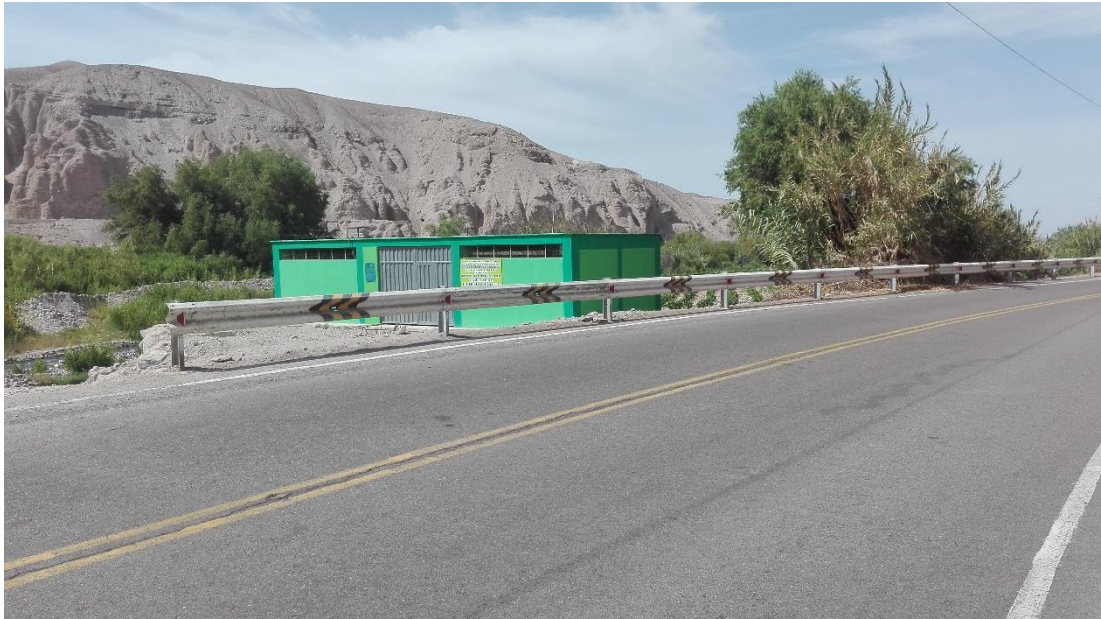
FOTO N° 01: SE OBSERVA EL TRAMO DE LA PROPUESTA DEL MURO DE GAVIONES ZONA 1 DEL PROYECTO DEL RIO LOCUMBA PROGRESIVA 6+080 DEL TRAMO CP. MIRAVE – OCONCHAY.
