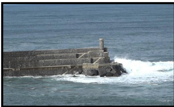
Figura N° 17: Muros de gaviones utilizados como rompeolas. Fuente: Dique rompeolas de Punta Barrakomuturra. Ondarroa – España.
