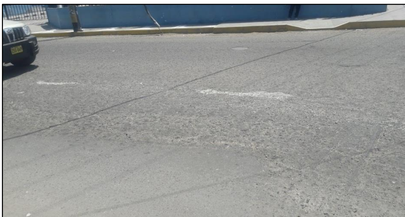
Foto 07: Se puede ver que el pavimento presenta algunos baches a lo largo de la vía y que el camino urbano en mención no cuenta con señalización horizontal (Acceso NO).
