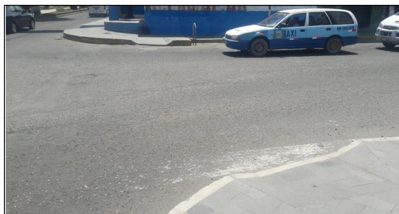
Foto 09: Se puede observar la señalización horizontal en malas condiciones (paso peatonal) por falta de mantenimiento y por el paso de vehículos pesados.
