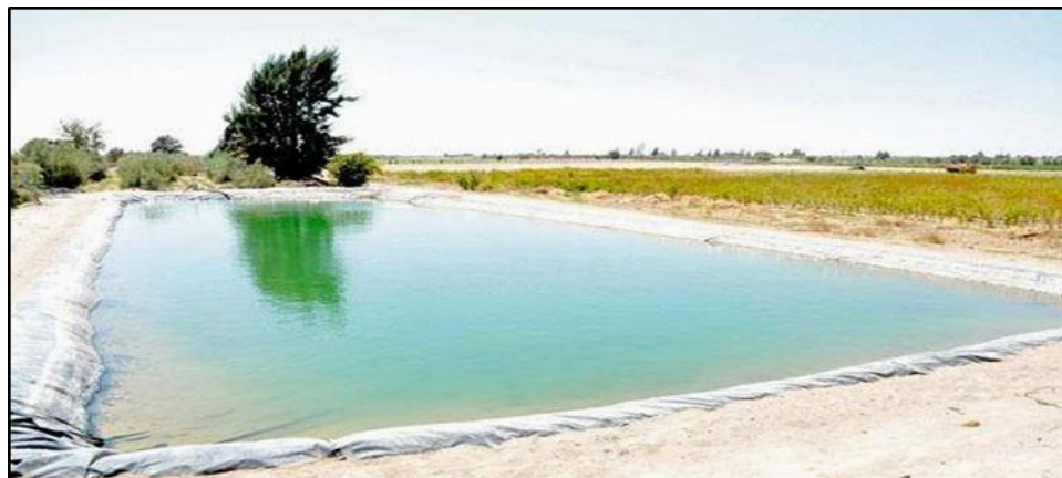
Figura 110: Reservorios de aguas residuales
