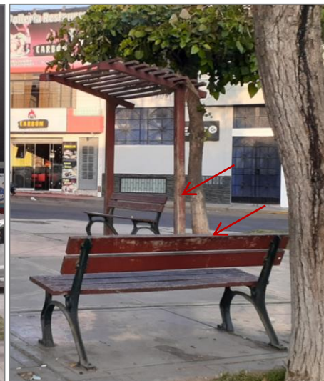
IMAGEN 02: Estado de pérgola y banca
