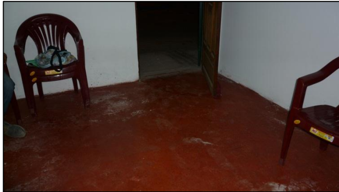
Figura 77. Piso con eflorescencia, otra vista.
