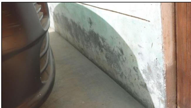
Figura 53. Muro de la cochera con eflorescencia.
