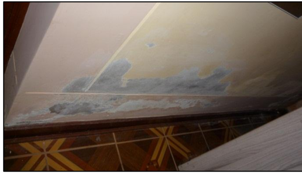
Figura 54. Muro con mancha con formas circulares en dormitorio
