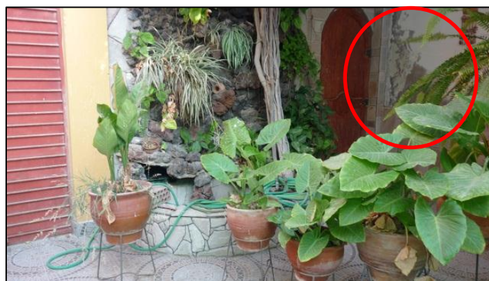
Figura 47. Interior de la vivienda con mancha de humedad.
