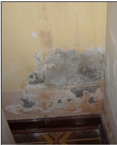
Figura 55. Muro con mancha circular intensa en dormitorio.
