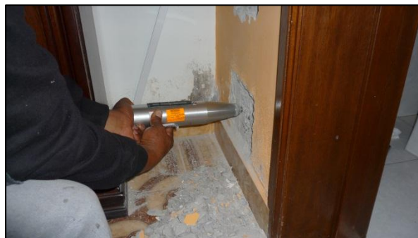
Figura 68. Ensayo de esclerometría de zona afectada
