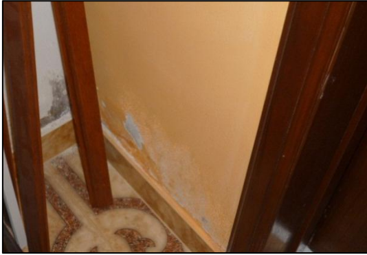
Figura 58. Columna afectada por la humedad.
