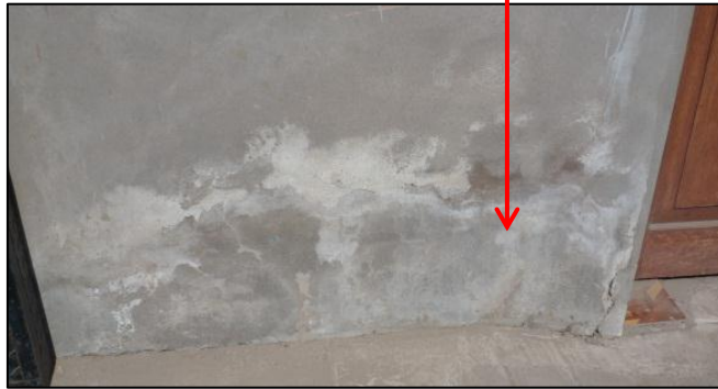
Figura 52. Vista aumentada de la mancha de 0.54m máximo de altura.
