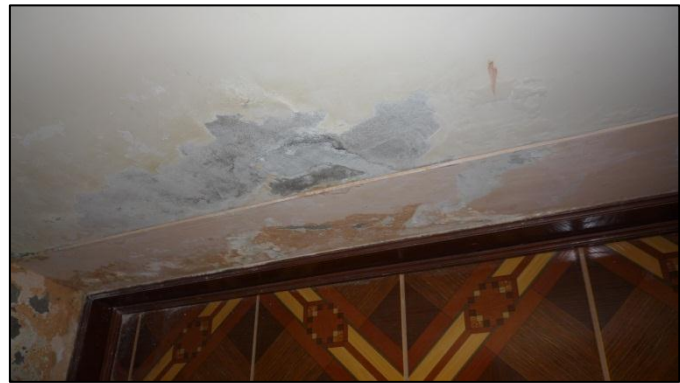
Figura 56. Muro con mancha circular en dormitorio.
