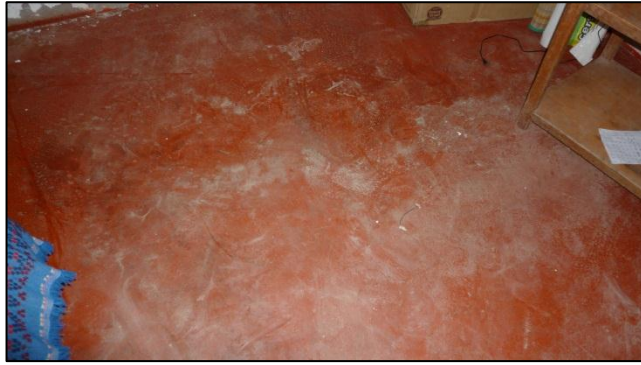
Figura 76. Piso con eflorescencia.
