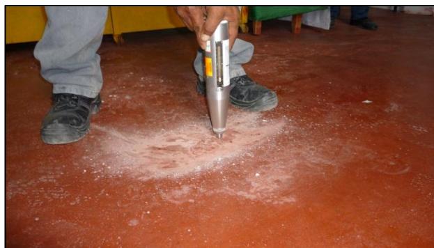
Figura 82. Ensayo de esclerometría de zona afectada del piso.
