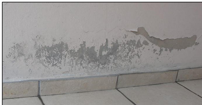
Figura 6. Vivienda con eflorescencia
