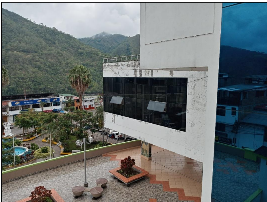
Fotografía 11: Vista de la terraza y volado del tercer piso del Palacio Municipal
