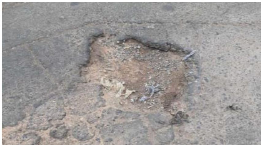
Falla de pavimentos por Huecos
