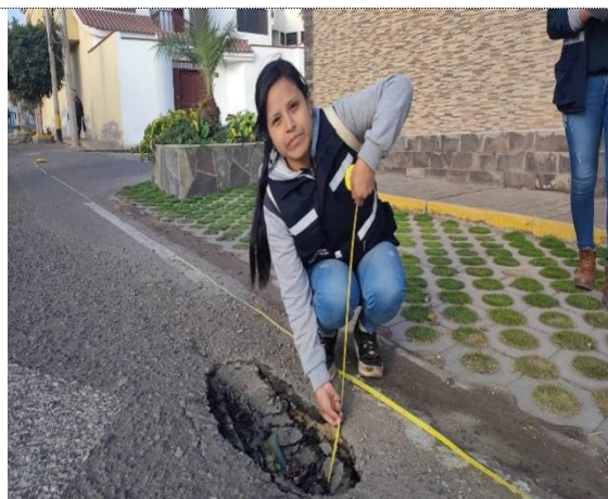
Fotografía N°03. Hueco Progresiva Km 0+222,84 - 0+259,98
