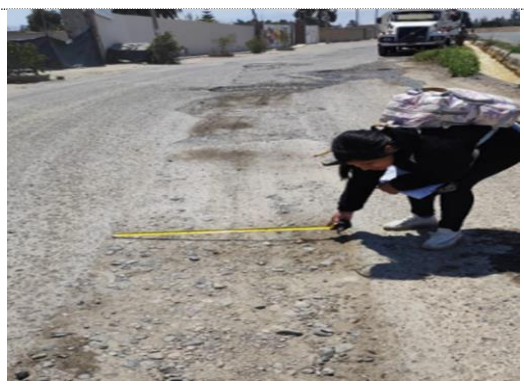
Fotografía N°26. Parcheo con una severidad alta
