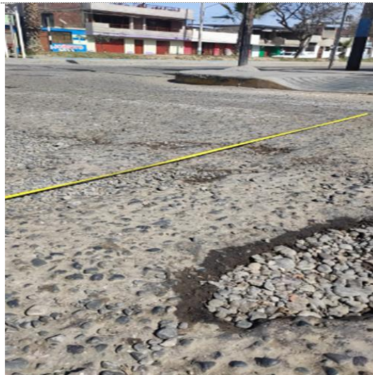
Fotografía N°22. Perdida de agregados y ojo de pescado con una severidad media
