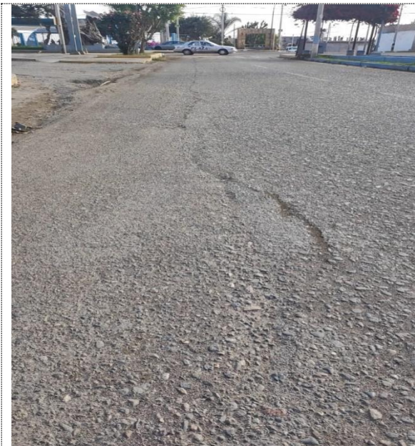
Fotografía N°01. Grieta Transversal Progresiva Km 0+000 - 0+037,14
