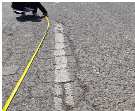
Fotografía N°24. Fisuras longitudinales con una severidad media
