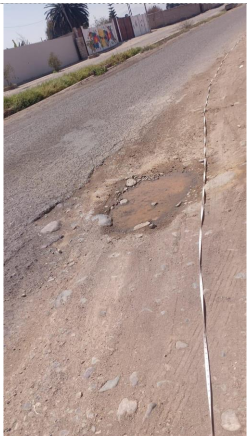
Fotografía N°08. Desprendimiento de agregados Progresiva Km 0+779,94- 0+817,08
