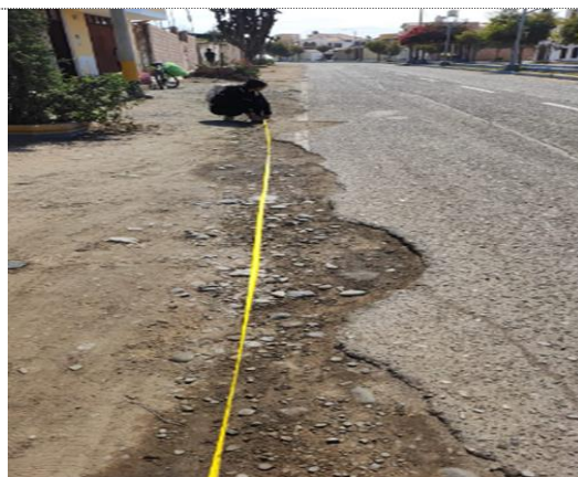
Fotografía N°23. Desintegración de los bordes con una severidad media
