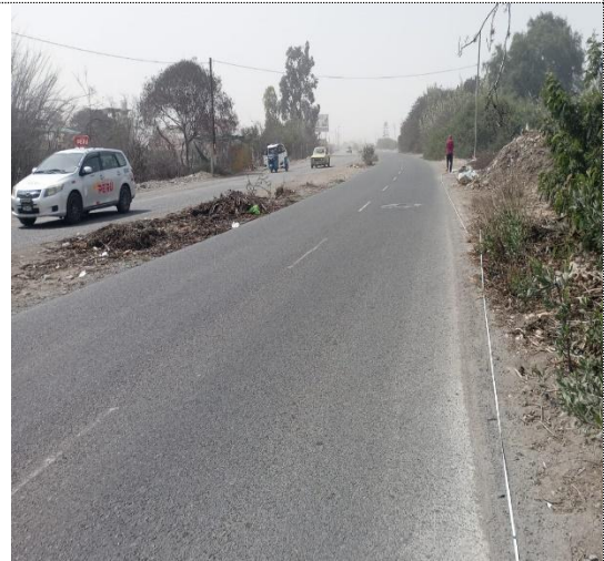
Fotografía N°18. Desprendimiento de agregados Progresiva Km 2+265,54-2+302,68
