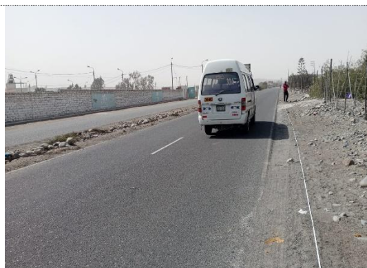
Fotografía N°19. Desprendimiento de agregados Progresiva Km 2+451,24-2+488,38
