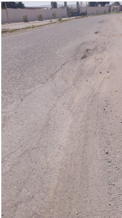
Fotografía N°07. Depresión Progresiva Km 0+705,66 -0+742,80
