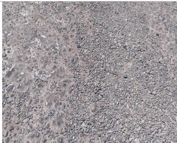
Fotografía N°05. Meteorización / Desprendimiento de agregados Progresiva 0+445,68 - 0+482,82
