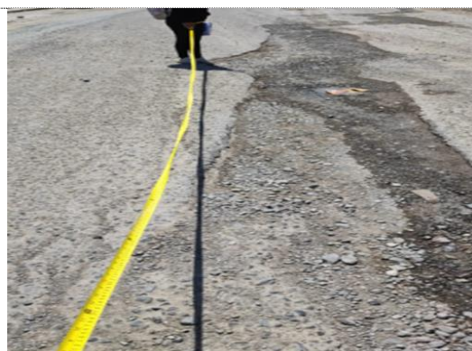
Fotografía N°25. Parcheo con una severidad alta,
