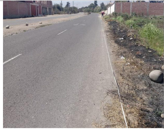
Fotografía N°16. Desprendimiento de agregados Progresiva Km 2+042,70-2+079,84
