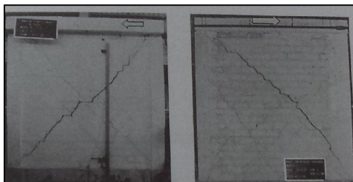
Figura 12. Límite de reparación.
