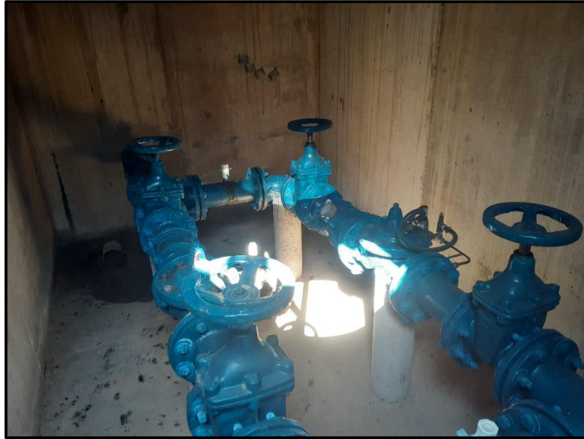
Fotografía N° 5: Válvula Reguladora de Presión en Zona Baja
