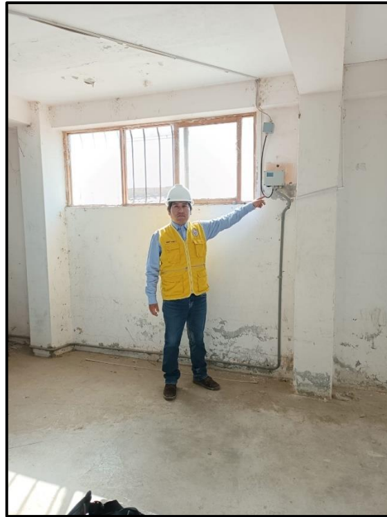
Fotografía N° 3: Macromedidor del Reservorio R-9
