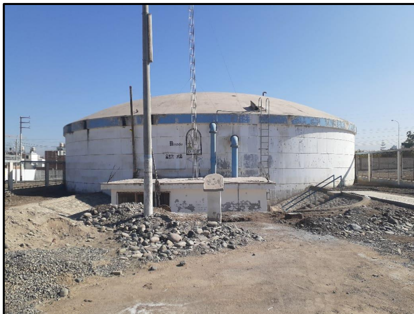
Fotografía N° 1 Reservorio R-9 ubicado en la vía Collpa, en frente del Cuartel Tarapacá
