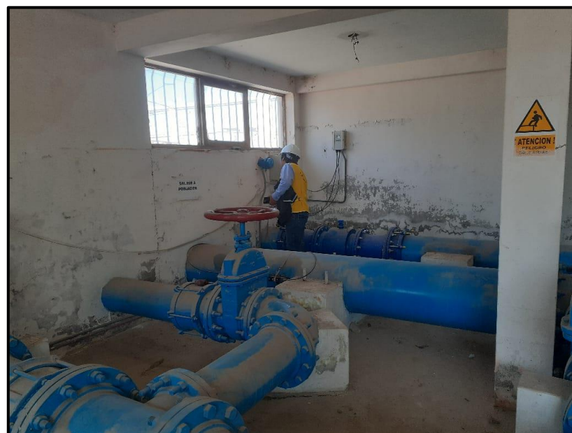
Fotografía N° 4: Circuito de Operación
