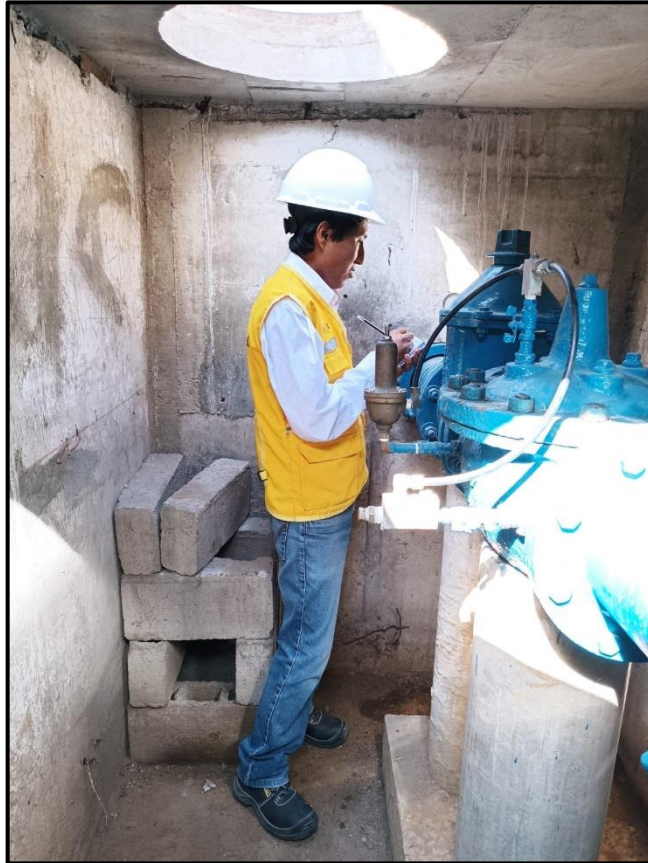
Fotografía N° 7: Válvula Reguladora de Presión en Zona Media
