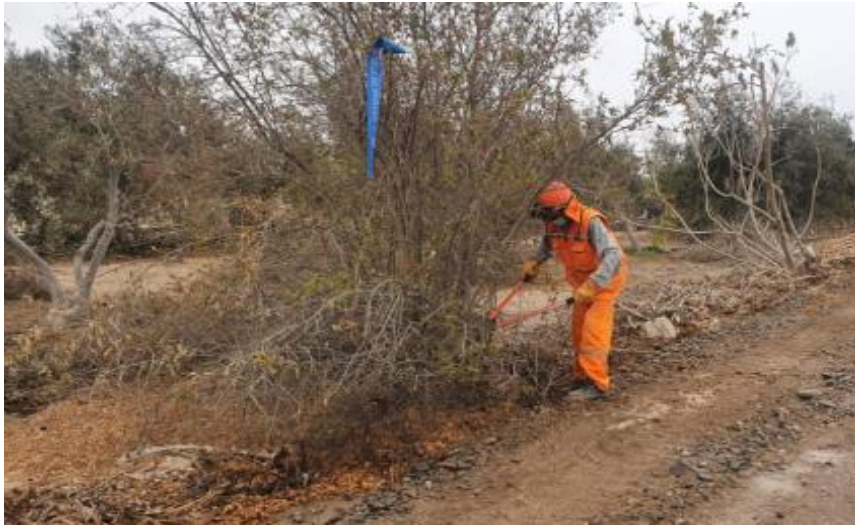
FOTO N° 5: CORTE Y DESBROCE DE VEGETACION CON MATERIALES MANUALES EN ZONA DE BERMA
