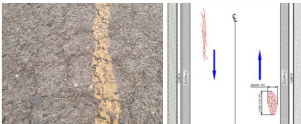
Grieta Piel de cocodrilo
