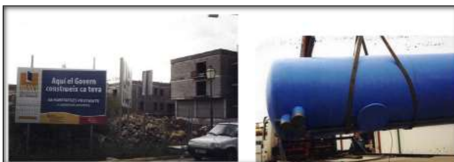
FIGURA N° 08: Comunidad de viviendas en Artá, dónde se instaló el sistema de reutilización (Foto: Eco agua)
