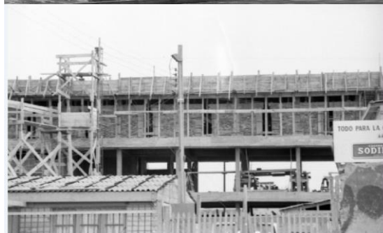
Figura 339: Foto fachada Sur y obra en construcción Nota: Archivo personal Balby Moran.
