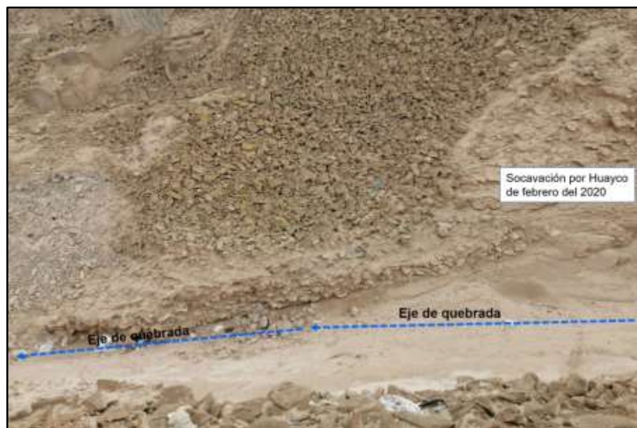
Figura 36. Socavación de la Quebrada del Diablo
