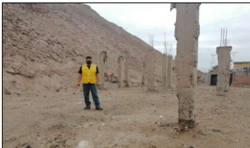
Figura 48. Vivienda destruida en la Mz. D del AA.HH. El Mirador
