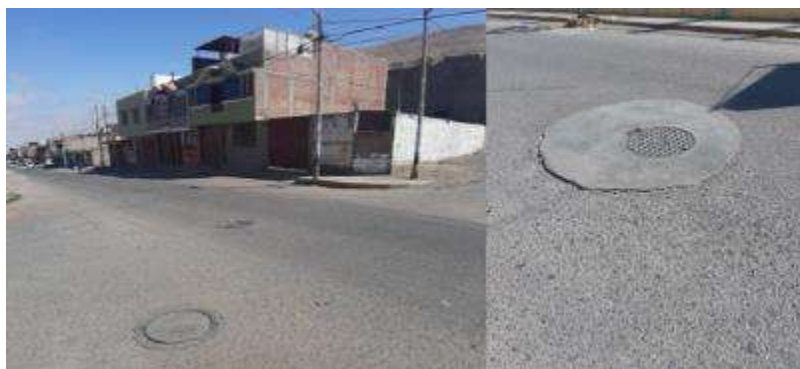
Figura 94. Buzones de desagüe. Fuente: Elaboración propia
