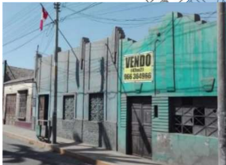
CASONA ABANDONADA Y DETERIORADA
