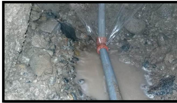
Figura N° 9: Fuga de agua en accesorio de acometida abril 2018, (fuente propia)
