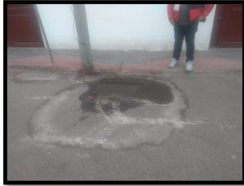
Figura N° 8: afloro Fuga de agua en acometida abril 2018, (fuente propia)
