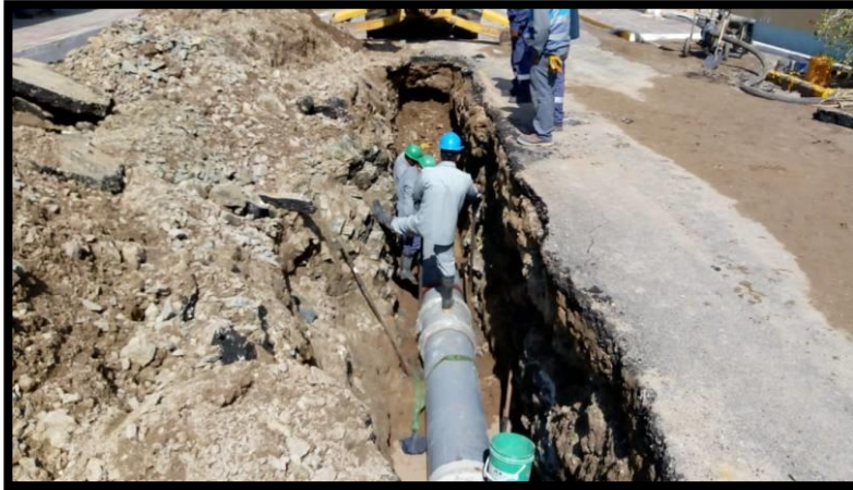
Figura N° 3: Rotura en línea de conducción de agua tratada (zona alto Ilo-chalaca)
