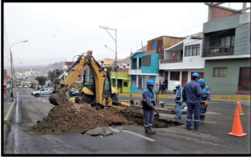
Figura N° 5: Rotura de línea de conducción de agua tratada (zona Kennedy)
