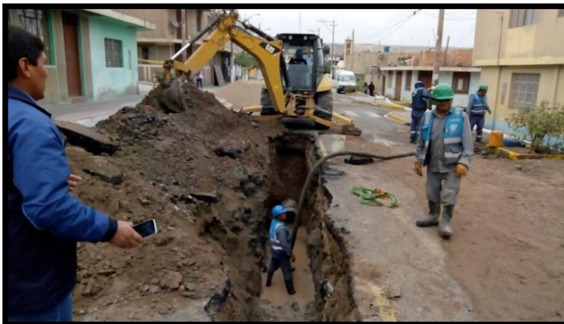
Figura N° 6: rotura de línea de conducción de agua tratada (zona Miramar)
