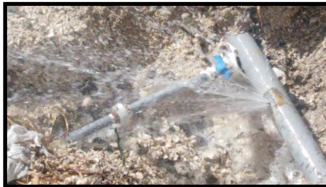
Figura N° 10: Fuga de agua en red de distribución mayo 2018, (fuente propia)
