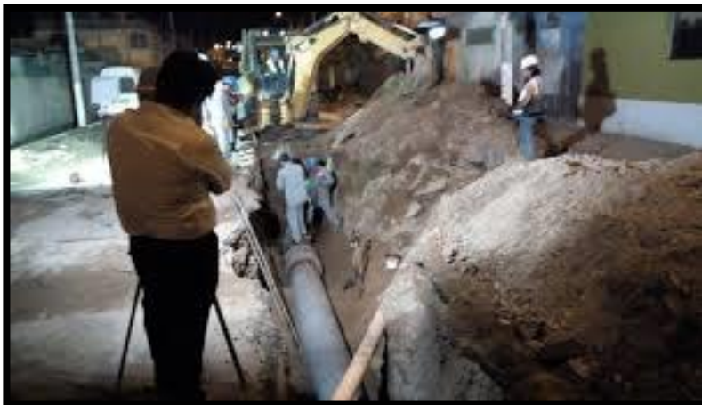
Figura N° 4: Rotura en línea de conducción, (zona alto Ilo-arenal)
