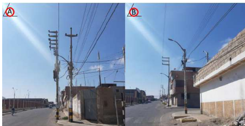
Figura 40: Postes de luz y transformadores en los alrededores.
