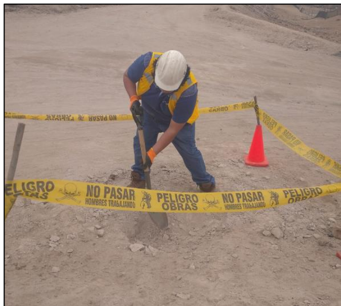
Figura 13. Excavación de calicata C-2, y toma de muestra en la sub rasante.
