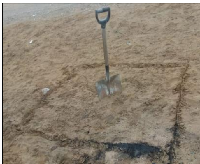
Figura 14. Excavación de calicata C-3, y toma de muestra de la sub rasante.
