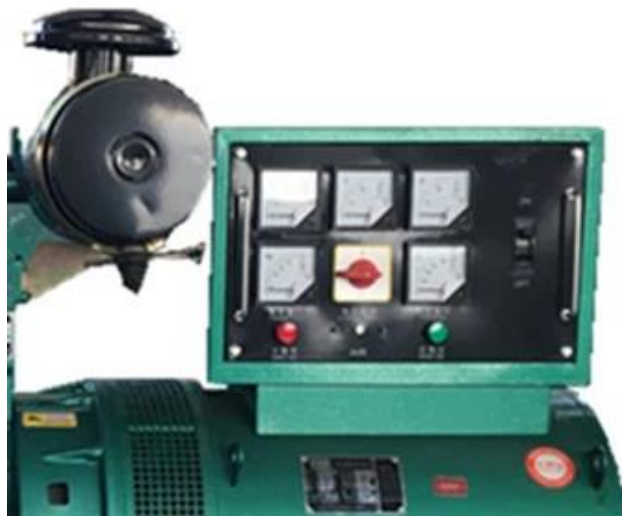
Figura 108. Tablero de controles.
