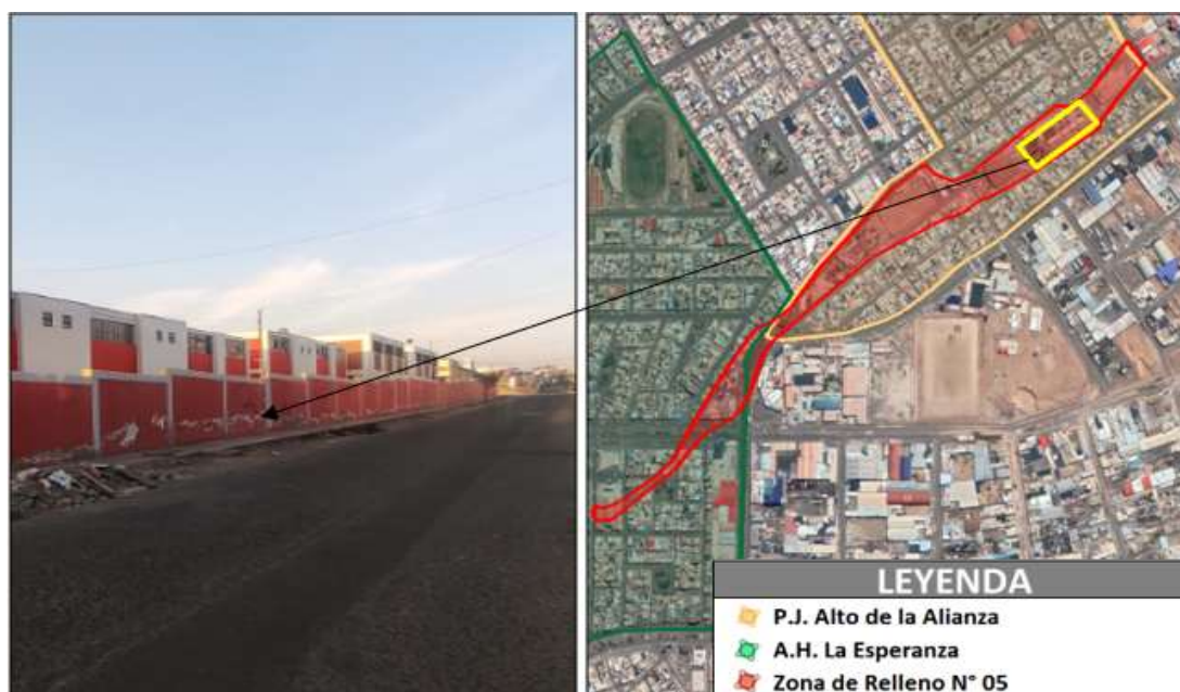
FIGURA N° 153. Presencia de grietas en muros perimétricos de la IEI 42198 y ubicación satelital
