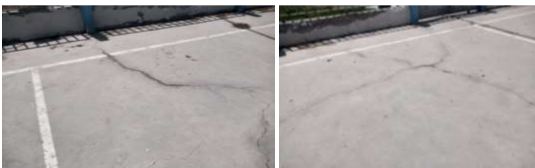
FIGURA N° 234. Presencia de Fisuras y grietas en la losa deportiva, Comité 10
