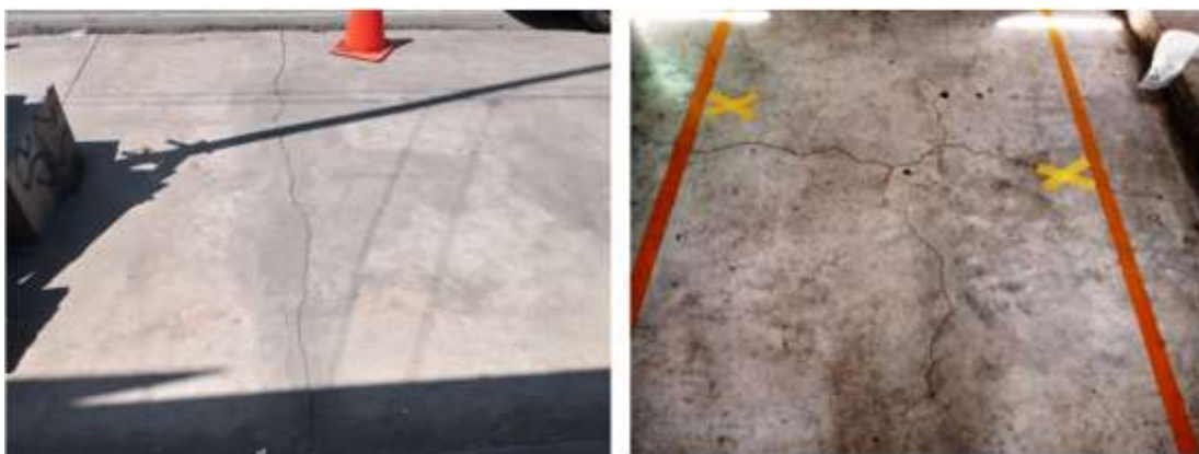
FIGURA N° 197. Presencia de Fisuras y grietas en el piso de concreto del mercado las mercedes
