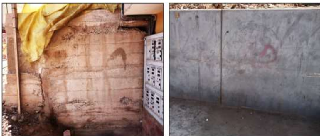
FIGURA N° 224. Presencia de Fisuras en los muros exteriores del mercado 1ero de mayo
