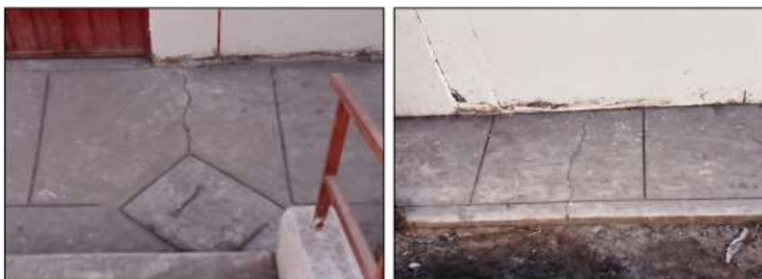
FIGURA N° 185. Presencia de Fisuras en las veredas de la losa deportiva comité 14
