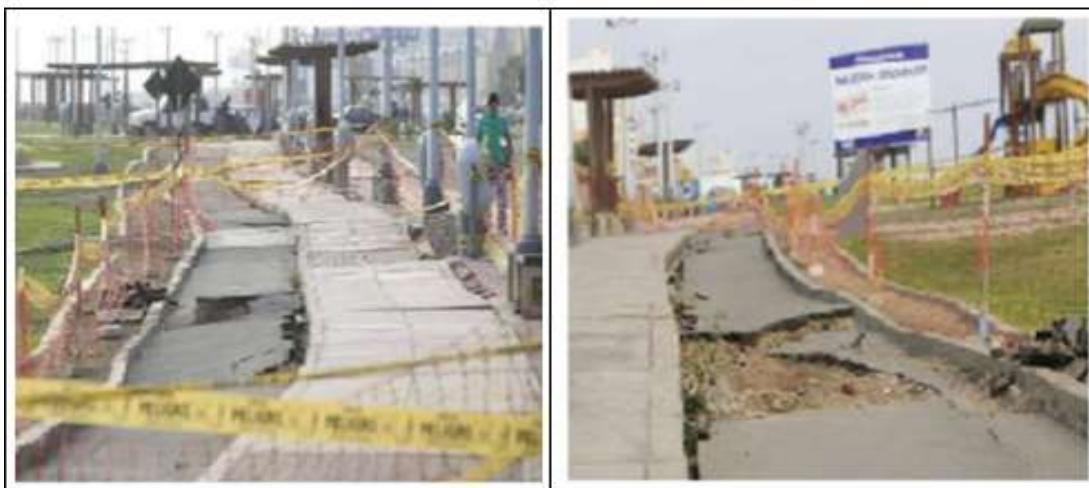
FIGURA N° 3. Fallas estructurales en el Malecón Costanera, tramo Av. Universitaria - Av. Rafael Escardo, San Miguel- Lima.
