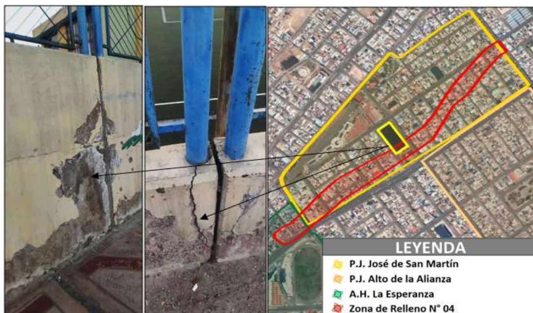
FIGURA N° 147. Presencia de grietas en muros y sobrecimientos de cerco perimétrico y ubicación satelital
