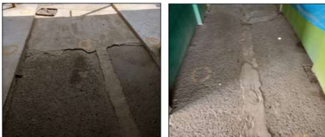
FIGURA N° 223. Presencia de Fisuras en el piso de concreto del mercado ferial Perú - Bolivia
