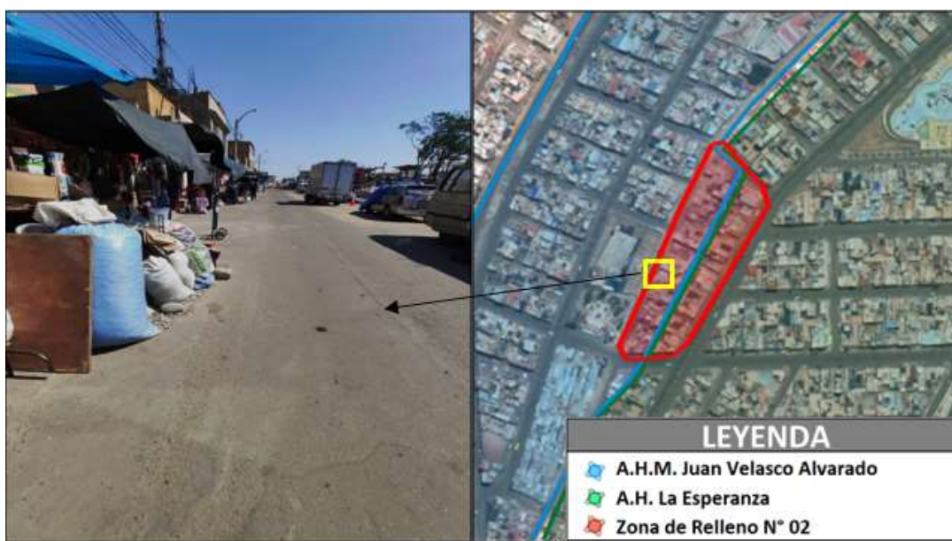
FIGURA N° 130. Presencia de desgaste de carpeta asfáltica en Calle Canadá y ubicación satelital
