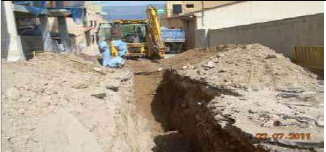
FIGURA N° 24. Presencia de rellenos no controlados en Obra de conducción de abastecimiento y saneamiento de la Calle Mallorca – Murcia
