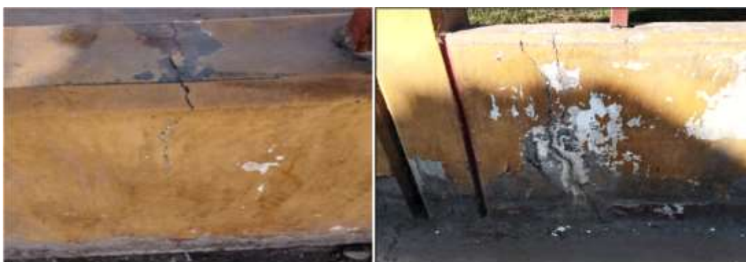
FIGURA N° 188. Presencia de Fisuras y Grietas en el sobre cimiento del cerco de la losa deportiva comité 16
