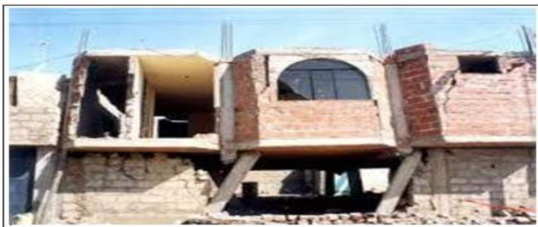
FIGURA N° 8. Terremoto de Tacna del 23 de junio del 2001, daños en edificaciones construidas sobre rellenos en el Distrito Ciudad Nueva.
