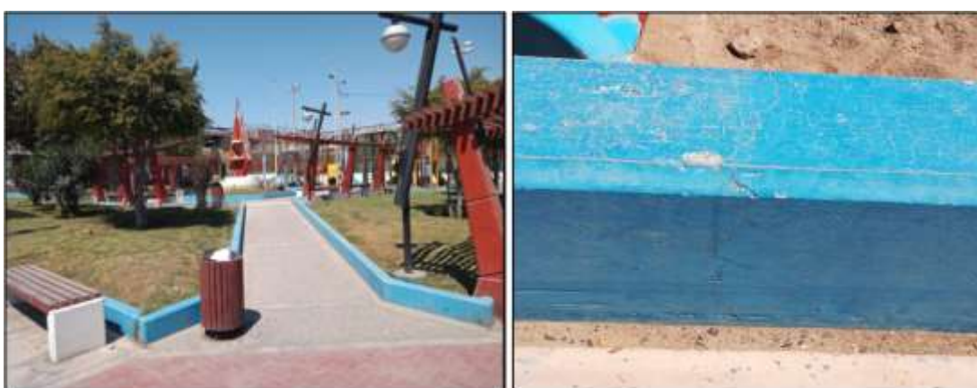
FIGURA N° 181. Presencia de Fisuras en las veredas y sardineles de la plaza comité 3
