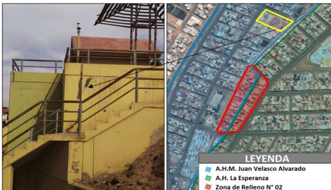
FIGURA N° 137. Grietas en muros internos del Centro Asistencial del Adulto Mayor y ubicación satelital
