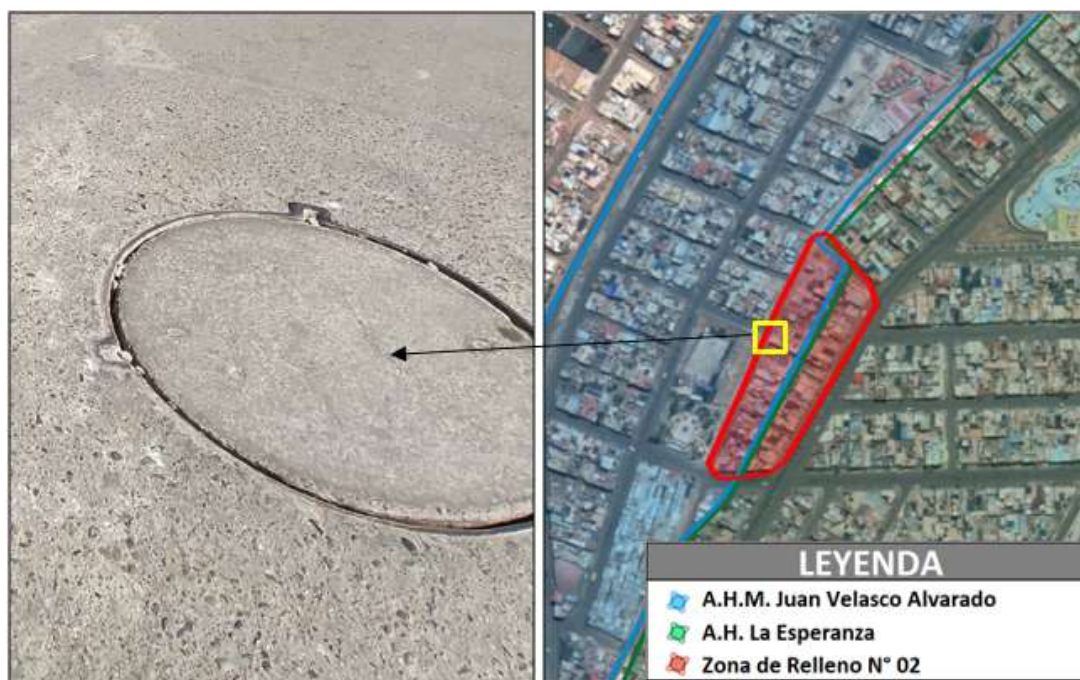
FIGURA N° 133. Presencia de tapas de concreto en buen estado en la Calle Canadá y ubicación satelital
