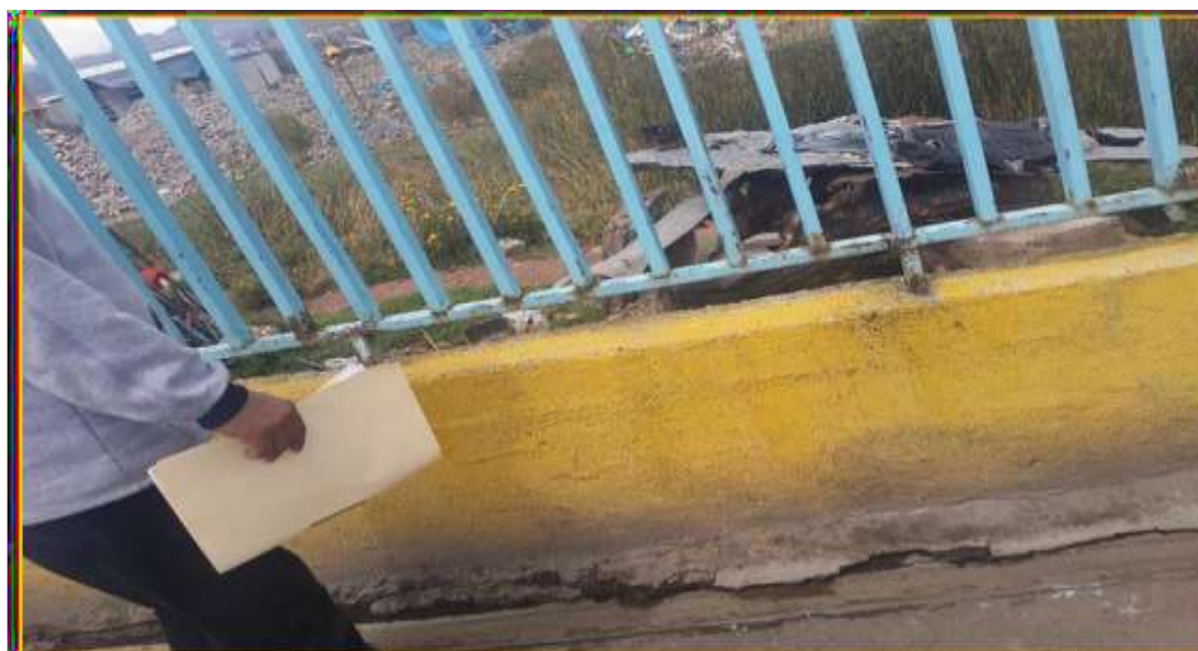
FIGURA N° 20. Asentamiento diferencial en muro perimétrico del Terminal Terrestre Puno - 2016
