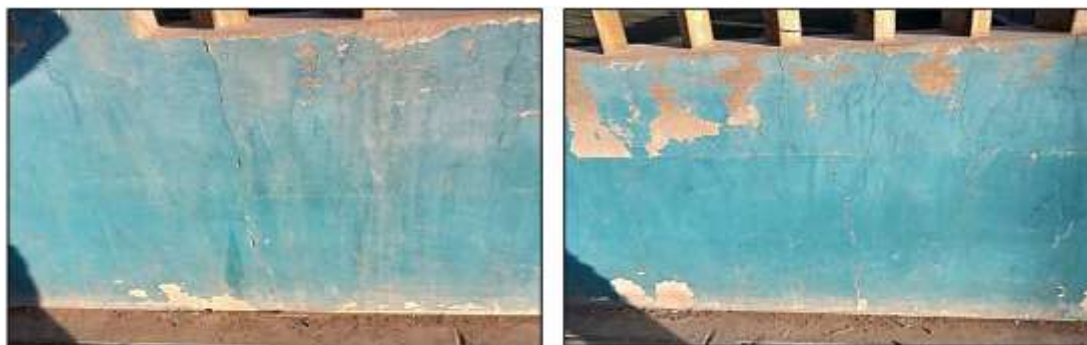
FIGURA N° 227. Presencia de Fisuras y Grietas en el sobre cemento del cerco del Campo Deportivo Cachipucara
