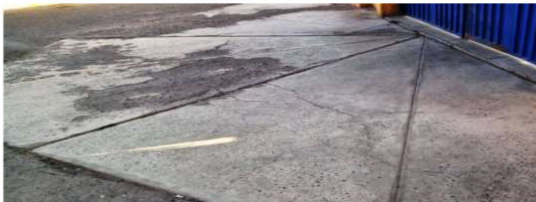
FIGURA N° 191. Presencia de Fisuras en la vereda exterior del complejo San José
