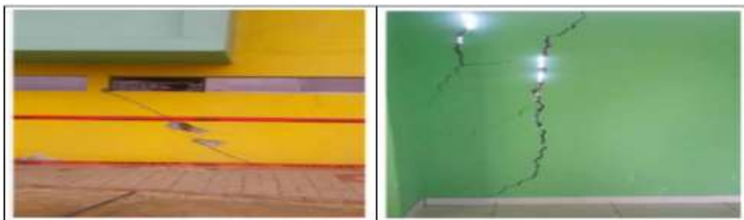
FIGURA N° 5. Grietas en muro exterior del Polideportivo Municipal de Ica
