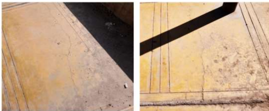
FIGURA N° 207. Presencia de Fisuras en las veredas de circulación de la plaza comité 27
