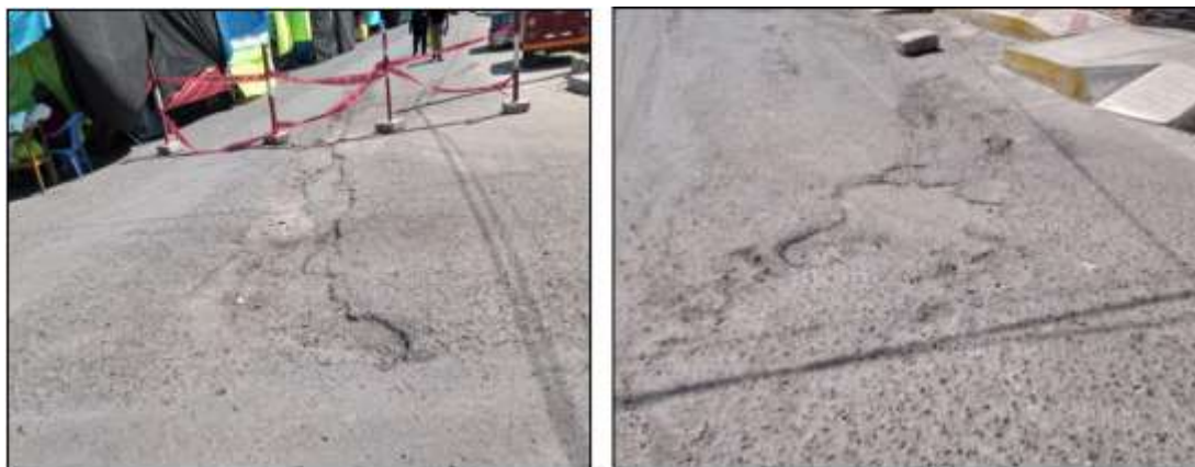
FIGURA N° 201. Presencia de Baches en asfalto de la Av. Mariano Necochea con CA. Baquíjano y Carrillo
