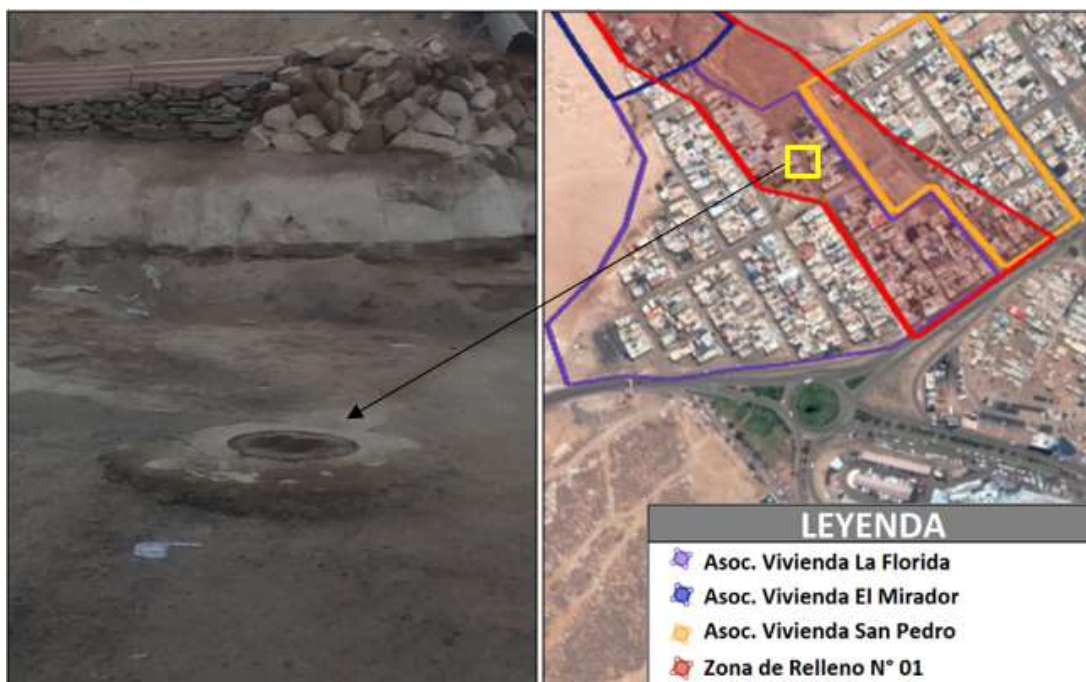
FIGURA N° 123. Presencia de grietas y desgaste del concreto de buzón y ubicación satelital.
