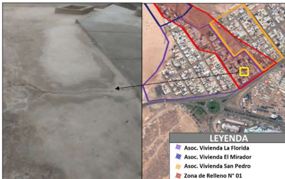
FIGURA N° 125. Presencia de grietas en bermas y ubicación satelital
