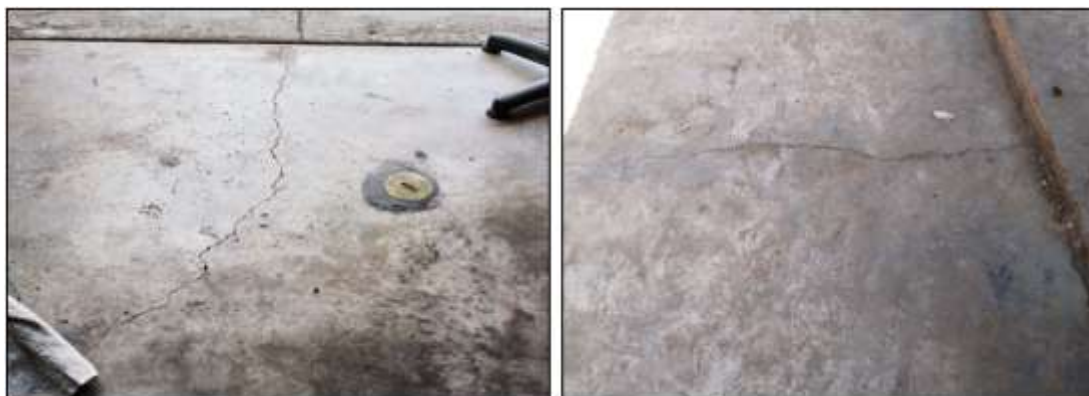
FIGURA N° 199. Presencia de Fisuras en el piso de concreto del mercado “La Bombonera” Fuente: Visita a campo 29 de setiembre de 2020
