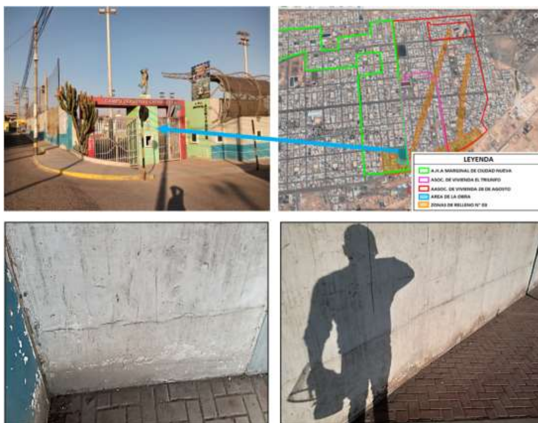
FIGURA N° 226. Presencia de Fisuras y Grietas en los muros del Campo Deportivo Cachipucara
