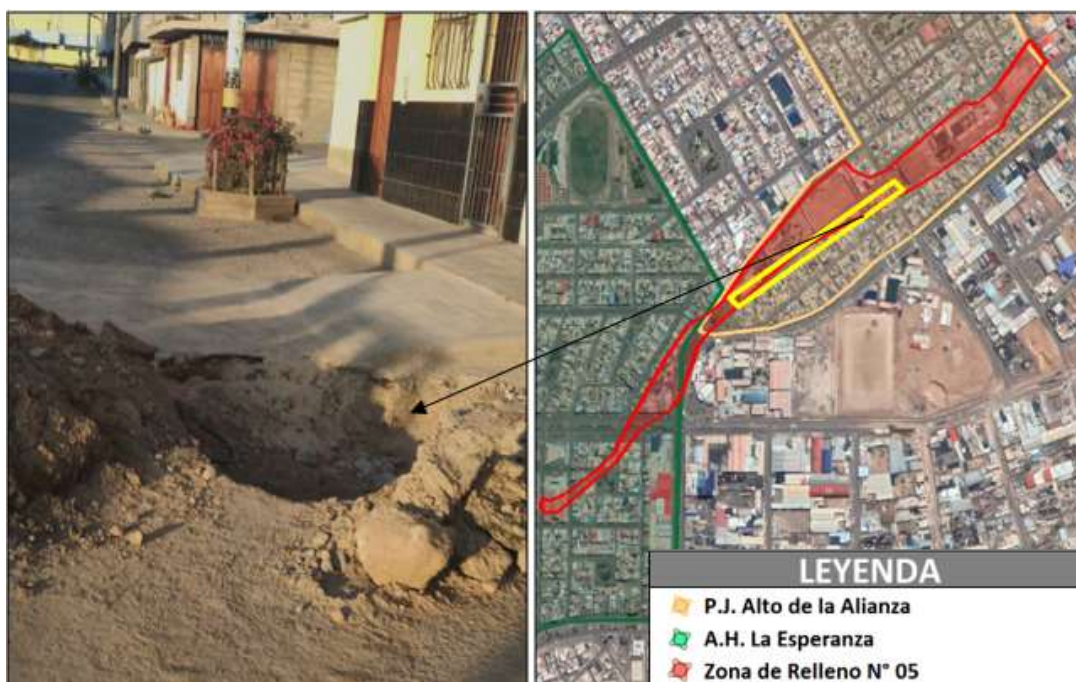
FIGURA N° 167. Presencia de grietas y baches en Calle 27 de agosto y ubicación satelital
