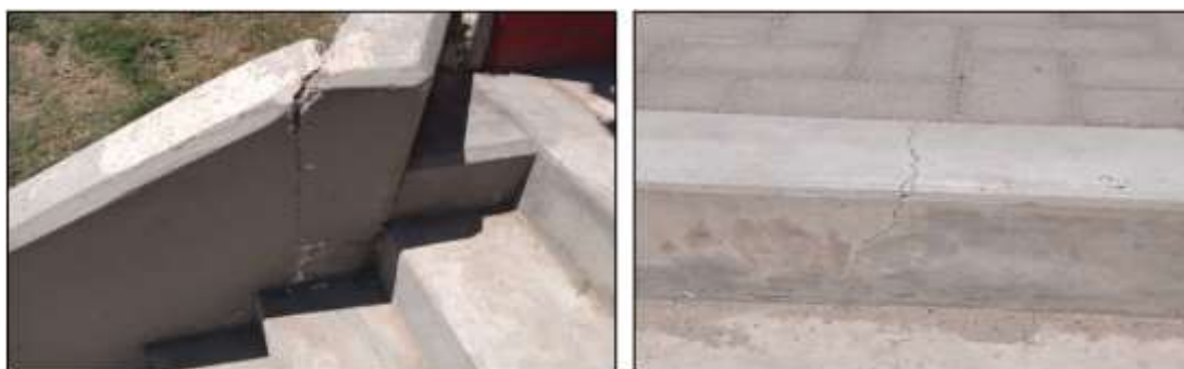
FIGURA N° 178. Presencia de Fisuras en las veredas y sardineles de la plaza comité 2
