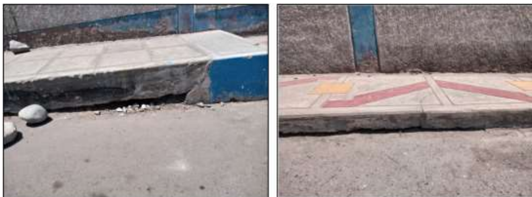
FIGURA N° 174. Presencia de Fisuras y Grietas en los muros del Estadio Municipal la Bombonera
