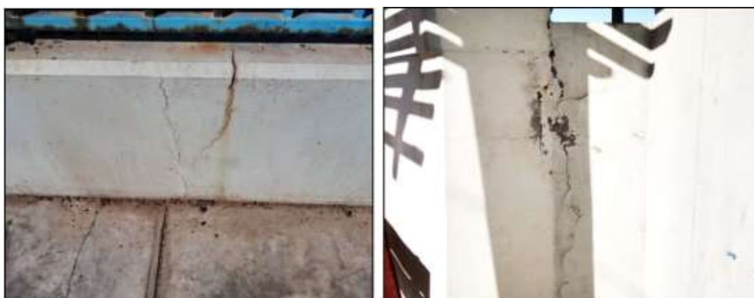
FIGURA N° 206. Presencia de Fisuras y Grietas en el sobre cimiento del cerco de la loza deportiva comité 27
