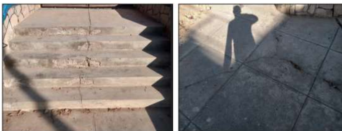
FIGURA N° 209. Presencia de Fisuras y Grietas en las escalera y veredas de circulación de la Plaza y losa Deportiva Comité 28
