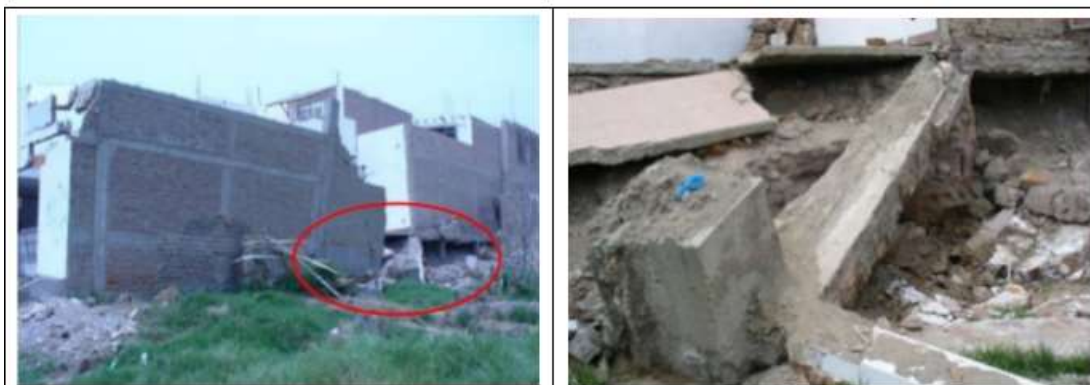
FIGURA N° 1. Terremoto de Pisco del 15 de agosto del 2007, daños en edificaciones construidas sobre rellenos no controlados.
