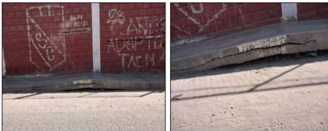
FIGURA N° 204. Presencia de Fisuras y Grietas en las veredas exteriores de la I.E.I Manuel A. Odría
