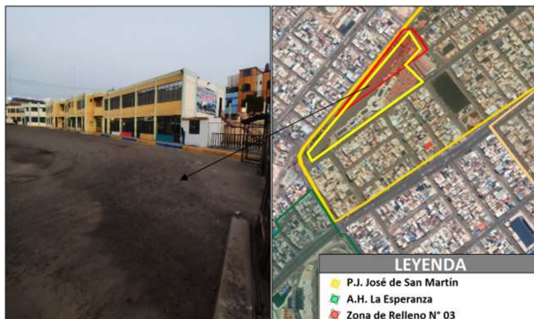
FIGURA N° 139. Presencia de fisuras en plataforma del Terminal Terrestre El Collasuyo y ubicación satelital
