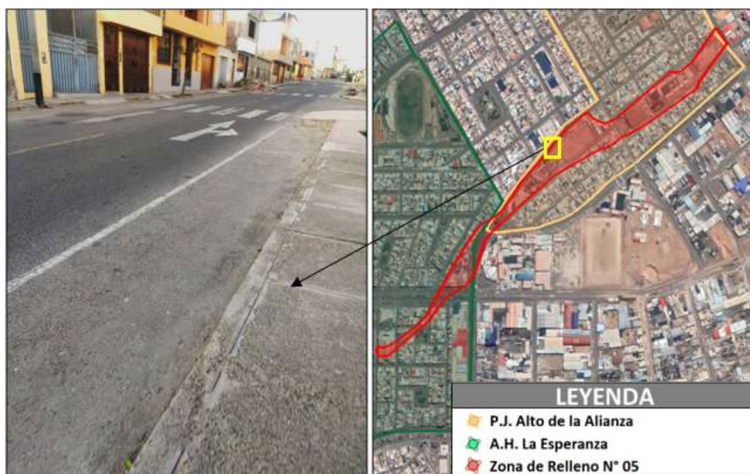
FIGURA N° 163. Presencia de desprendimiento de concreto por presencia de salitre en veredas y ubicación
