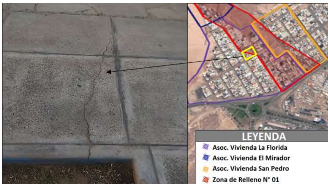
FIGURA N° 121. Presencia de grietas en veredas de la Plaza La Florida y ubicación satelital
