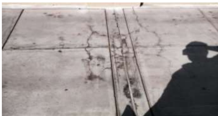
FIGURA N° 230. Fisuras en las veredas exteriores de la Iglesia de Jesucristo de los Santos de los Últimos Días
