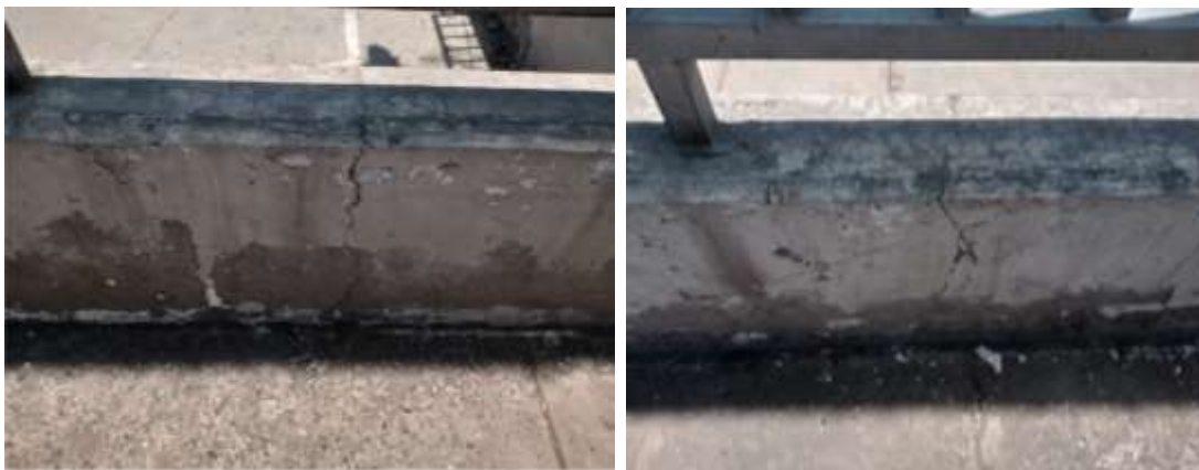
FIGURA N° 233. Presencia de Fisuras en el sobrecimiento del cerco en la losa deportiva, comité 10
