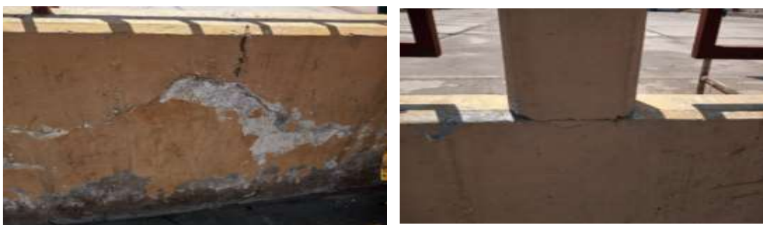
FIGURA N° 237. Fisuras en el sobrecimiento en el Local Multiusos, Cte. 17
