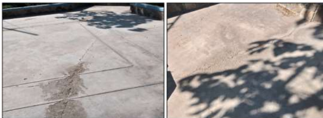
FIGURA N° 183. Presencia de Fisuras en las veredas de circulación de la plaza comité 04
