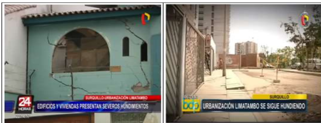
FIGURA N° 6. Grietas en viviendas y fallas por asentamiento en veredas de la Urbanización Limatambo – Lima
