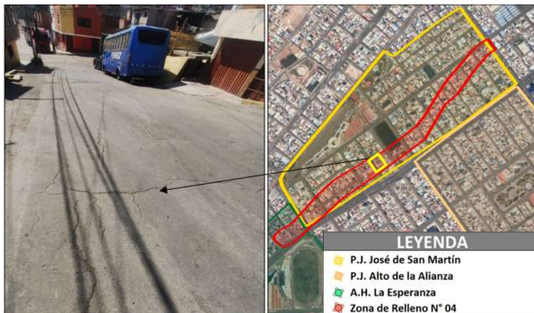
FIGURA N° 140. Presencia de grietas en Calle Torre Tagle y ubicación satelital
