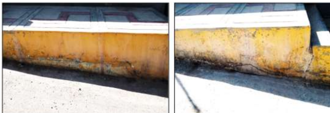
FIGURA N° 225. Presencia de Fisuras en las veredas exteriores del Mercado 1ero de Mayo
