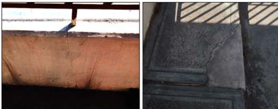
FIGURA N° 186. Presencia de Fisuras y Grietas en el sobrecimiento del cerco y vereda exterior de la losa deportiva comité 14
