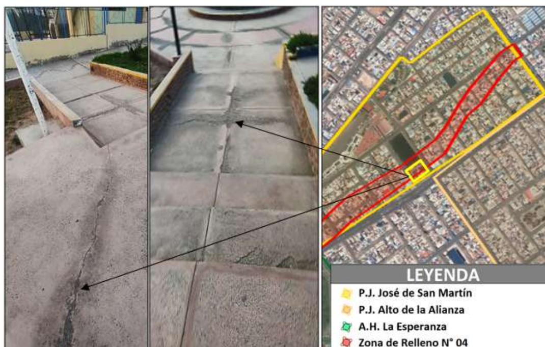
FIGURA N° 145. Presencia de grietas en caminerías de concreto de Plaza de los Enamorados y ubicación
