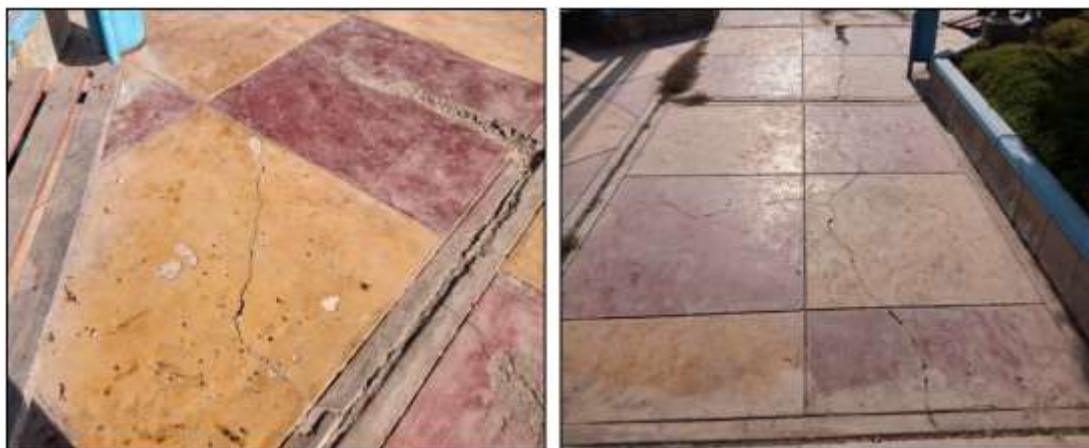
FIGURA N° 219. Presencia de Fisuras y Grietas en las veredas de circulación en Plaza de la Asociación de Vivienda la Frontera
