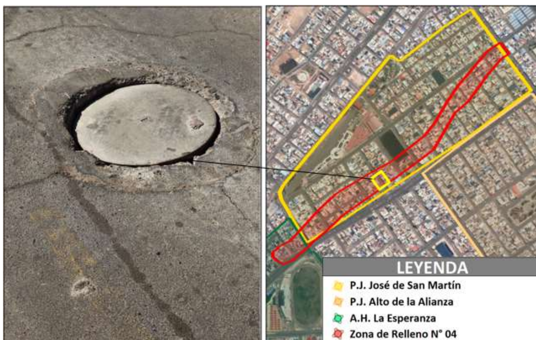
FIGURA N° 143. Presencia de grietas en carpeta asfáltica y desgaste en tapas de buzón y ubicación satelital
