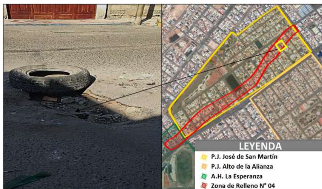
FIGURA N° 141. Presencia de baches en la Calle Gian Carlos y ubicación satelital
