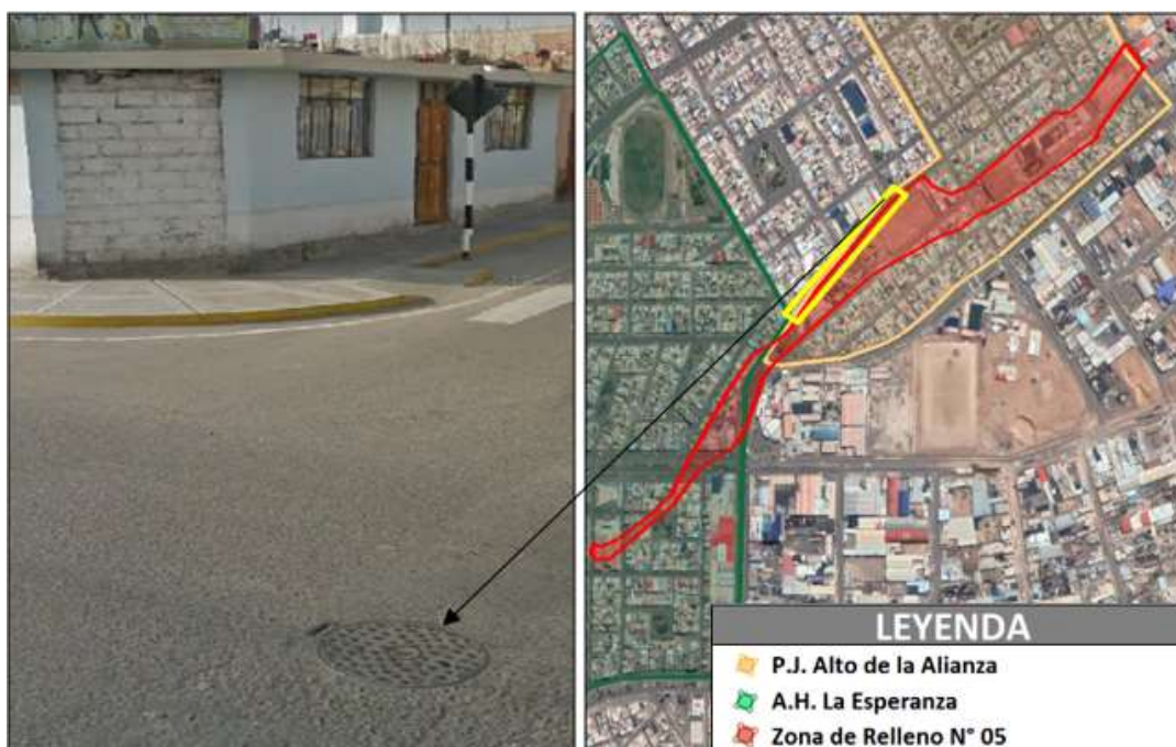
FIGURA N° 164. Tapa de buzón en cruce de Av. Pinto y Calle Sánchez Cerro en buen estado y ubicación
