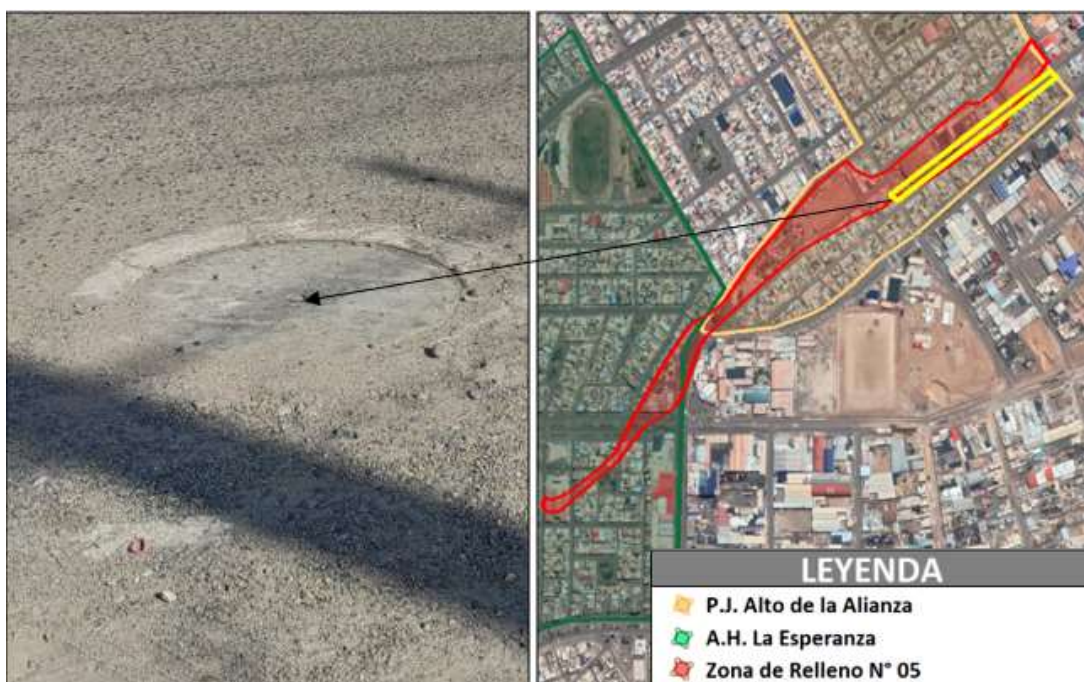
FIGURA N° 169. Presencia de buzones con desgaste leve en la Av. Aviación y ubicación satelital
