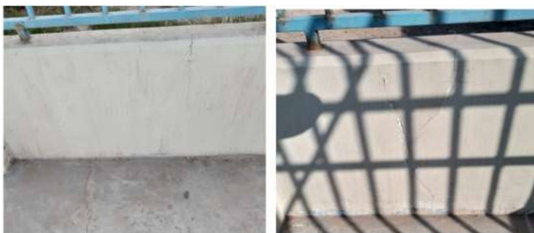
FIGURA N° 221. Presencia de Fisuras y grietas en el sobre cimiento del cerco en la losa deportiva de la Asociación de Vivienda la Frontera
