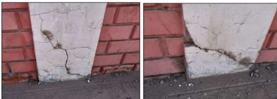
FIGURA N° 203. Presencia de Fisuras y Grietas en las columnas del muro exterior del I.E Manuel A. Odría
