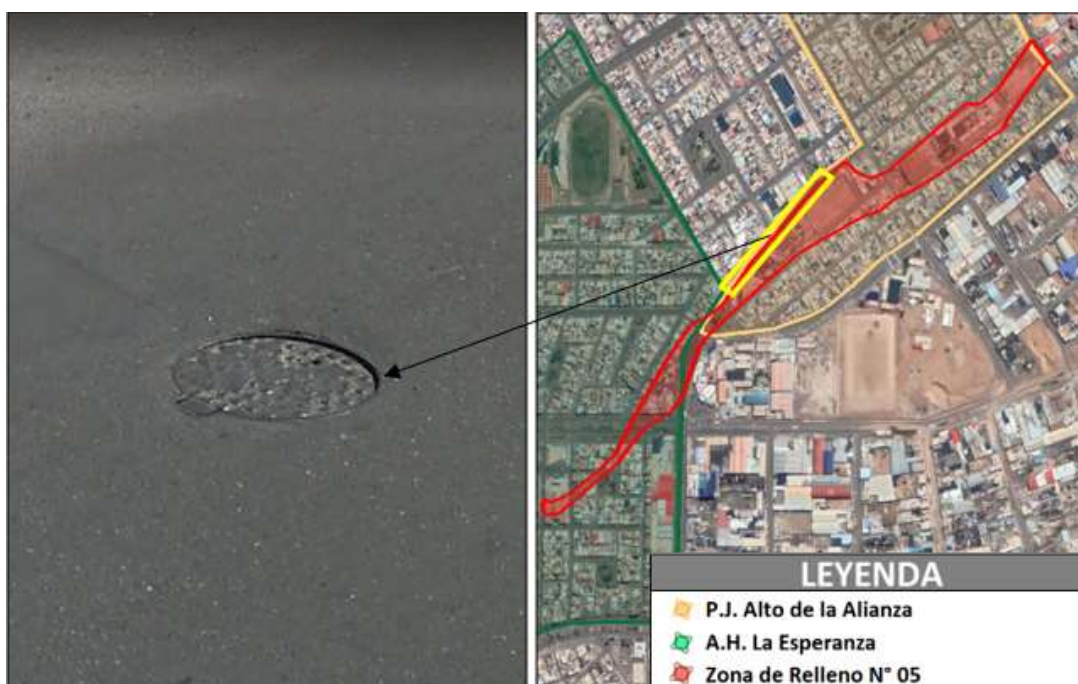
FIGURA N° 165. Tapa de buzón en la Pról. Av. Pinto en buen estado y ubicación satelital
