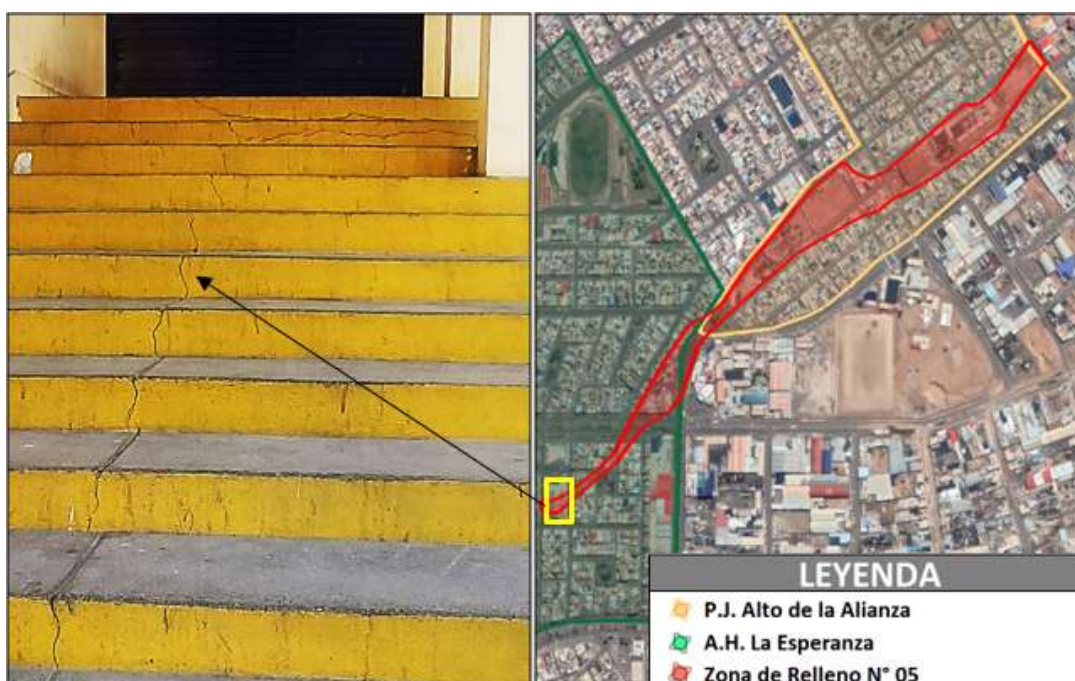
FIGURA N° 161. Grietas verticales y horizontales en graderías de ingreso secundario y ubicación satelital
