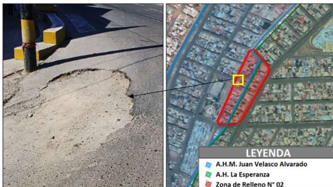
FIGURA N° 131. Presencia de baches en cruce de Calle Canadá y Pje. Juan Pablo Vizcardo
