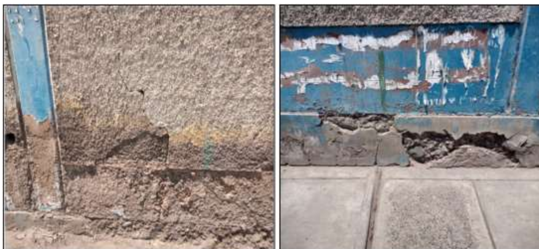
FIGURA N° 173. Presencia de Fisuras y Grietas en los muros del Estadio Municipal la Bombonera
