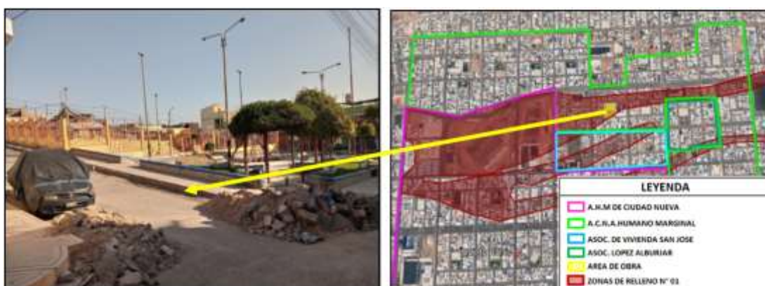
FIGURA N° 208. Presencia de Fisuras y grietas en la Plaza y loza deportiva comité 28
