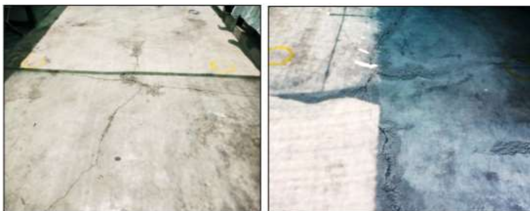
FIGURA N° 193. Presencia de Fisuras y Grietas en el piso de concreto del mercado ferial Perú - Bolivia
