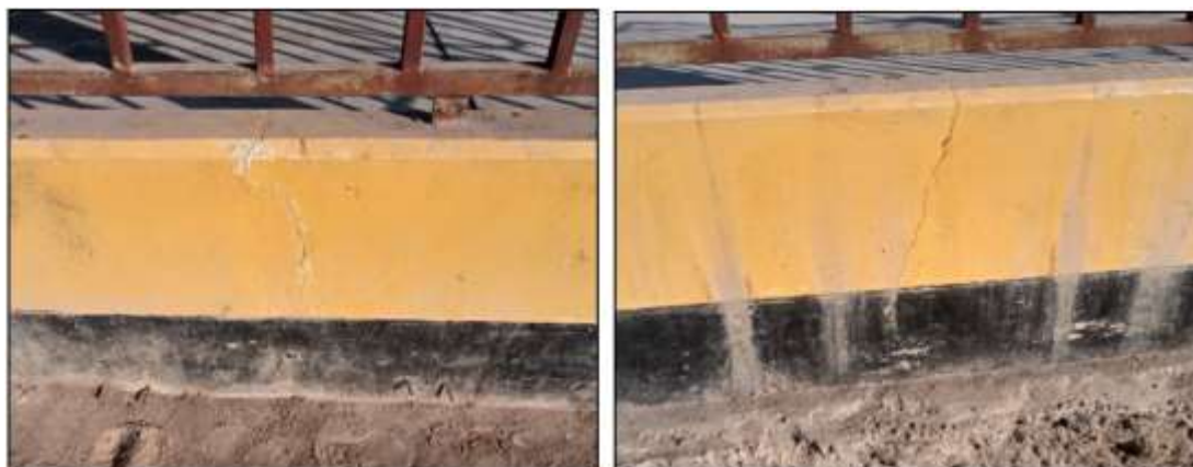
FIGURA N° 210. Presencia de Fisuras y Grietas en el sobre cimiento del cerco de la loza deportiva comité 28
