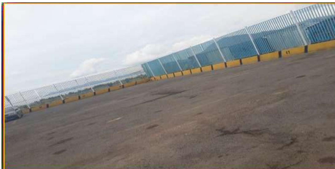
FIGURA N° 21. Asentamiento diferencial en zona de garaje del Terminal Terrestre Puno - 2016
