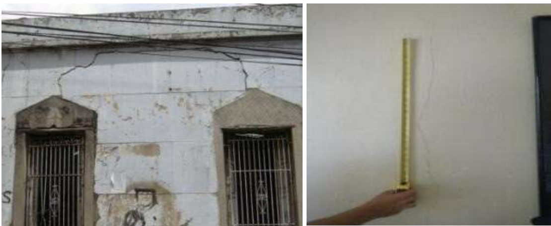
Ejemplo de Grieta y ejemplo de fisura
