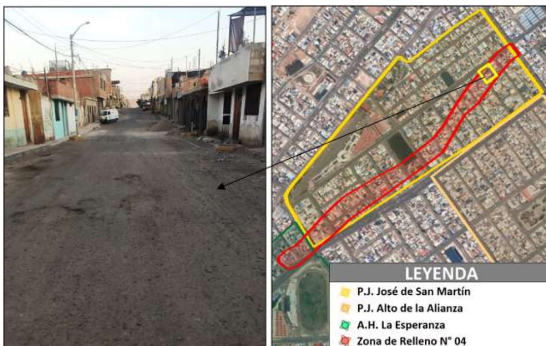
FIGURA N° 142. Presencia de grietas en asfalto Calle Gian Carlos y ubicación satelital
