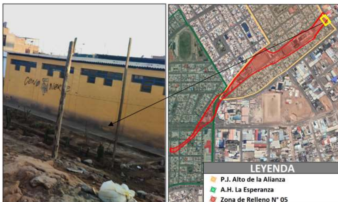
FIGURA N° 149. Presencia de salitre en muros exteriores del Comedor San Francisco y ubicación satelital
