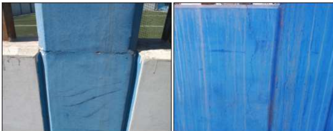
FIGURA N° 180. Presencia de Fisuras en las columnas y muros de losa deportiva comité 3
