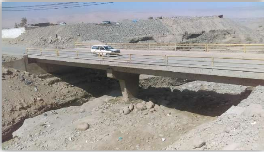
Se aprecia el puente y la socavación en sus pilares
