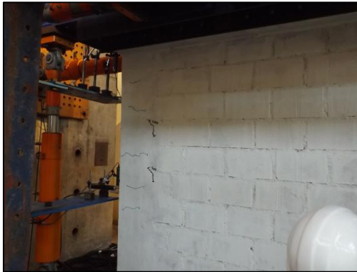
Foto 1. Formación de pequeñas grietas cercanas a las columna Oeste a una distorsión 1/1500.
