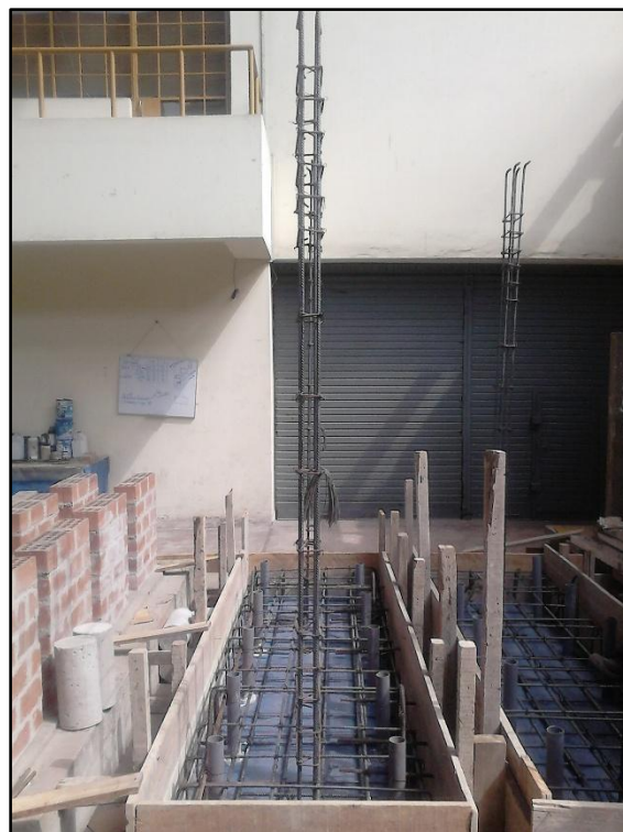
Fig. 3-6 Colocado de columnas y 4 anclajes para el posterior traslado del muro a la zona de ensayo
