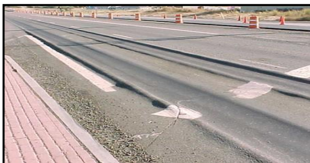
Figura 46: Ahuaellamiento de severidad alta
