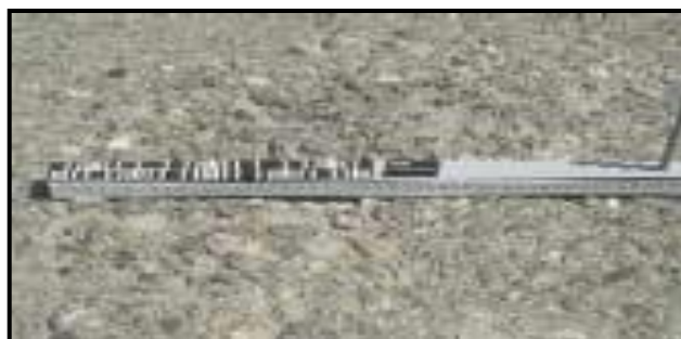
Figura 58: Disgregación y desintegración (desprendimiento) severidad alta
