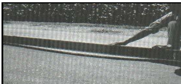
Figura 21: Depresión de severidad alta
