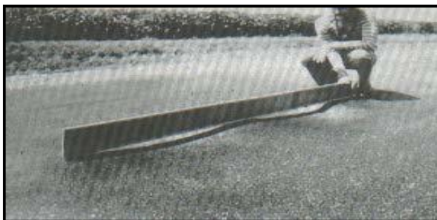
Figura 20: Corrugación severidad alta
