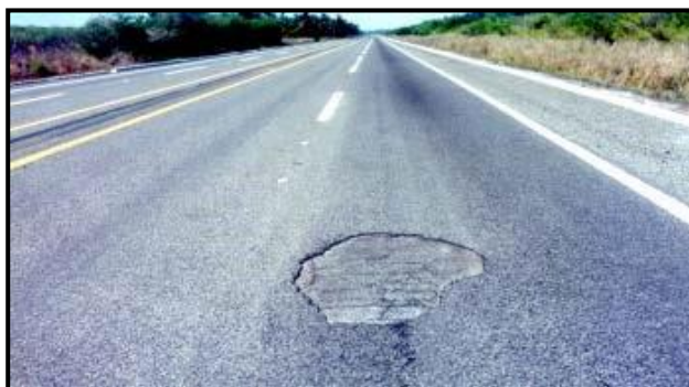
Figura 41: Hueco de severidad media
