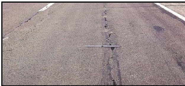
Figura 34: Grietas longitudinales y transversales de severidad alta
