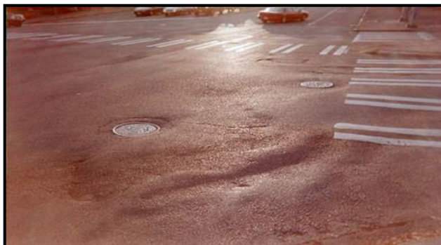
Figura 49: Desplazamiento de severidad alta
