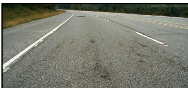
Figura 55: Disgregación y desintegración (desprendimiento)
