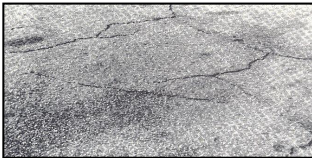
Figura 13: Fisuras en bloques de severidad bajo
