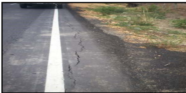
Figura 23: Fisura de borde de severidad media
