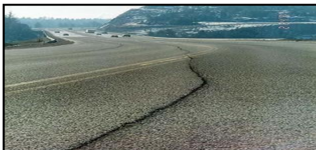
Figura 31: Grietas longitudinales y transversales
