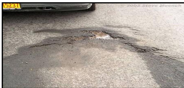
Figura 52: Fisuras por desplazamiento severidad alta
