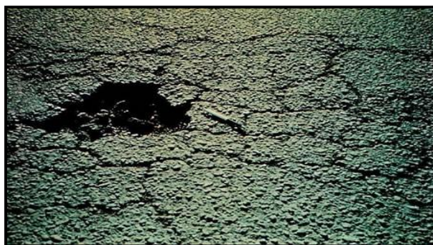
Figura 9: Piel de cocodrilo de severidad alta
