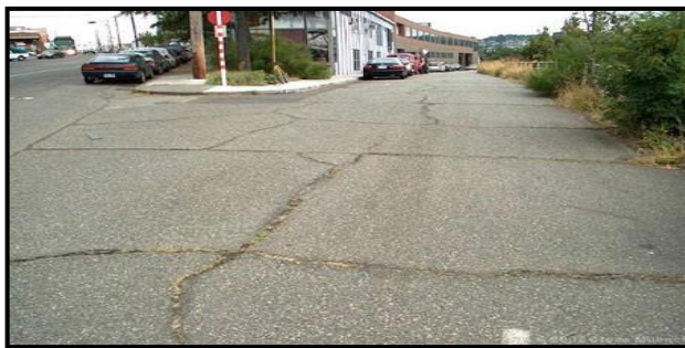
Figura 27: Grietas de reflexión de juntas de losas de concreto severidad alta
