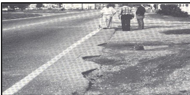
Figura 24: Fisura de borde de severidad alta
