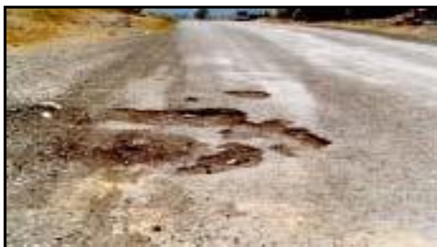
Figura 42: Hueco de severidad alta
