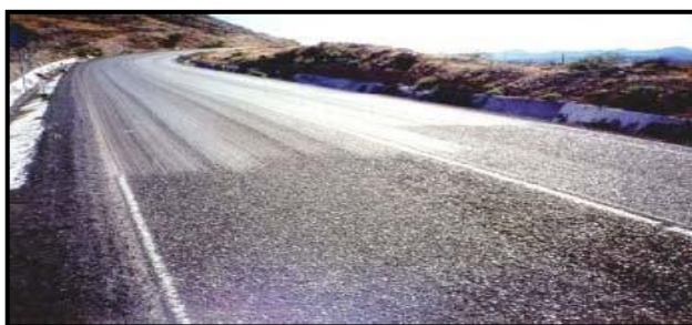
Figura 56: Disgregación y desintegración (desprendimiento)
