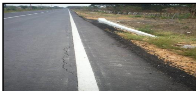
Figura 22: Fisura de borde de severidad baja
