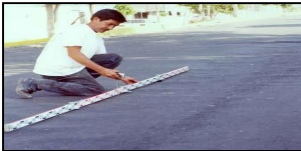
Figura 19: Corrugación de severidad media
