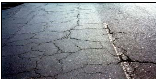
Figura 14: Fisuras en bloques de severidad media
