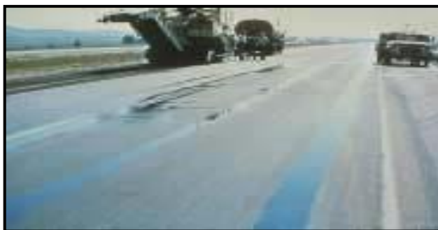
Figura 44: Ahuaellamiento de severidad baja
