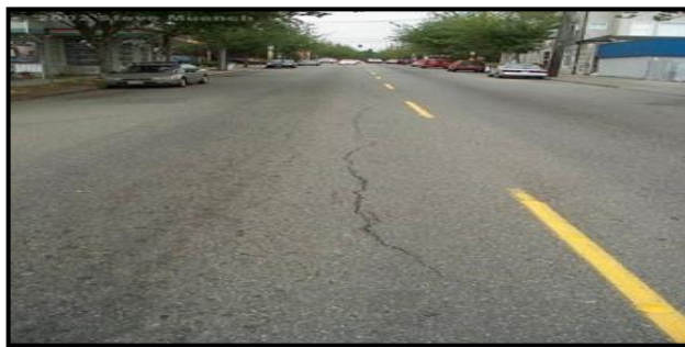
Figura 32: Grietas longitudinales y transversales de severidad baja
