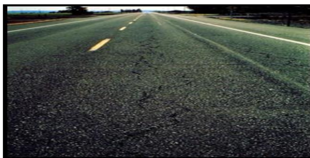
Figura 33: Grietas longitudinales y transversales de severidad media
