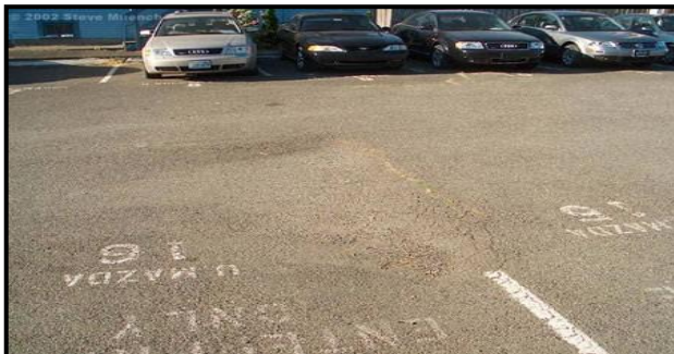
Figura 16: Abultamientos y hundimientos de severidad media
