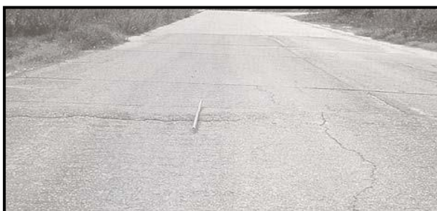
Figura 54: Hinchamiento de severidad media
