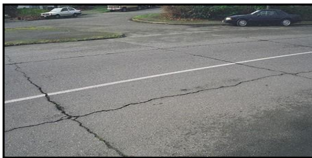
Figura 25: Grieta de Reflexión de Juntas de Losas de Concreto
