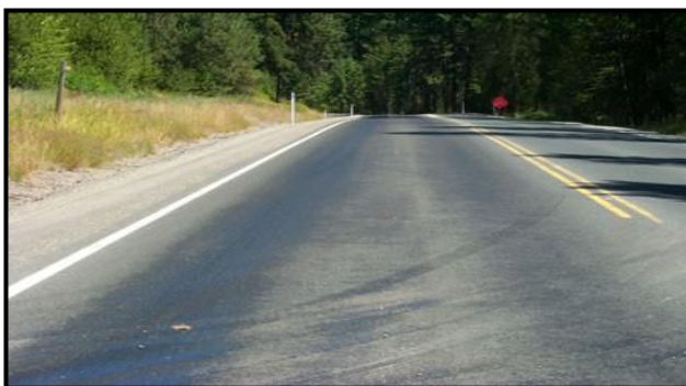
Figura 10: Exudación de severidad baja
