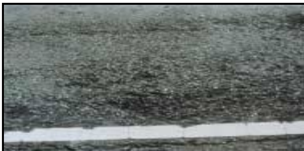
Figura 57: Disgregación y desintegración (desprendimiento) severidad media
