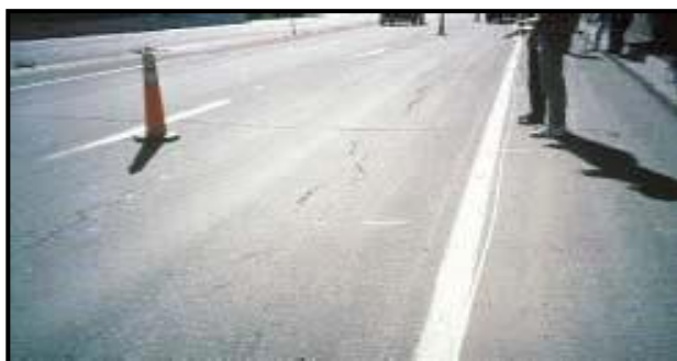
Figura 7: Piel de cocodrilo de severidad baja
