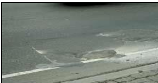
Figura 37: Parche de severidad alta
