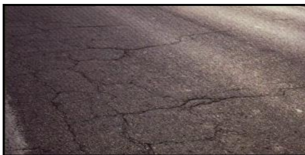
Figura 3: Grietas de contracción (o de Bloque)
