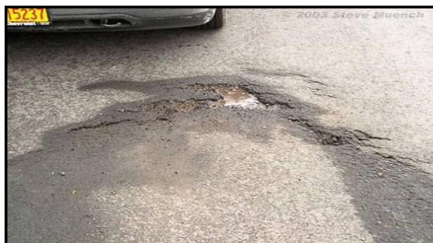
Figura 50: Fisuras por desplazamiento
