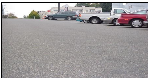
Figura 18: Corrugación de severidad baja
