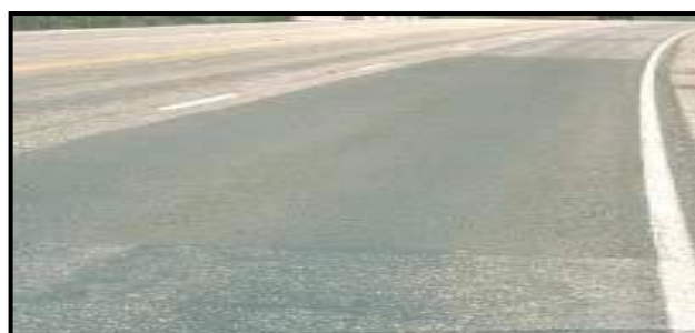
Figura 35: Parche de severidad baja
