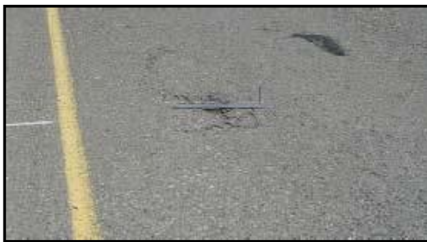
Figura 40: Huecos de severidad baja
