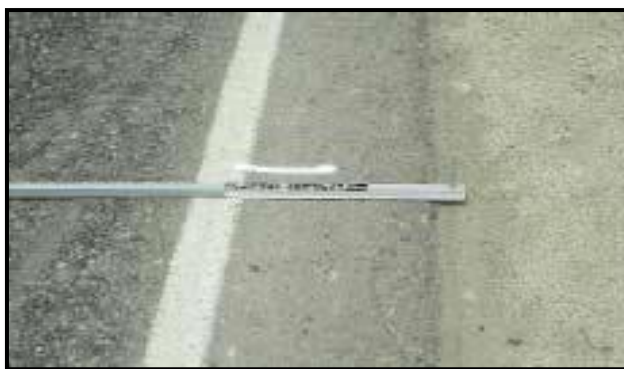
Figura 29: Desnivel – carril berma de severidad media
