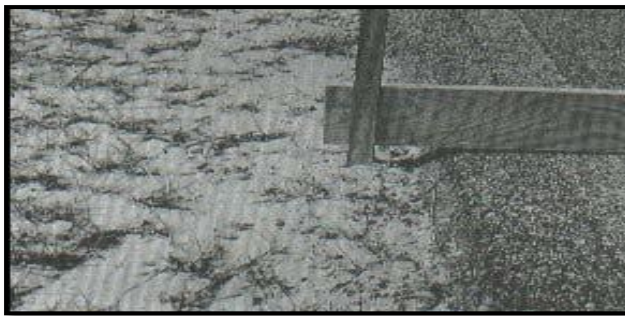
Figura 30: Desnivel – carril berma de severidad alta
