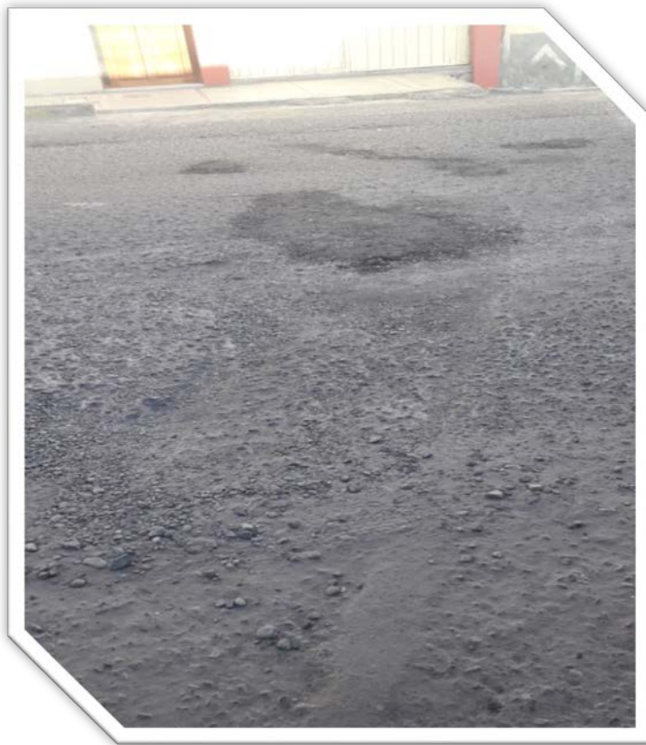
Figura N° 04: Zona de investigación, presencia de huecos en la capa de rodadura.
