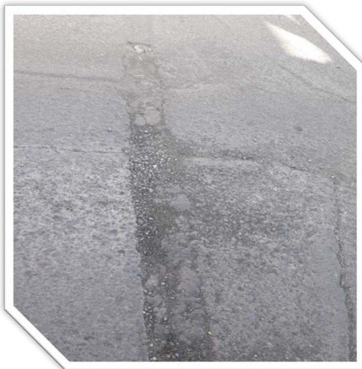
Figura N° 02: Zona de investigación, presencia de fisuras Av. Juan Moore Fuente: Elaboración propia
