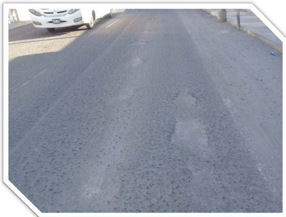
Figura N° 05: Zona de investigación, desgaste de pavimento flexible.
