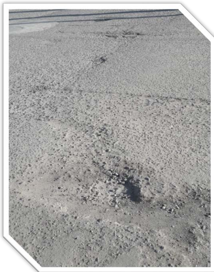
Figura N° 03: Zona de investigación, condiciones del pavimento flexible. Fuente: Elaboración propia
