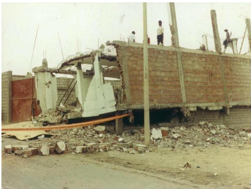
Foto 1. Vista de falla en una vivienda informal construida con unidades huecas. Las unidades huecas son muy frágiles por carga vertical y fuerza cortante, por lo que está prohibido su uso en zonas altamente sísmicas. Apuntes de clase del curso de Albañilería Estructural, Ing. Dina Cotrado (2019).
