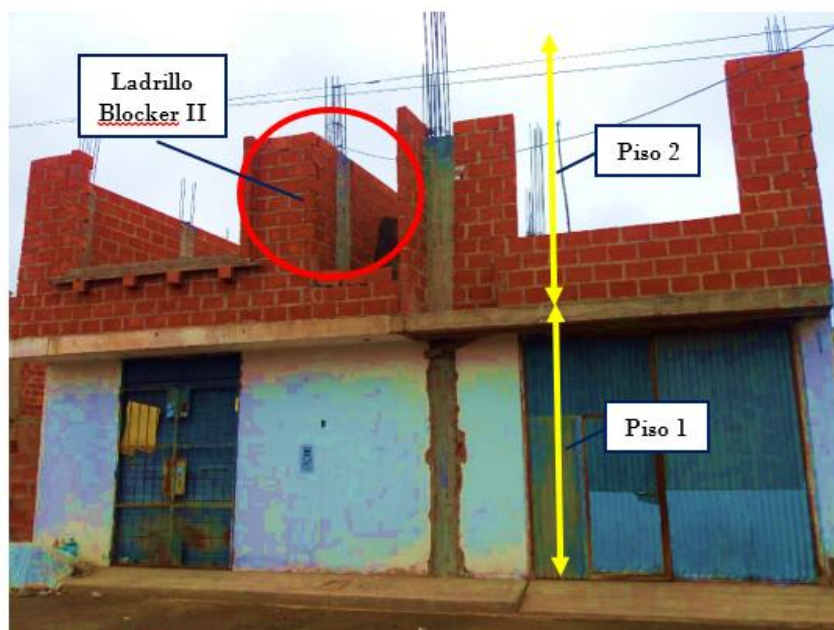
Foto 13. Vista de vivienda 12. Vivienda edificada con la unidad de albañilería de arcilla cocida Blocker II, presenta 1 piso terminado y el otro piso en proceso de construcción.
