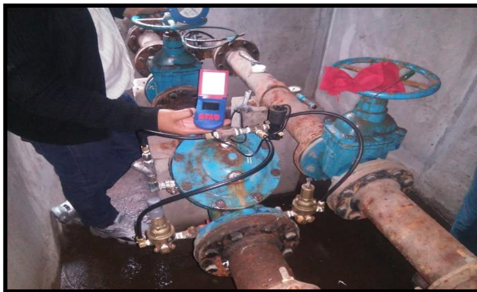
FOTOGRAFIA 4: válvula doble consigna automatizada.
