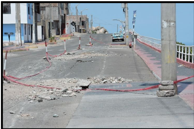
FOTOGRAFIA 2 Asentamiento y agrietamiento de tramo de pista en San Pedro
