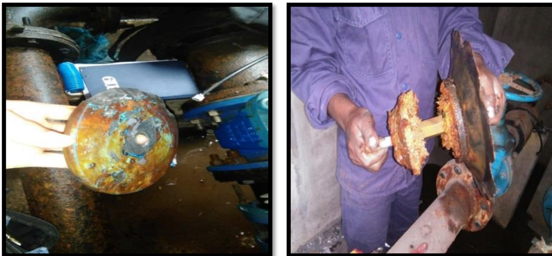
FOTOGRAFIA 3: mantenimiento de válvulas
