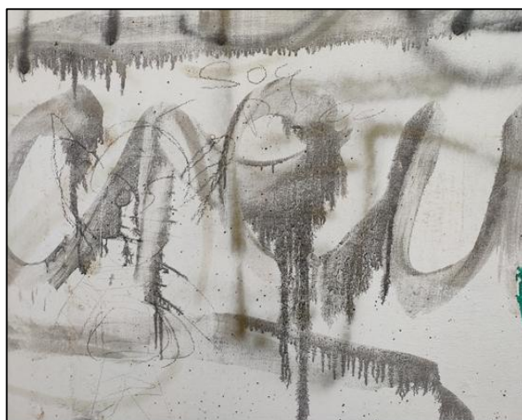
Fotografía 50. Presencia de suciedad en la estructura de concreto armado. Fuente: Elaboración propia.
