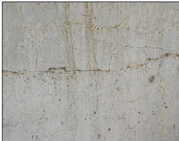
Fotografía 8. Presencia de fisuras en la estructura de concreto armado. Fuente: Elaboración propia.
