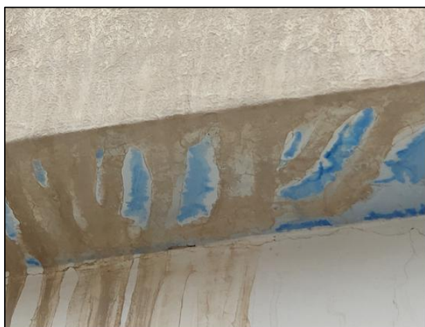
Fotografía 75. Presencia de suciedad en la estructura de concreto. Fuente: Elaboración propia.
