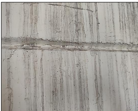
Fotografía 45. Presencia de fisuras en la estructura de concreto. Fuente: Elaboración propia.
