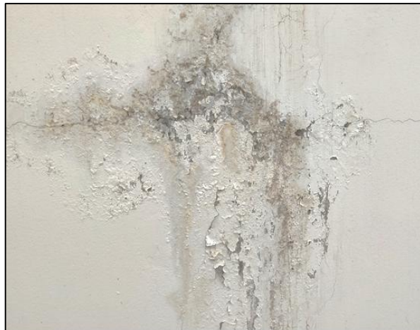
Fotografía 68. Presencia de humedad en la estructura de concreto armado. Fuente: Elaboración propia.
