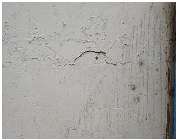
Fotografía 10. Presencia de deformaciones en la estructura de concreto. Fuente: Elaboración propia.
