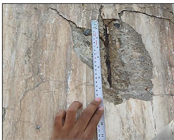
Fotografía 48. Presencia de oxidación en la estructura de concreto. Fuente: Elaboración propia.
