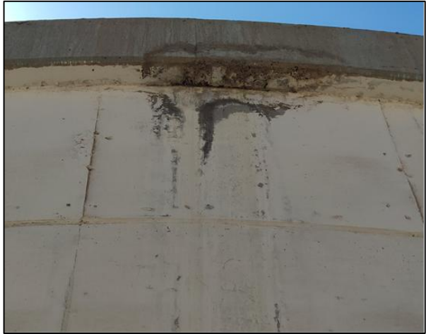
Fotografía 60. Presencia de eflorescencias en la estructura de concreto. Fuente: Elaboración propia.
