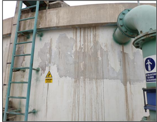
Fotografía 62. Presencia de suciedad en la estructura de concreto armado. Fuente: Elaboración propia.
