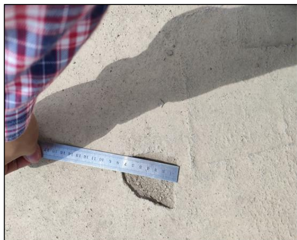
Fotografía 11. Presencia de desintegración en la estructura de concreto. Fuente: Elaboración propia.
