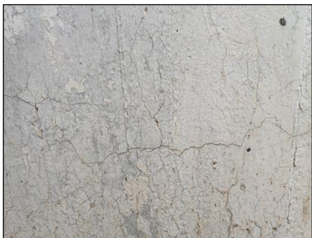
Fotografía 83. Presencia de fisuras en la estructura de concreto. Fuente: Elaboración propia.
