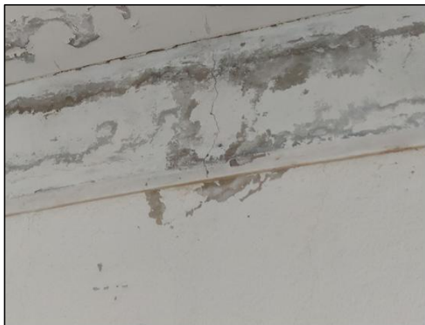
Fotografía 73. Presencia de humedad en la estructura de concreto. Fuente: Elaboración propia.
