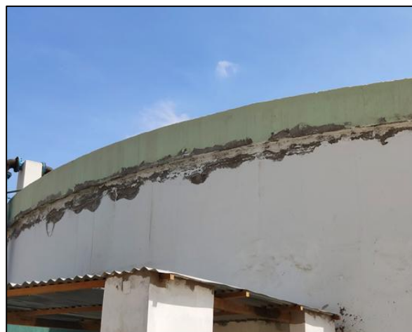
Fotografía 14. Presencia de humedad en la estructura de concreto armado. Fuente: Elaboración propia.
