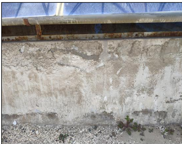
Fotografía 27. Presencia de desintegración en la estructura de concreto. Fuente: Elaboración propia.
