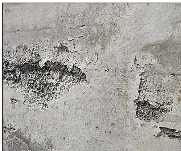
Fotografía 35. Presencia de eflorescencias en la estructura de concreto. Fuente: Elaboración propia.
