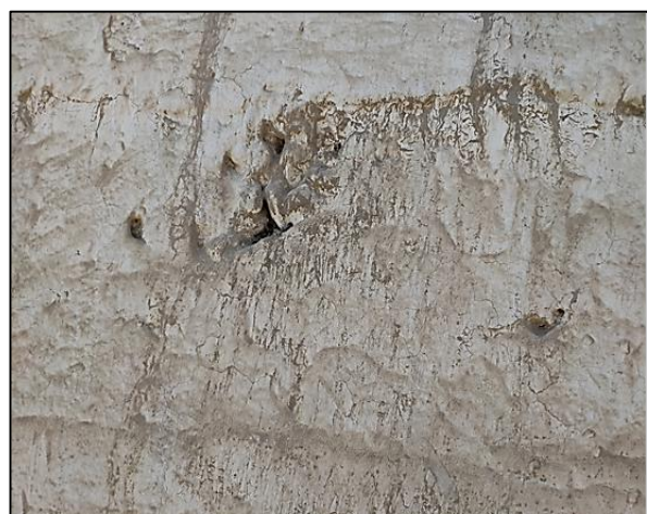
Fotografía 46. Presencia de deformaciones en la estructura de concreto. Fuente: Elaboración propia.
