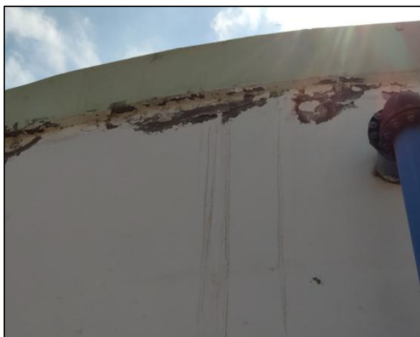
Fotografía 13. Presencia de humedad en la estructura de concreto. Fuente: Elaboración propia.
