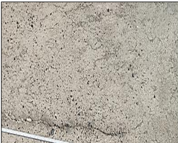
Fotografía 23. Presencia de fisuras en la estructura de concreto. Fuente: Elaboración propia.
