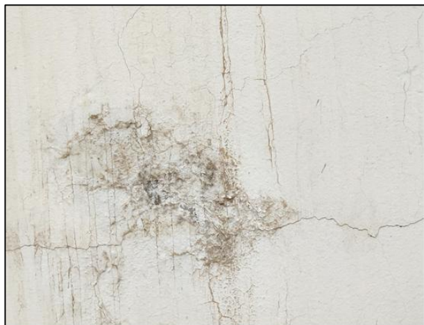
Fotografía 67. Presencia de humedad en la estructura de concreto. Fuente: Elaboración propia.
