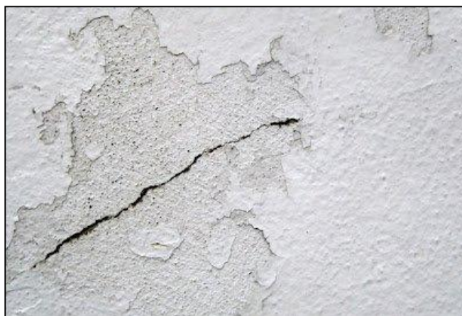
Figura 12. Fisura en estructura de concreto. Fuente: PAQSA (2018)
