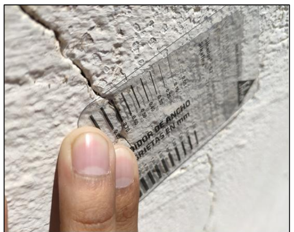
Fotografía 58. Presencia de fisuras en la estructura de concreto. Fuente: Elaboración propia.
