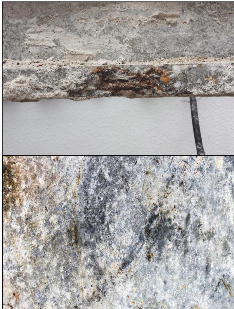
Figura 17. Presencia de oxidación en una estructura de concreto armado. Fuente: (Cemento Yura, 2018)
