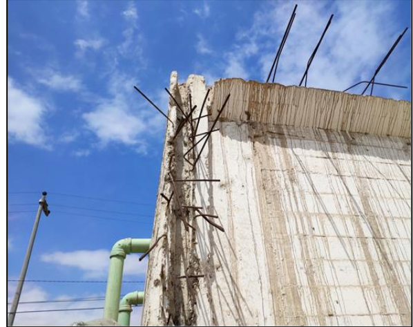
Fotografía 22. Presencia de deformaciones en la estructura de concreto. Fuente: Elaboración propia.
