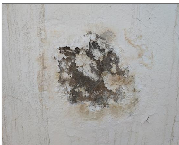
Fotografía 47. Presencia de eflorescencias en la estructura de concreto. Fuente: Elaboración propia.
