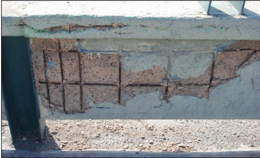
Figura 15. Desintegración del concreto por acciones químicas. Fuente: (Argos 360, 2019)
