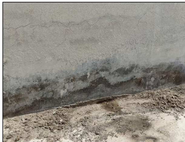
Fotografía 74. Presencia de humedad en la estructura de concreto armado. Fuente: Elaboración propia.
