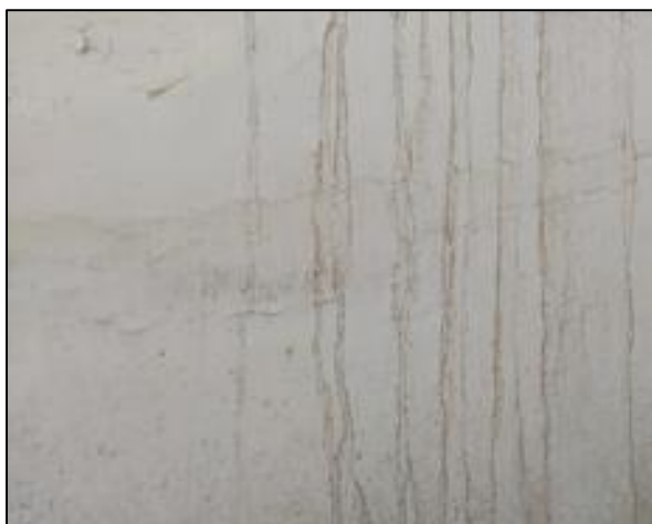
Fotografía 17. Presencia de suciedad en la estructura de concreto. Fuente: Elaboración propia.
