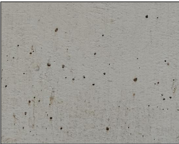
Fotografía 57. Presencia de picaduras en la estructura de concreto. Fuente: Elaboración propia.
