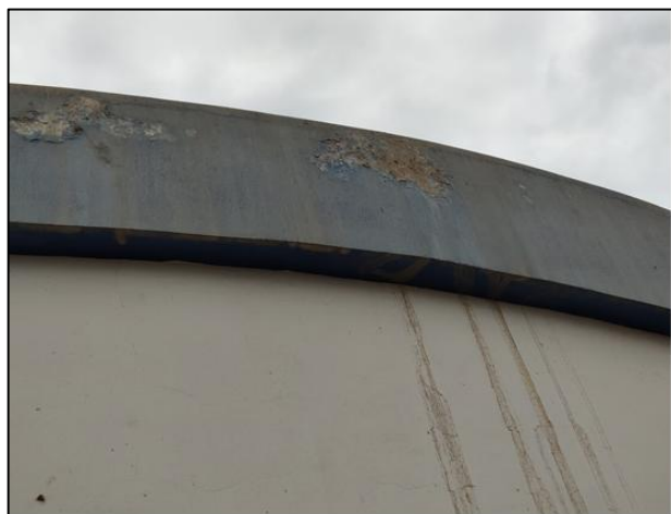
Fotografía 69. Presencia de suciedad en la estructura de concreto. Fuente: Elaboración propia.
