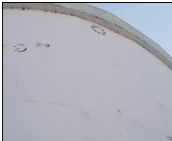
Fotografía 38. Presencia de humedad en la estructura plástica y en la de concreto. Fuente: Elaboración propia.
