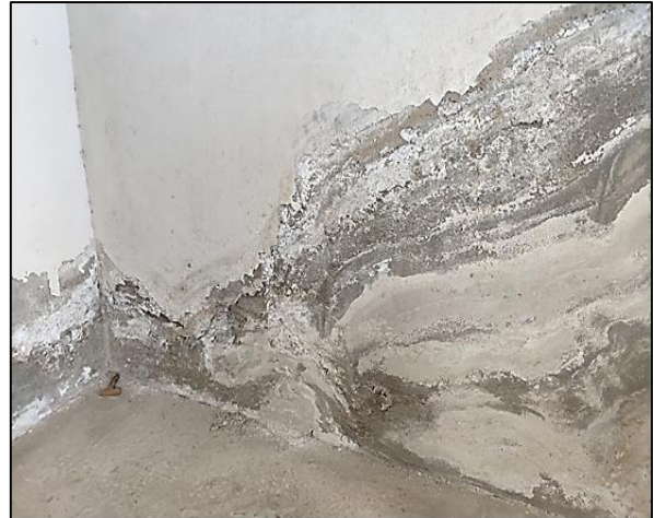
Fotografía 24. Presencia de humedad en la estructura de concreto. Fuente: Elaboración propia.
