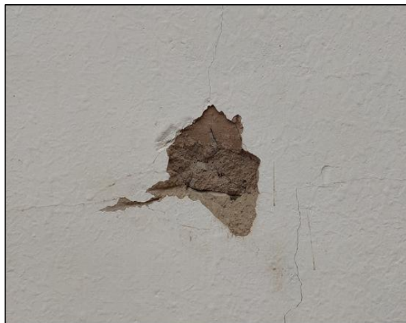
Fotografía 65. Presencia de desprendimientos en la estructura de concreto. Fuente: Elaboración propia.
