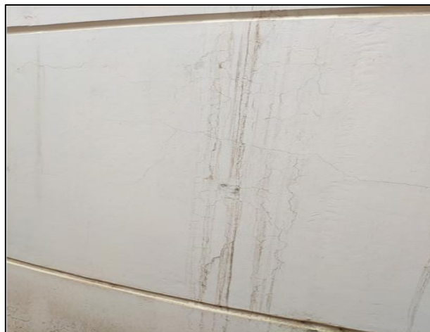
Fotografía 70. Presencia de suciedad en la estructura de concreto. Fuente: Elaboración propia.
