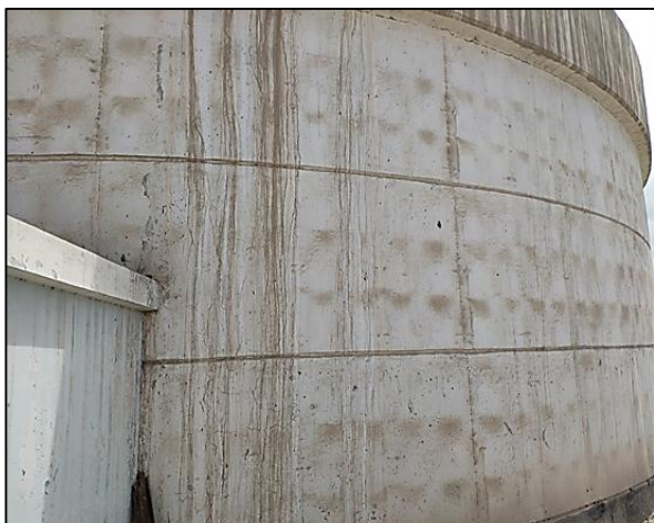
Fotografía 43. Presencia de suciedad en la estructura de concreto. Fuente: Elaboración propia.
