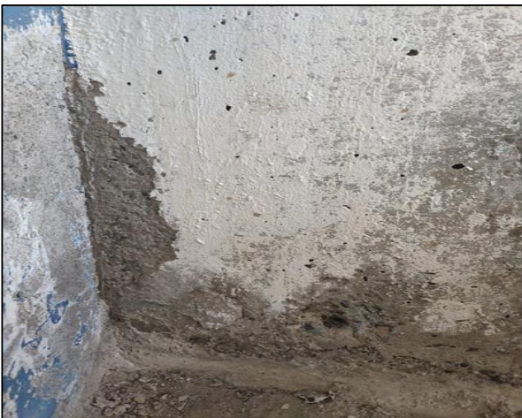
Fotografía 59. Presencia de desintegración en la estructura de concreto. Fuente: Elaboración propia.
