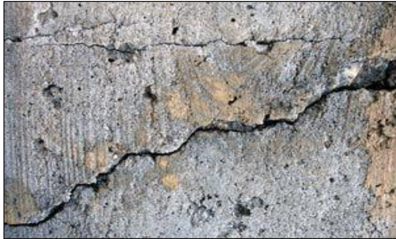
Figura 11. Formación de grietas en una estructura de concreto. Fuente: (Revista ARQHYS, 2012)
