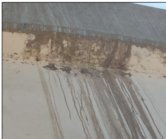
Fotografía 40. Presencia de suciedad en la estructura de concreto. Fuente: Elaboración propia.
