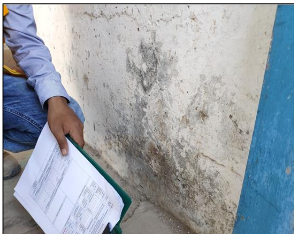
Fotografía 1. Presencia de humedad en la estructura de concreto. Fuente: Elaboración propia.
