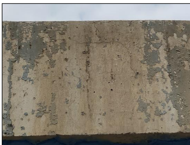
Fotografía 84. Presencia de fisuras en la estructura de concreto. Fuente: Elaboración propia.
