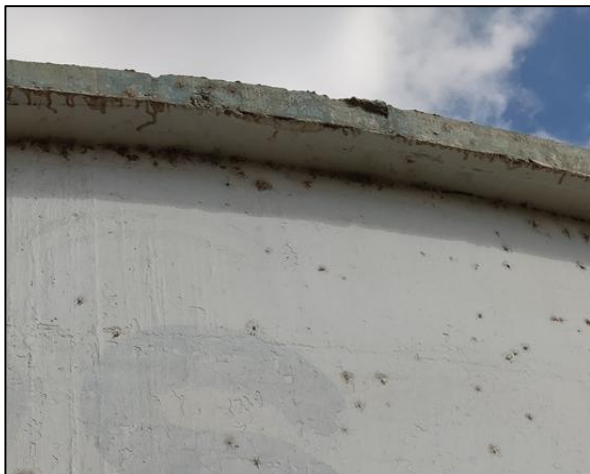
Fotografía 7. Presencia de desprendimientos en la estructura de concreto. Fuente: Elaboración propia.
