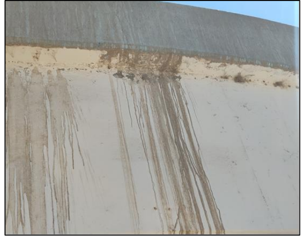
Fotografía 56. Presencia de suciedad en la estructura de concreto armado. Fuente: Elaboración propia.
