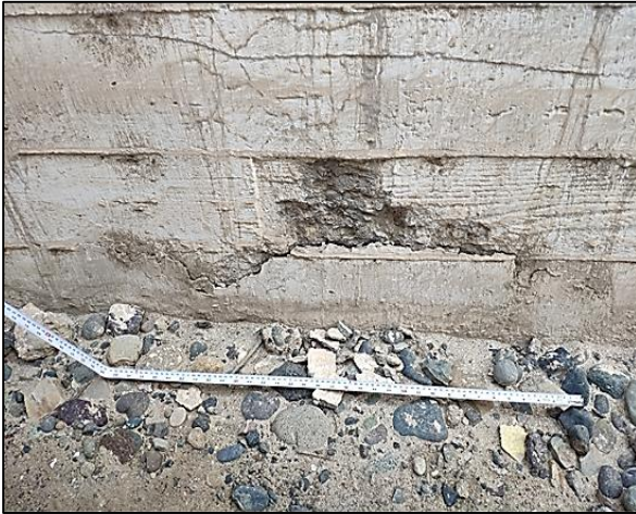
Fotografía 19. Presencia de desprendimientos en la estructura de concreto. Fuente: Elaboración propia.
