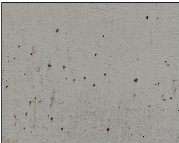
Fotografía 51. Presencia de picaduras en la estructura de concreto. Fuente: Elaboración propia.
