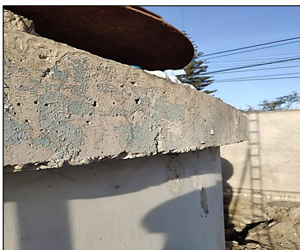
Fotografía 33. Presencia de picaduras en la estructura de concreto. Fuente: Elaboración propia.
