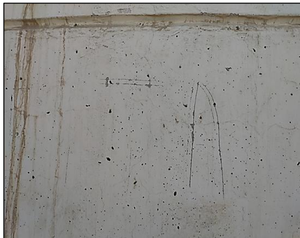
Fotografía 44. Presencia de picaduras en la estructura de concreto armado. Fuente: Elaboración propia.
