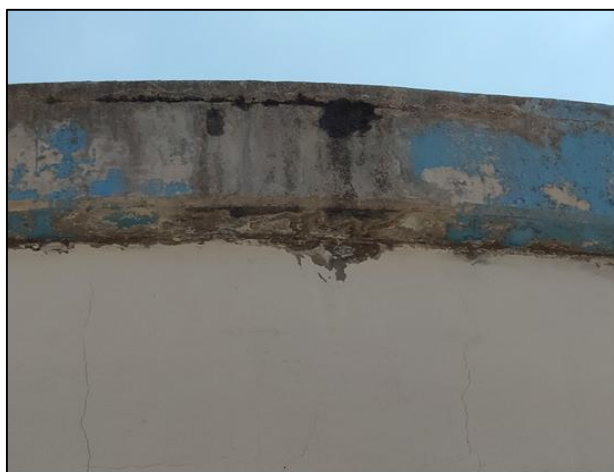
Fotografía 77. Presencia de eflorescencias en la estructura de concreto. Fuente: Elaboración propia.
