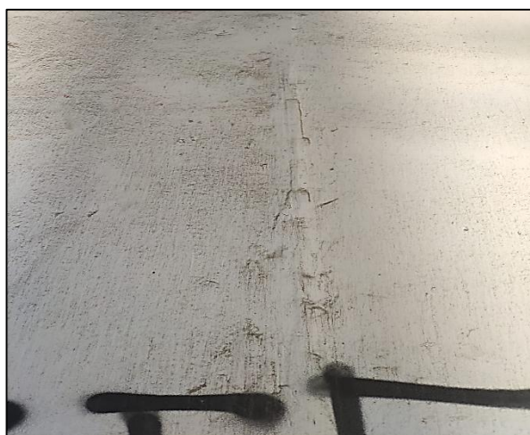
Fotografía 39. Presencia de suciedad en la estructura de concreto. Fuente: Elaboración propia.
