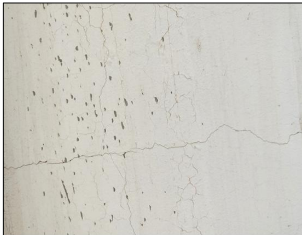
Fotografía 72. Presencia de fisuras en la estructura de concreto. Fuente: Elaboración propia.
