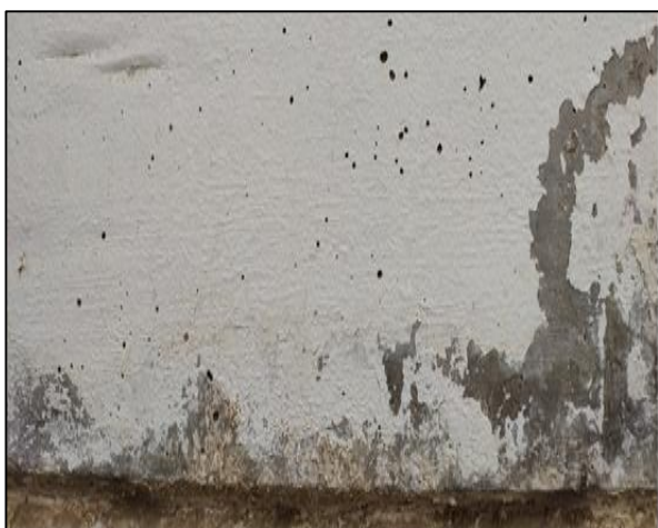
Fotografía 49. Presencia de humedad en la estructura de concreto. Fuente: Elaboración propia.
