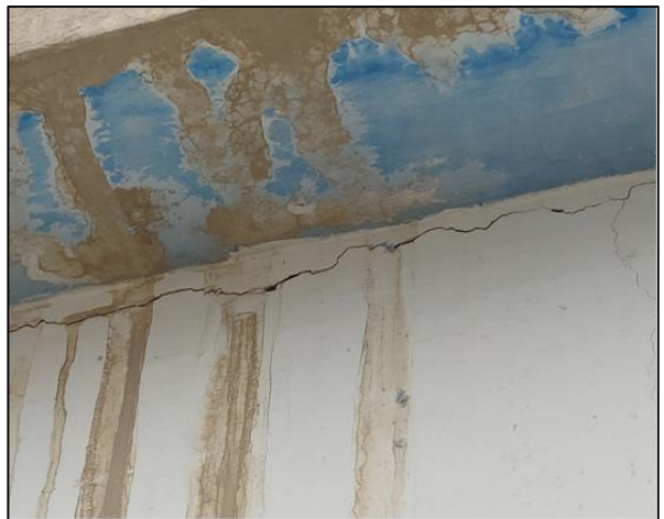
Fotografía 66. Presencia de fisuras en la estructura de concreto. Fuente: Elaboración propia.
