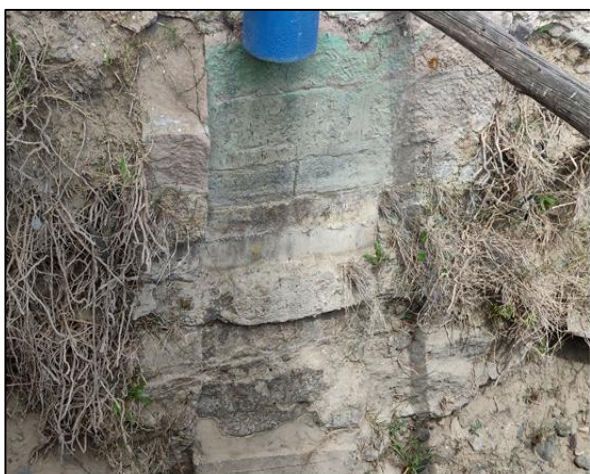
Fotografía 29. Presencia de fisuras en la estructura de concreto. Fuente: Elaboración propia.
