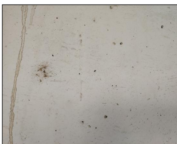
Fotografía 6. Presencia de suciedad en la estructura de concreto. Fuente: Elaboración propia.
