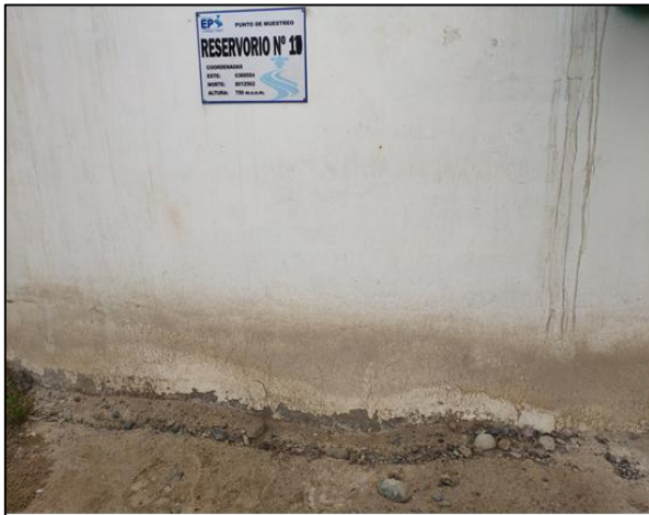
Fotografía 61. Presencia de humedad en la estructura de concreto. Fuente: Elaboración propia.
