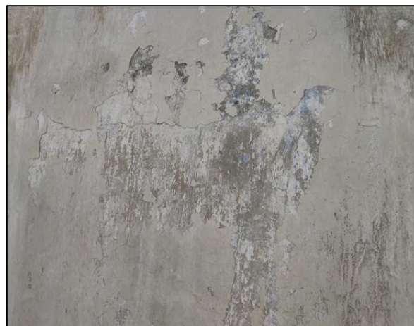
Fotografía 28. Presencia de humedad en la estructura de concreto. Fuente: Elaboración propia.
