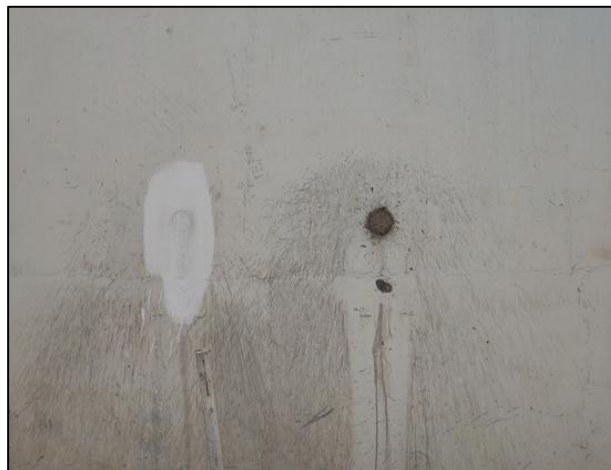
Fotografía 80. Presencia de suciedad en la estructura de concreto armado. Fuente: Elaboración propia.
