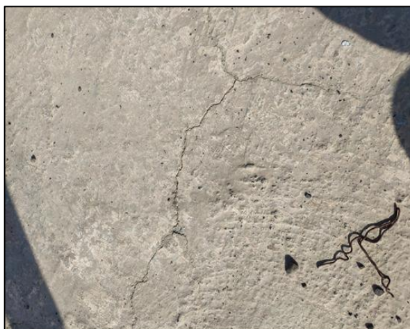
Fotografía 52. Presencia de fisuras en la estructura de concreto. Fuente: Elaboración propia.
