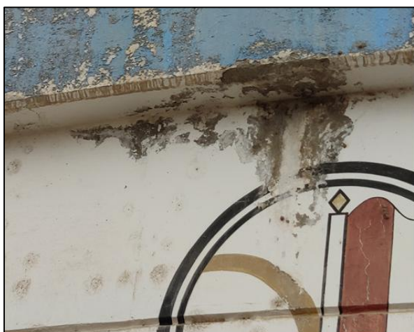
Fotografía 53. Presencia de desprendimientos en la estructura de concreto. Fuente: Elaboración propia.
