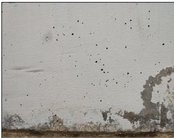
Fotografía 63. Presencia de picaduras en la estructura de concreto. Fuente: Elaboración propia.
