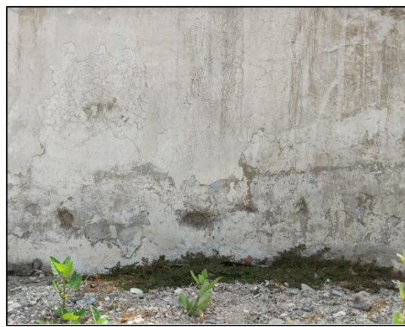
Fotografía 30. Presencia de humedad en la estructura de concreto. Fuente: Elaboración propia.
