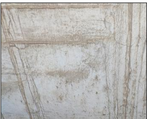
Fotografía 18. Presencia de suciedad en la estructura de concreto. Fuente: Elaboración propia.
