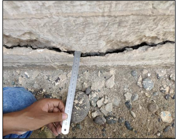
Fotografía 20. Presencia de grieta en la estructura de concreto armado. Fuente: Elaboración propia.
