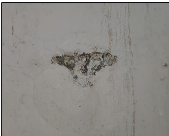
Fotografía 15. Presencia de deformaciones en la estructura de concreto. Fuente: Elaboración propia.
