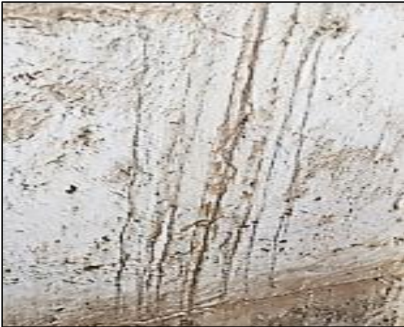
Fotografía 21. Presencia de deformaciones en la estructura de concreto. Fuente: Elaboración propia.
