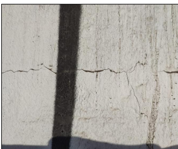
Fotografía 42. Presencia de fisuras en la estructura de concreto. Fuente: Elaboración propia.
