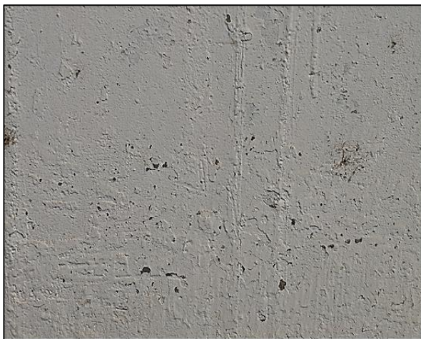
Fotografía 9. Presencia de picaduras en la estructura de concreto. Fuente: Elaboración propia.
