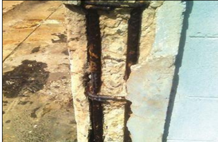
Figura 18. Exposición del acero por acción de la corrosión en una estructura de concreto armado. Fuente: (Carrillo, 2017)
