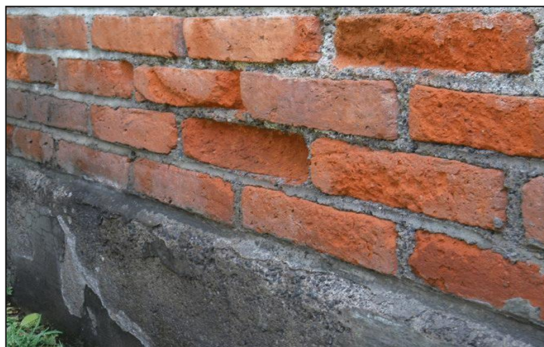
Figura 14. Presencia de disgregamiento en una estructura de ladrillos. Fuente: (Pérez N. A., 2015)
