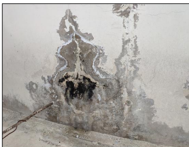
Fotografía 78. Presencia de eflorescencias en la estructura de concreto. Fuente: Elaboración propia.
