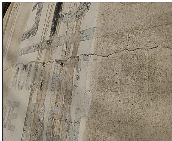
Fotografía 32. Presencia de suciedad en la estructura de concreto. Fuente: Elaboración propia.
