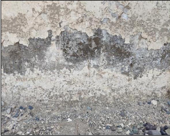
Fotografía 55. Presencia de humedad en la estructura de concreto. Fuente: Elaboración propia.
