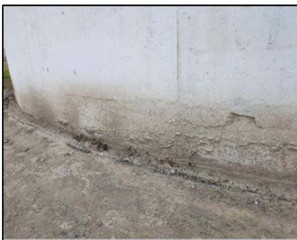
Fotografía 16. Presencia de deformaciones en la estructura de concreto. Fuente: Elaboración propia.
