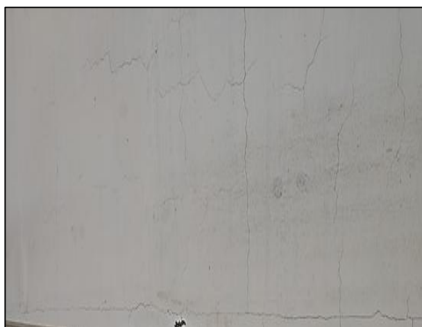
Fotografía 76. Presencia de fisuras en la estructura de concreto. Fuente: Elaboración propia.
