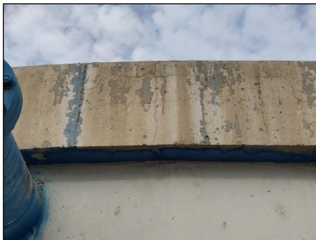
Fotografía 79. Presencia de humedad en la estructura de concreto. Fuente: Elaboración propia.
