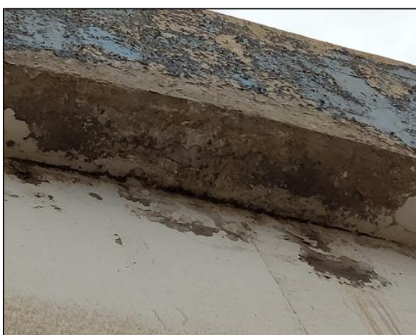
Fotografía 54. Presencia de eflorescencias en la estructura de concreto. Fuente: Elaboración propia.
