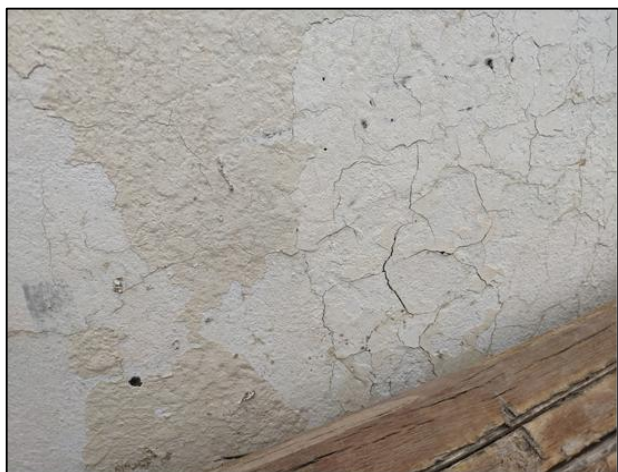
Fotografía 81. Presencia de picaduras en la estructura de concreto. Fuente: Elaboración propia.
