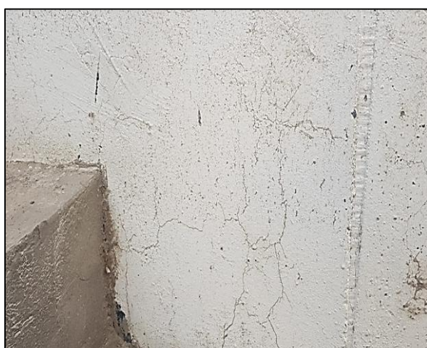
Fotografía 41. Presencia de fisuras en la estructura de concreto. Fuente: Elaboración propia.
