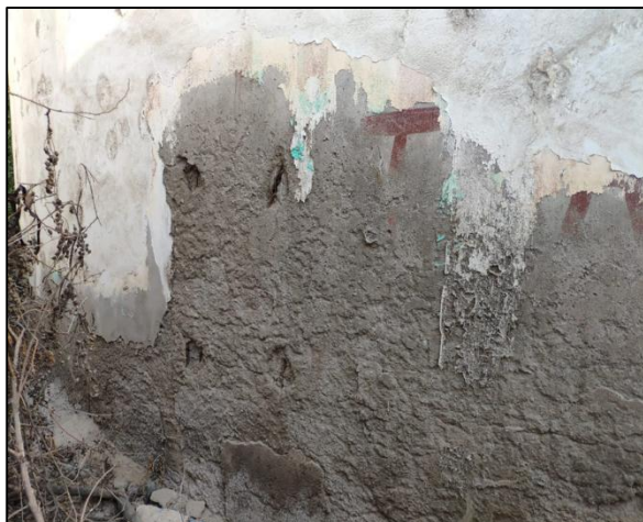
Fotografía 31. Presencia de humedad en la estructura de concreto. Fuente: Elaboración propia.
