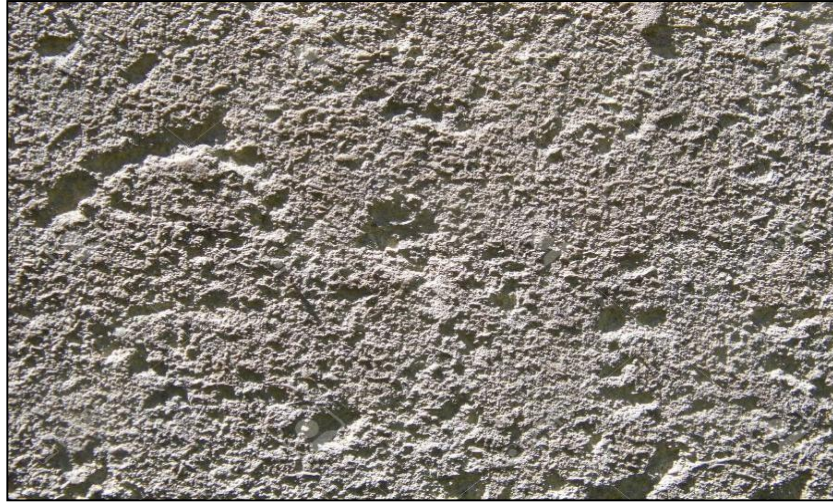
Figura 8. Estructura de concreto con presencia de picaduras. Fuente: (Broto & Soria, 2006)
