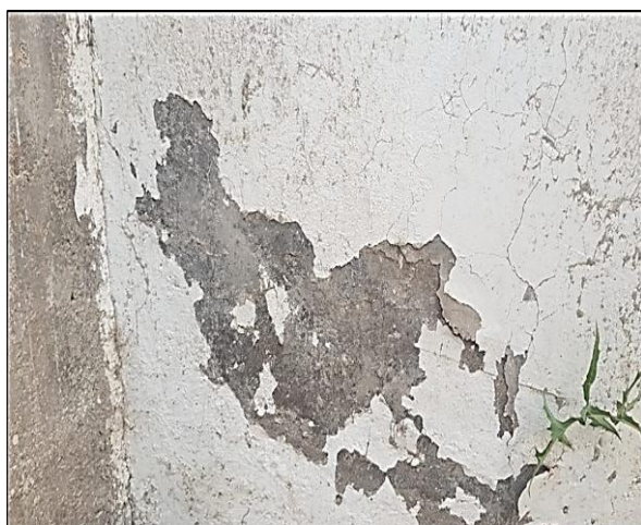
Fotografía 37. Presencia de humedad en la estructura plástica y en la de concreto. Fuente: Elaboración propia.
