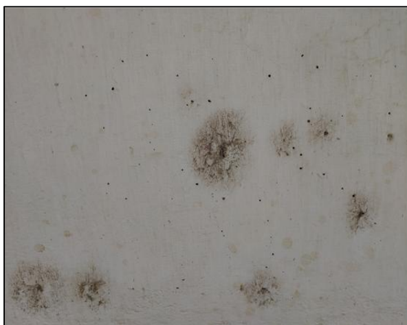
Fotografía 3. Presencia de picaduras en la estructura de concreto. Fuente: Elaboración propia.
