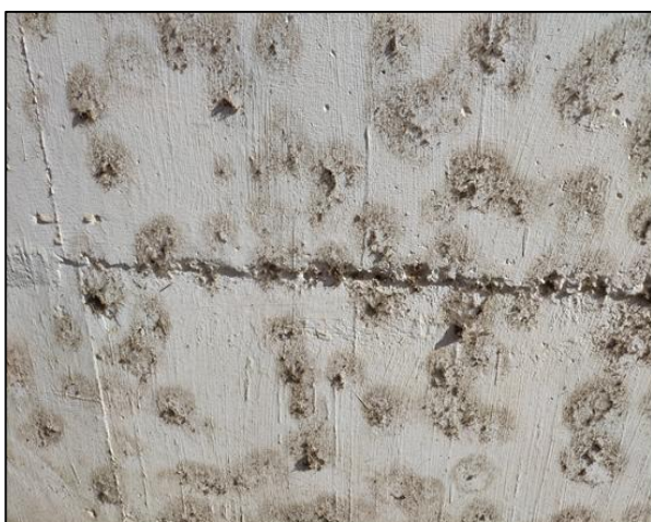
Fotografía 5. Presencia de deformaciones en la estructura de concreto. Fuente: Elaboración propia.
