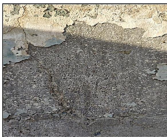
Fotografía 34. Presencia de fisuras en la estructura de concreto. Fuente: Elaboración propia.
