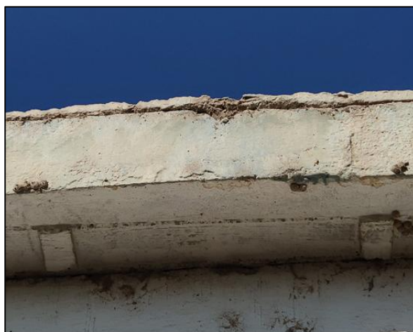
Fotografía 4. Presencia de desprendimientos en la estructura de concreto. Fuente: Elaboración propia.
