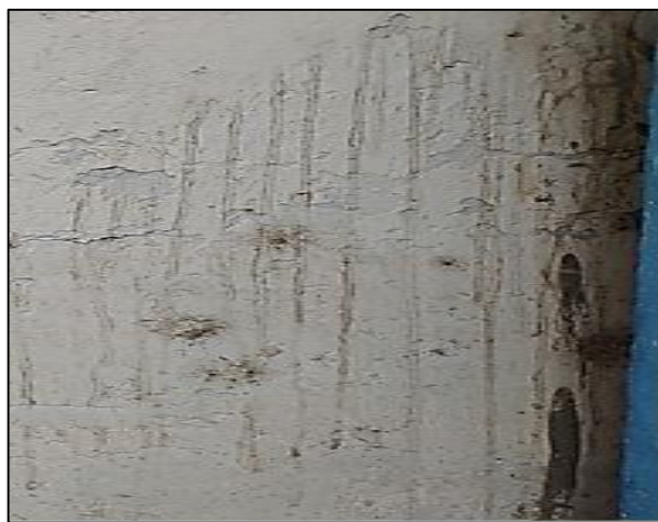
Fotografía 12. Presencia de suciedad en la estructura de concreto. Fuente: Elaboración propia.
