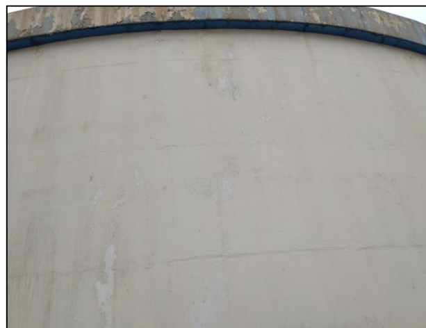
Fotografía 82. Presencia de suciedad en la estructura de concreto. Fuente: Elaboración propia.
