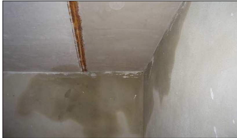
Figura 5. Presencia de humedad en una estructura de concreto. Fuente: (Martínez, 2013)
