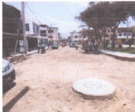
Fotografías 30, 31 y 32: tránsito vehicular en calles que están en la zona de trabajo
