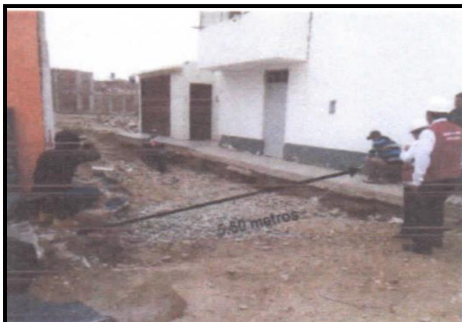
Figura 11: Viviendas que ocupan espacios de la vereda y parte de la pista
