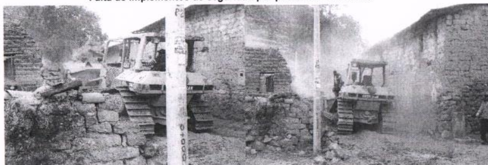
Imagen n.º 01 Falta de implementos de seguridad por parte del Contratista
