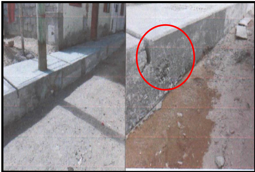
Figura 7: Cangrejeras en veredas de concreto y juntas no llegan a la base
