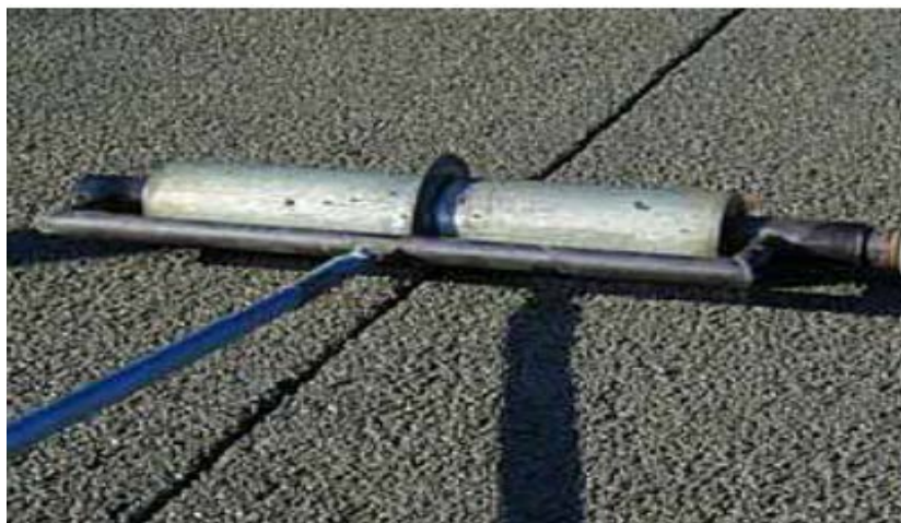
FIGURA N°13: Construcción de una junta mediante la adaptación de una hoja en el rodillo de compactación.
