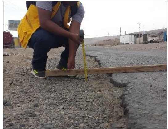
Fotografía 10: Escalonamiento entre calzada y berma.
