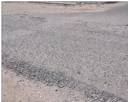
Fotografía 02: Pérdida de agregados.
