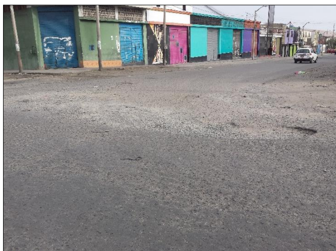
Fotografía 20: Se observa pérdida de agregados y un gran bache en la intersección con una calle – Tramo N°02.
