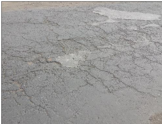
Fotografía 15: Piel de cocodrilo – Severidad media.
