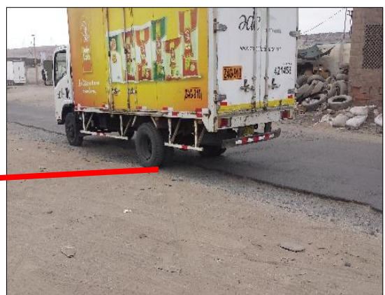
Fotografía 12: El auto transita por la berma, provocando la grieta de borde y desnivel de carril y berma.
