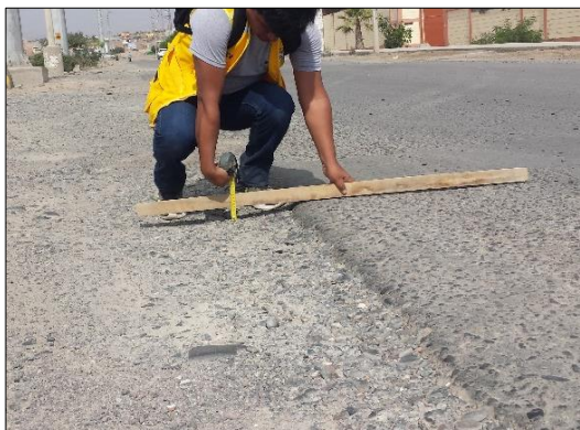
Fotografía 03: Escalonamiento entre calzada y berma.
