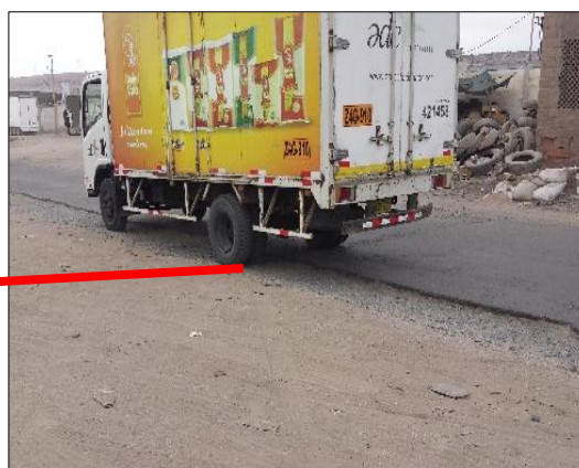
El auto transita por la berma, provocando la fisura de borde y escalonamiento entre calzada y berma (desnivel de carril y berma).
