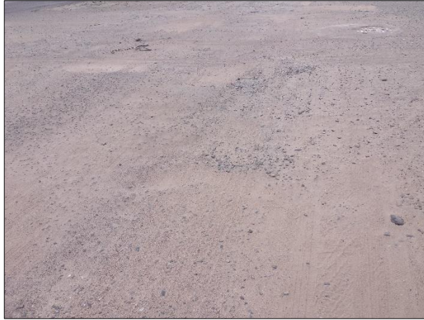
Figura 61. Perdida de agregados, expandiendo la base del pavimento.
