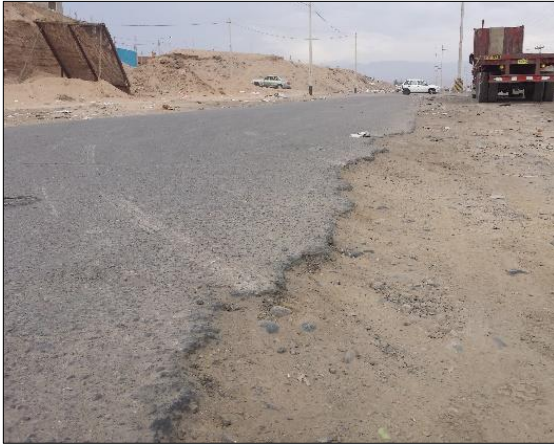
Fotografía 13: Fisura de borde – Severidad alta.
