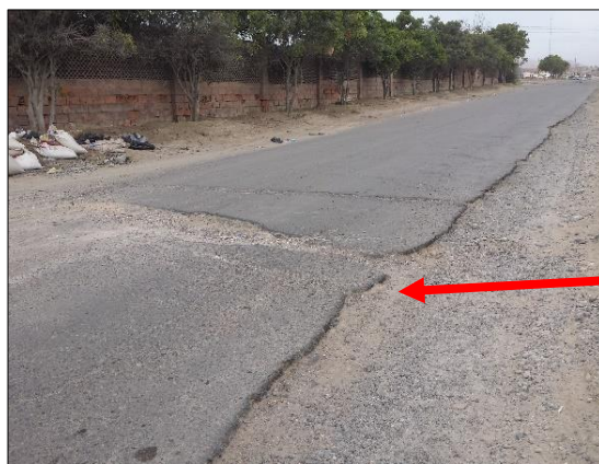
Autos evitan parcheo en mal estado.
