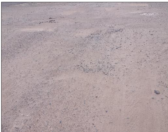
Fotografía 17: Pérdida de agregado y baches – Severidad alta.
