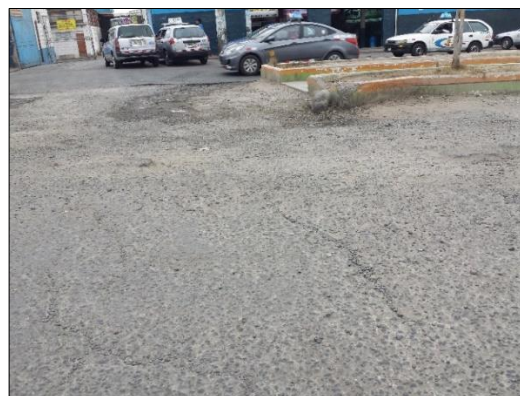
Fotografías 22: pérdida de agregados, depresión longitudinal y pérdida de agregados.
