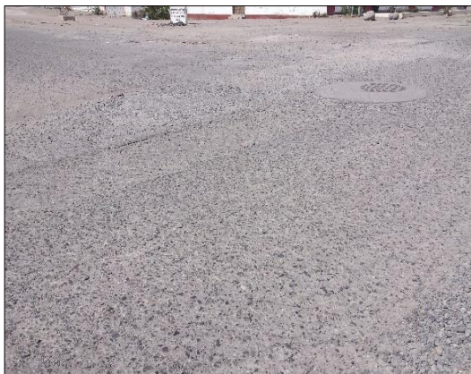
Fotografía 01: Parcheo y pérdida de agregados.
