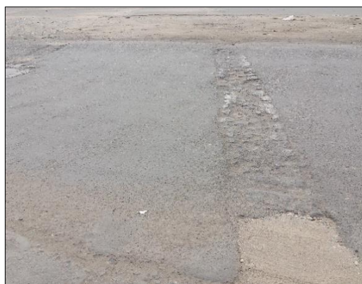
Fotografía 06: Parcheo – Severidad alta.
