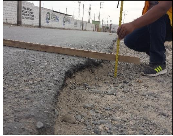
Fotografía 14: Escalonamiento entre calzada y berma, además fisura de borde.
