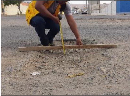
Fotografía 07: Huecos se severidad alta.
