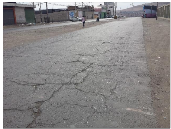
Fotografía 16: Figuración de contracción termina – Severidad media.
