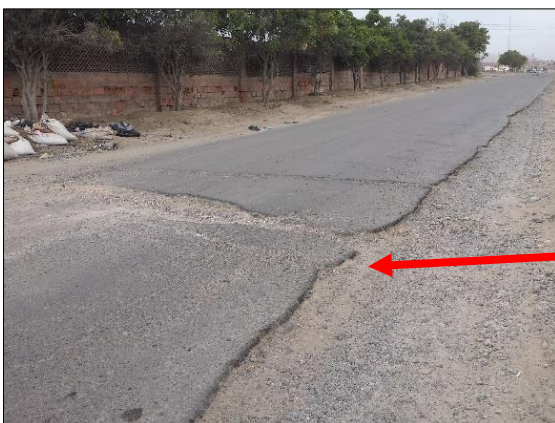
Fotografía 11: Autos evitan parcheo de severidad alta.
