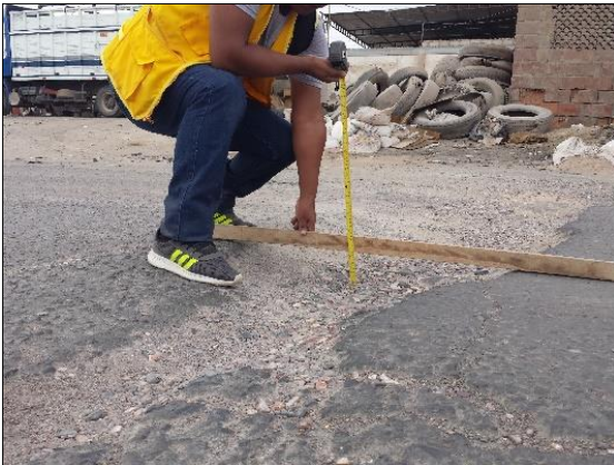
Fotografía 09: Parcheo de severidad alta.
