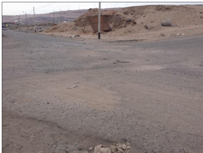
Fotografía 19: Se observa en la mayoría de las intersecciones, el estado del pavimento se encuentra en muy mal estado. – Tramo
