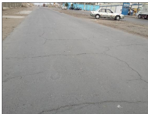
Fotografía 21: Fisuras longitudinales por fatiga – Tramo N°01
