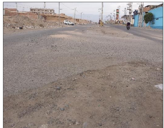
Fotografía 18: Pérdida de agregados en intersección de vías.
