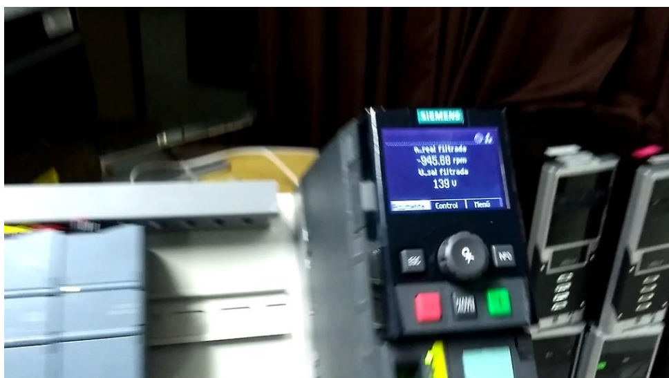
Figura 80: Visualización del funcionamiento del motor trifásico en sentido contrario, accionado por el interruptor de inversión (entrada) (Fuente: Propia)
