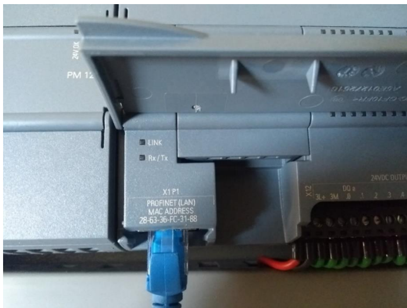
Figura 68: Puerto Profinet (LAN) del PLC SIEMENS S7 1200 - CPU 1214C (Fuente: Propia)
