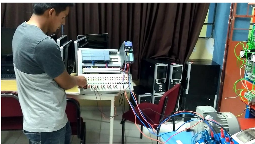
Figura 78: Puesta en Marcha del Motor Trifásico con la activación de los interruptores de entrada (Fuente: Propia)
