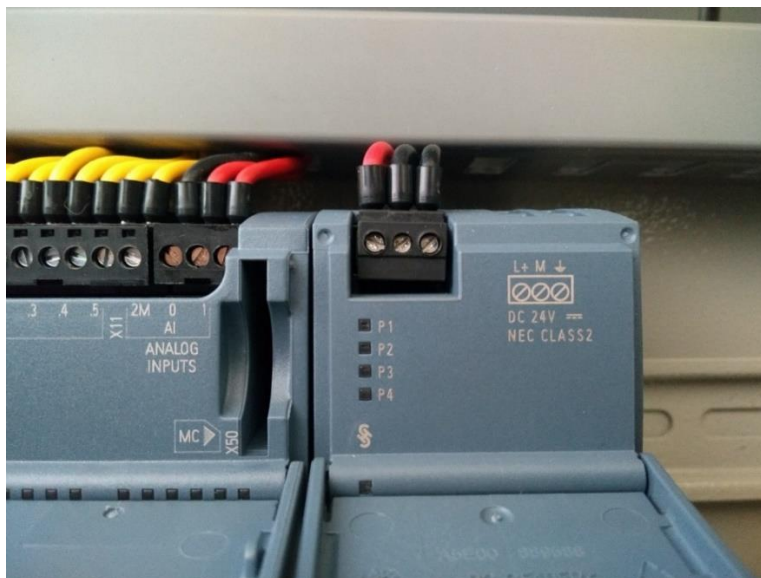
Figura 65: Entradas de Alimentación del Switch CSM1277 (Fuente: Propia)
