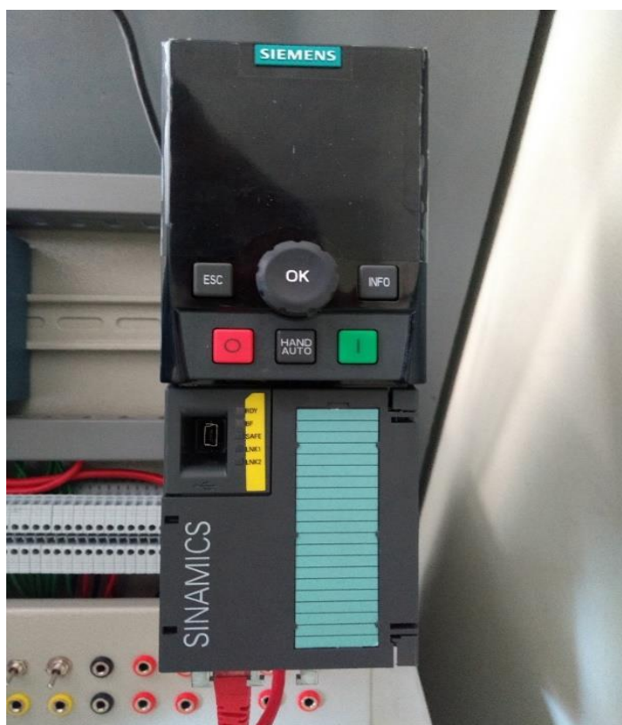
Figura 67: Variador de Velocidad SIEMENS G120 colocado en el Módulo de Entrenamiento (Fuente: Propia)
