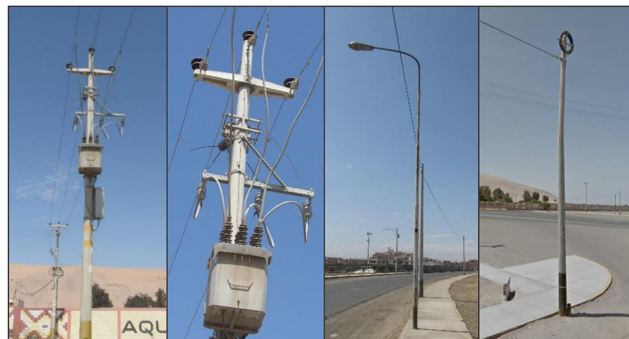
Figura 84: Postes de red de Energía Eléctrica y Telefonía Fuente: Elaboración Propia
