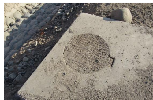
Figura 81: Buzón de red de alcantarillado - Av. Tarapacá Fuente: Elaboración Propia
