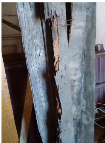
Imagen N°10: Se observa la presencia de polilla que afecta gravemente a la madera.
