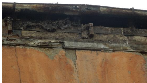
Figura 71. Vigas en mal estado de 2do
