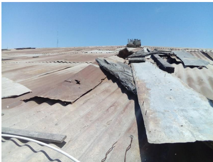
Imagen N°05: Se aprecia la cobertura deteriorada por efectos del intemperismo (Lluvia, sol y viento)
