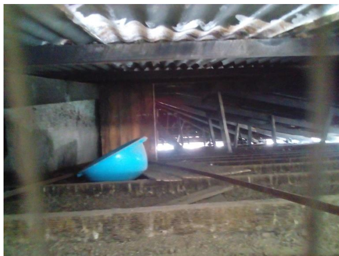
Imagen N°04: Se aprecia las estructuras de madera bastante deterioradas y la cobertura de calamina en su mayoría con presencia de óxido.
