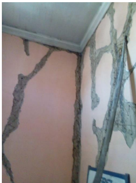
Imagen N°03: Fisuras en las paredes producto del sismo
