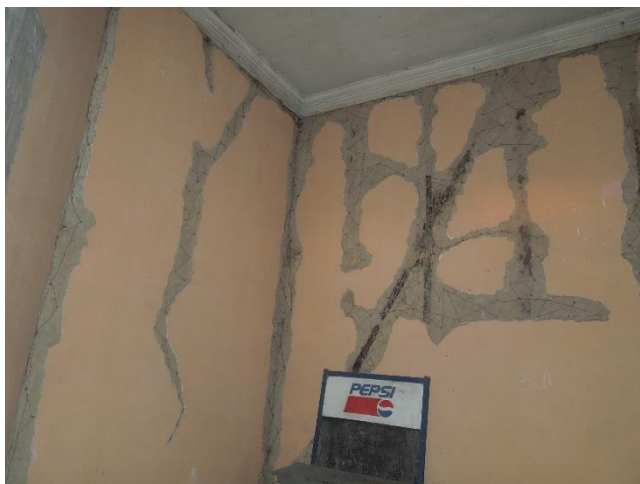
Imagen N°01: Fisuras en las paredes producto del sismo
