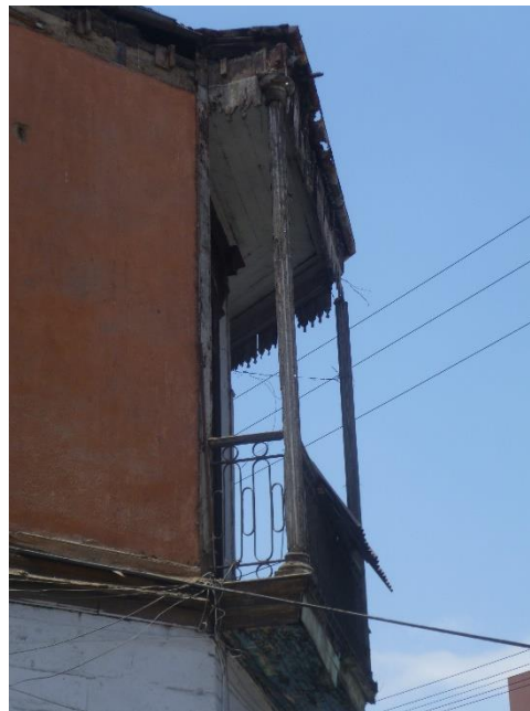
Imagen N°08: Se evidencia el alero donde sus columnas y vigas no cumplen sus funciones estructurales
