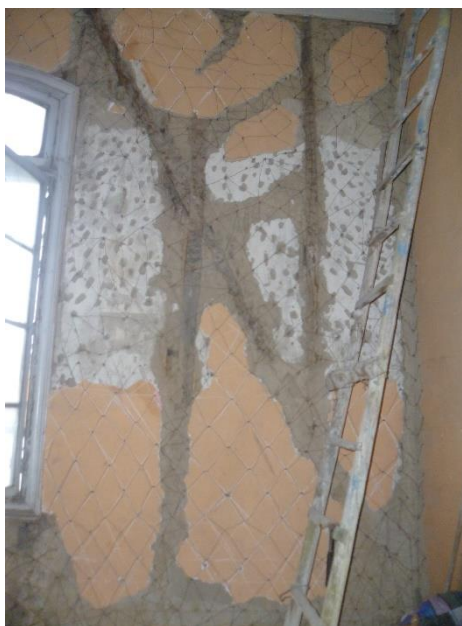
Imagen N°02: Fisuras en las paredes producto del sismo
