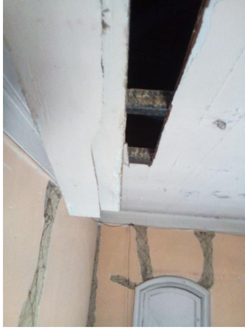
Imagen N°07: El cielorraso se encuentra muy deteriorado y se evidencia la presencia de palomas.
