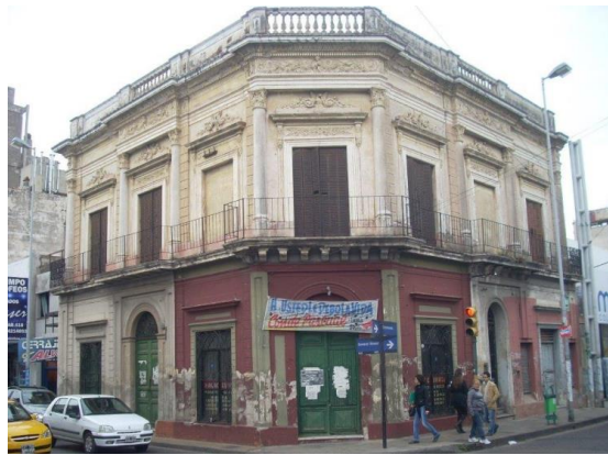
Figura 67. Fachada deteriorada de la Casa Italianizante Fuente: Archdaily
