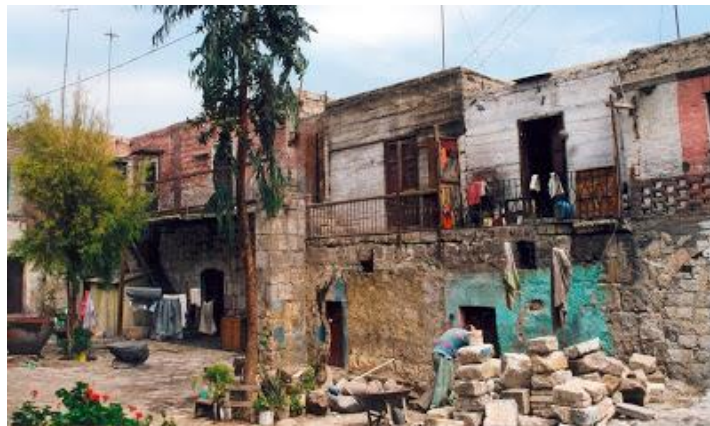
Figura 16. Fotografía del Patio Principal de “La Cabezona” antes de la intervención. Fuente: http://moleskinearquitectonico.blogspot.pe
