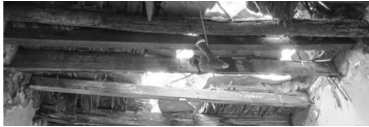
Figura 4. Techo a extraer, por el estado grave en el que se encontraba. Fuente: Archdaily
